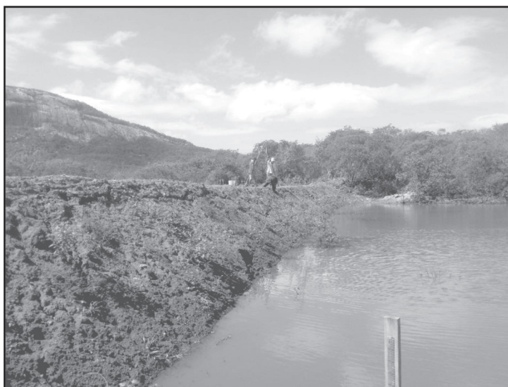
Figura 13 – Rachaduras no talude provocada pelo colapso
