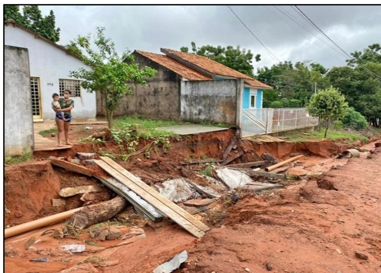
Figura 2 – Obras da Prefeitura danificadas na Avenida das Perdizes no Parque Universitário.
