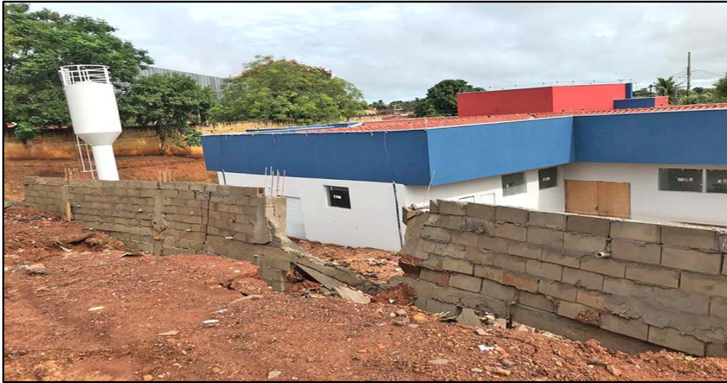
Figura 3 – Muro do poste de saúde Residencial Marechal Rondon destruído com a força da água.
