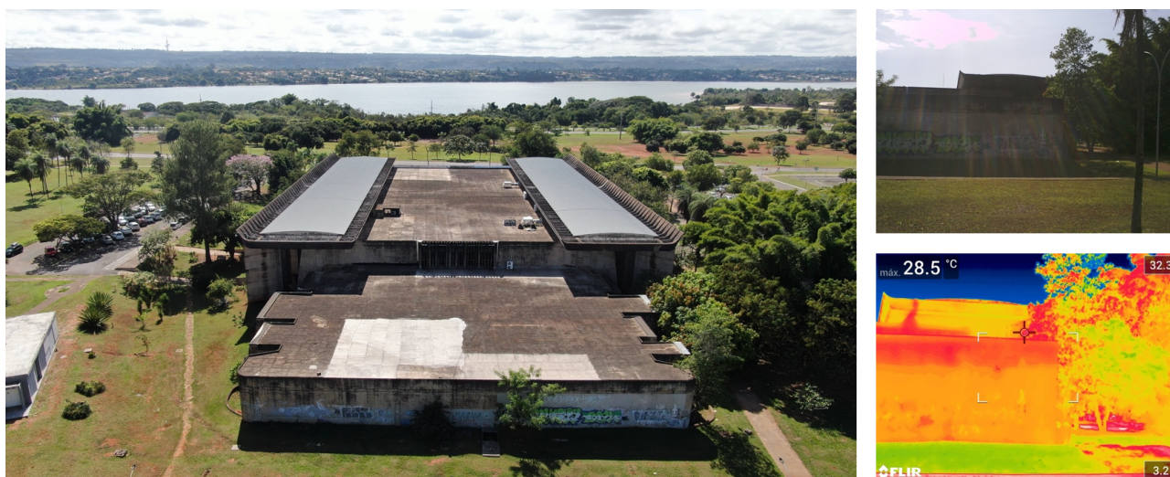
Figura 9 . Análise de infiltrações e ações de chuva dirigida na fachada oeste da BCE. Fonte: LabRAC
