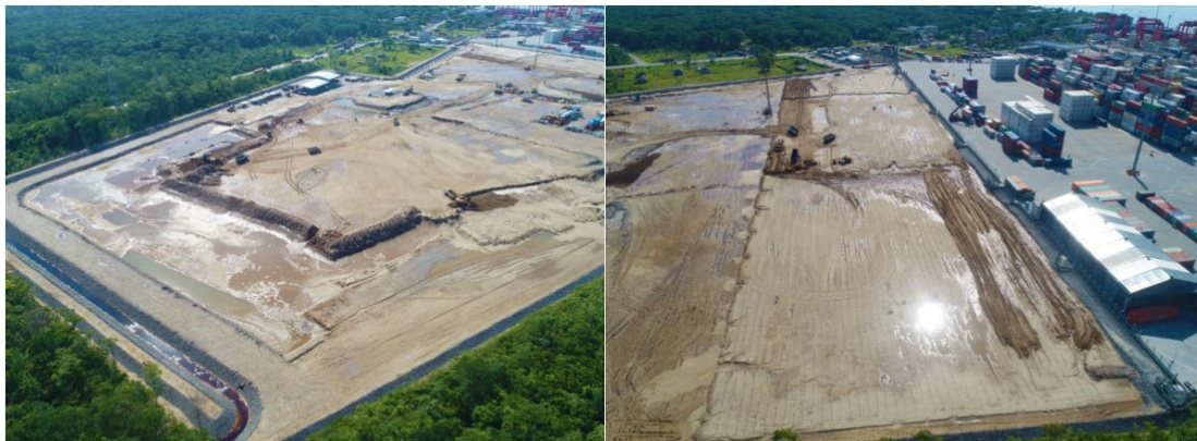
Figura 2 – Vista aérea da área de expansão do porto durante a movimentação do aterro de sobrecarga.
