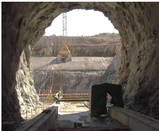
Figura 1. Tunel de adução da Central de Alqueva
