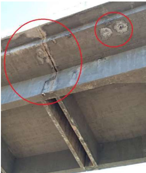
Figura 11. Infiltração no tabuleiro.
