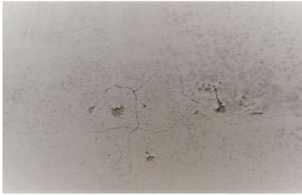
Figura 6. Fissura mapeada em argamassa de revestimento na fachada lateral direita do imóvel.
