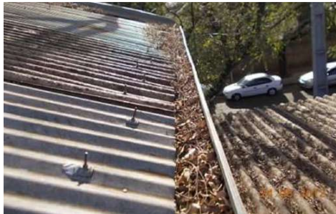
Figura 4. Acúmulo de detritos em cobertura. Fonte: Habitissimo, 2021.
