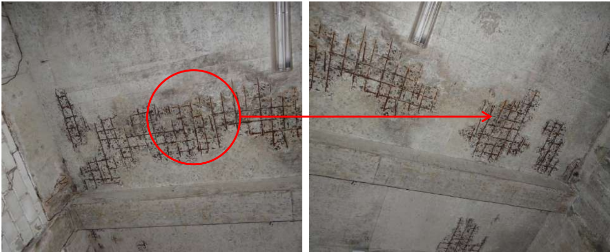
Figura 14 – Detalhe da corrosão da laje (trecho 2) e detalhe da corrosão da laje.
