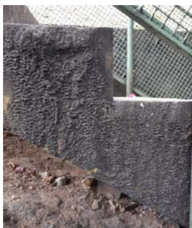
Figura 22: Manchas em estado avançado (Fi = 3).
