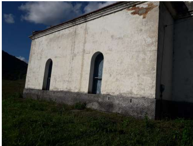
Figura 3. Manifestações patológicas verificadas na fachada oeste. Fonte: (Lessa, 2021).
