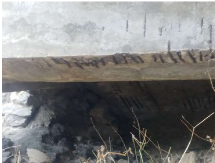
Figura 6. Corrosão na armadura na viga transversal e na laje (tabuleiro da ponte nova). Fonte: própria, 2019.
