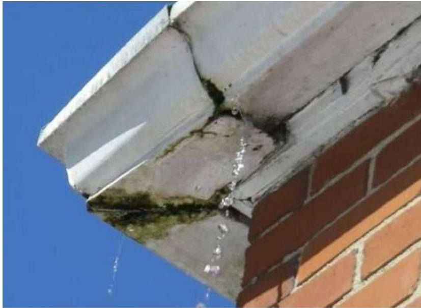
Figura 4. Calha com vazamento em frestas devido a soldas e emendas danificadas, apresentando goteiras e mofo (Tebaldi, 2015).
