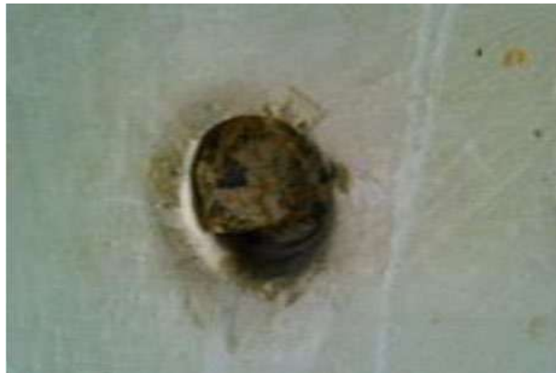
Figura 11. Ponto da estrutura indicando carbonatação do concreto.
