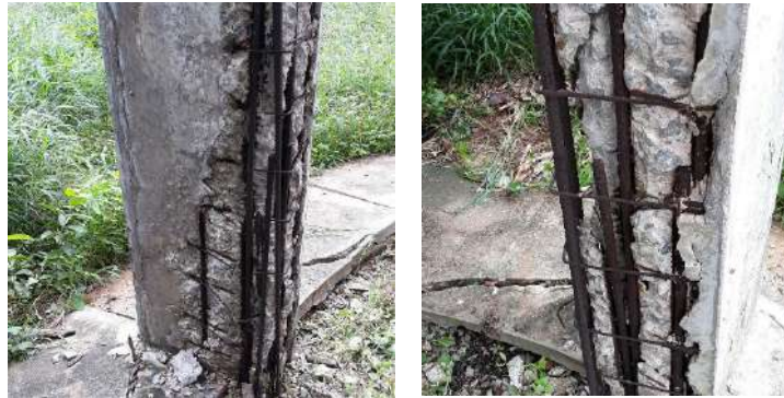
Figura 7. Pilar em estado de ruína em REL.
