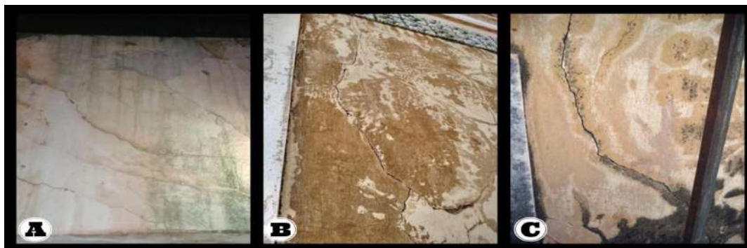
Figura 8. Fissuras, trincas e rachaduras em: (A) Alvenaria interna e (B) e (C) Alvenaria da fachada (Autor, 2021).
