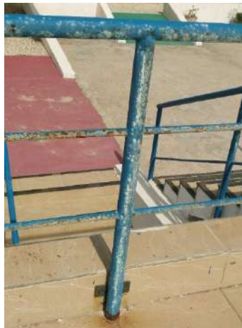
Figura 3. Grade de proteção que fica em frente à Igreja de Santa Edwirges com muitos pontos de corrosão por pites. Fonte: própria, 2019.
