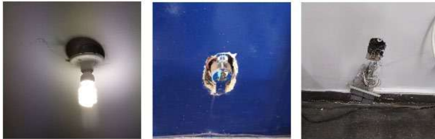
Figura 18. Problemas nas instalações elétricas por soluções insuficientes
