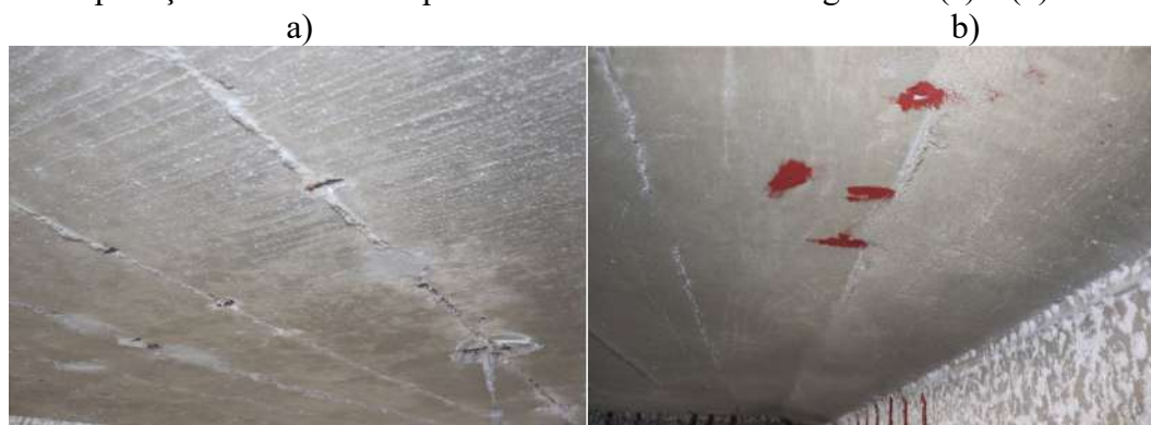
Figura 14. a) Corrosão nas armaduras da laje b) Tratamento aplicado à armadura da laje
