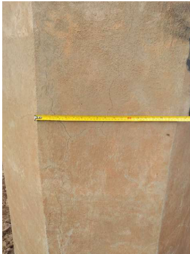
Figura 15. Fissuras em pilares da mesoestrutura.
