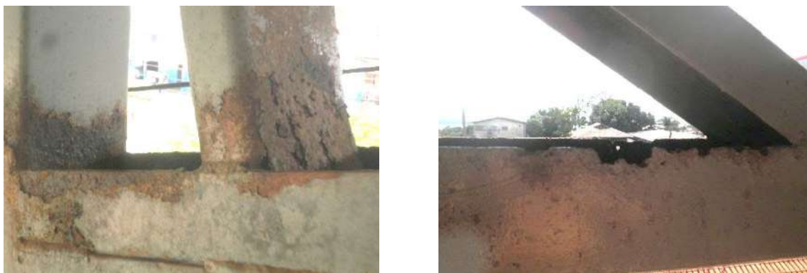
Figura 3.18. Aço em expansão na treliça e perda de perfil.
