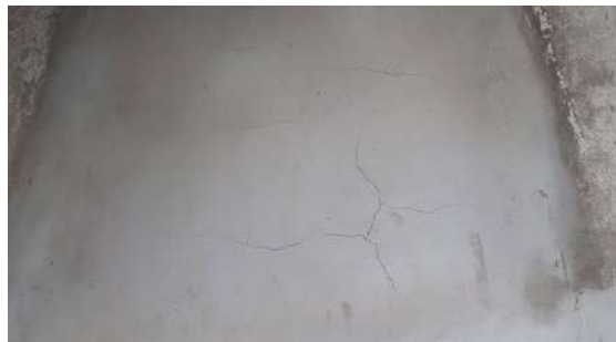
Figura 4. Fissuras mapeadas na argamassa na parede externa do bloco F.
