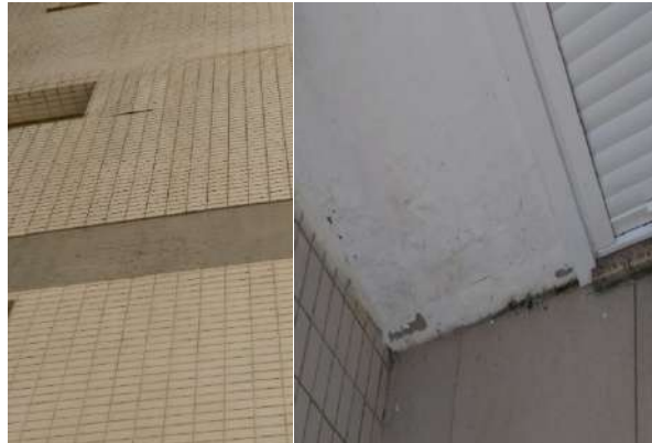
Figura 7. (a) Danos de fixação de peças cerâmicas; (b) Danos no revestimento causados pela umidade ascensional.
