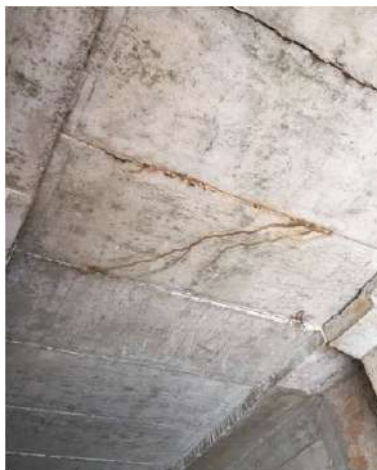
Figura 7. Carbonatação no tabuleiro. Fonte: Costa (2016, p.42)
