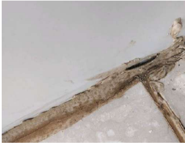
Figura 9: Falha na vedação das placas de ACM
