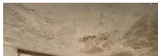
Figura 8: Mofo/ bolor no teto e parede
