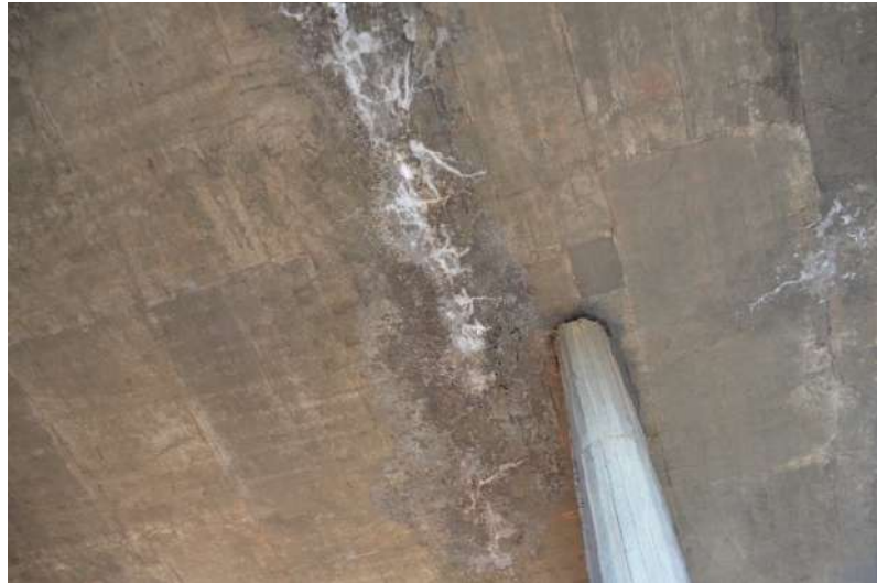
Figura 6 – Elemento tabuleiro com eflorescência
