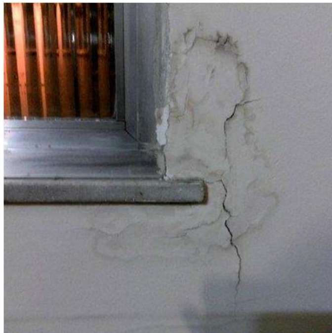
Figura 6. Trincas no peitoril da janela permitindo a infiltração de água na parede interior da edificação (PFLIMPEZA, 2016).
