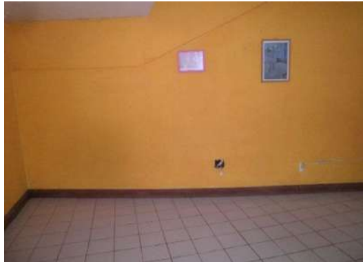
Figura 3.9. Fissuras na parede da sala de balé.
