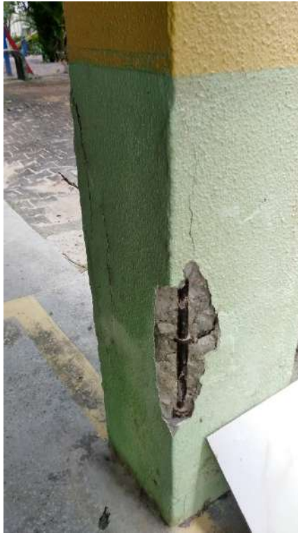
Figura 7. Corrosão na armadura em um pilar de concreto armado. Fonte: própria, 2019.
