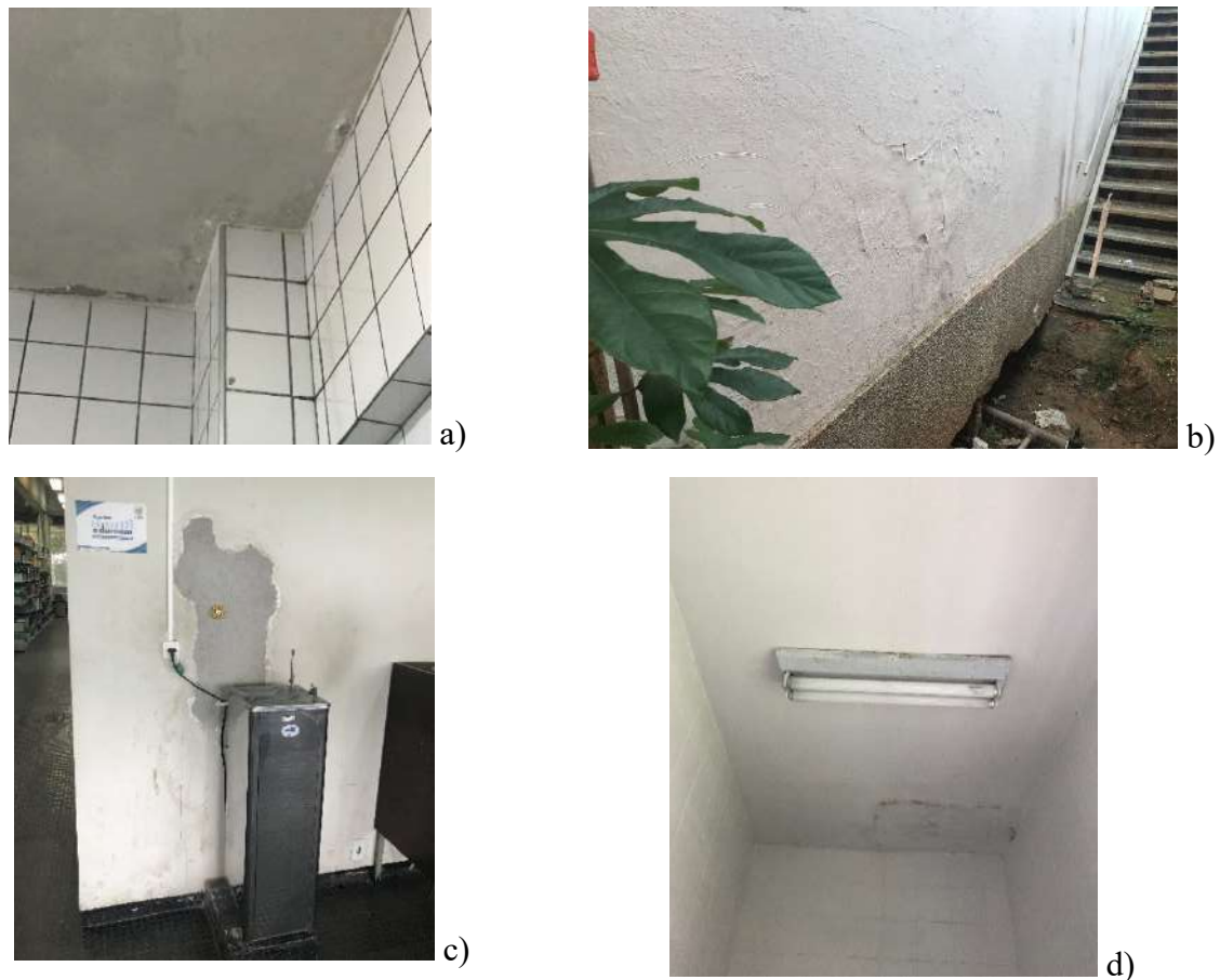
Figura 9 – Principais manifestações patológicas nas edificações da UFES (infiltração), em 2021.
