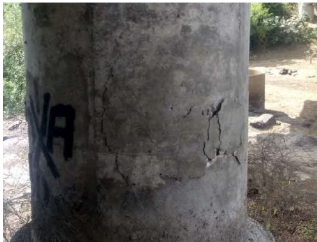
Figura 5. Destacamento do cobrimento do pilar. Fonte: própria, 2019.
