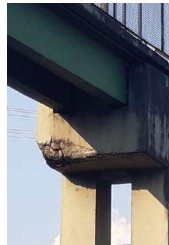
Figura 4: Desagregação (Fi = 3). Manchas e sujidade (Fi = 2).
