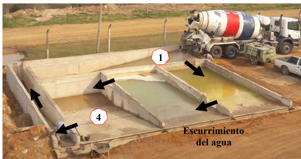
Figura 4. Sistema de piletas de sedimentación y decantación de sólidos de agua de lavado de camiones mixers.
