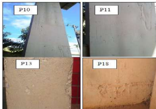
Figura 3.14. Pilares com imperfeições.
