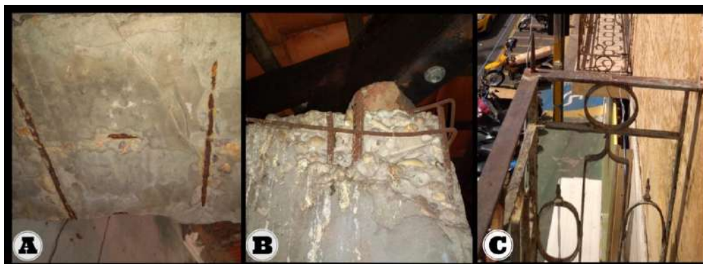
Figura 5. Corrosão em: (A) Piso da escada e (B) Pilar e (C) Guarda-corpo (Autor, 2021).
