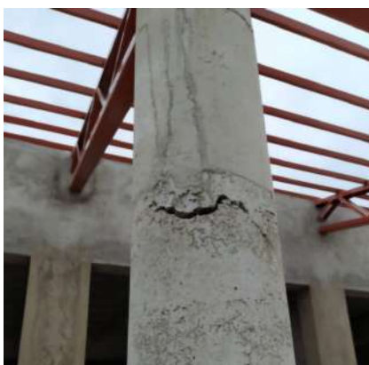
Figura 12. Falhas na concretagem do pilar.
