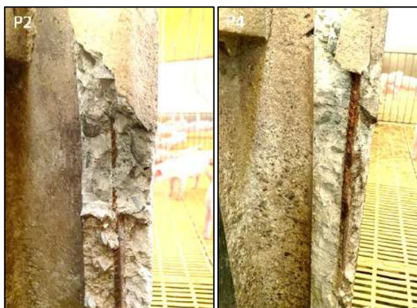
Figura 14 – Pilar P2 e P4 da edificação A após aspersão de fenolftaleína.
