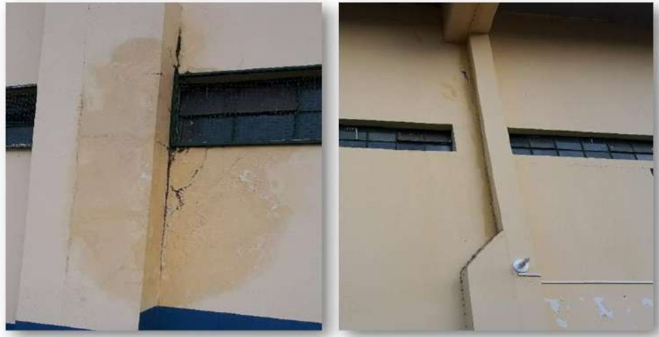
Figura 6. Manifestações patológicas localizadas na fachada. Fonte: Autor (2020).
