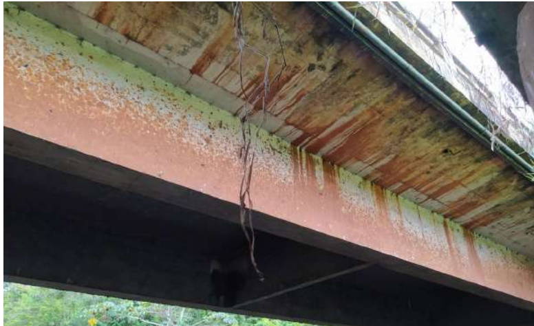
Figura 7. Manchas avermelhadas causadas por corrosão de armaduras.
