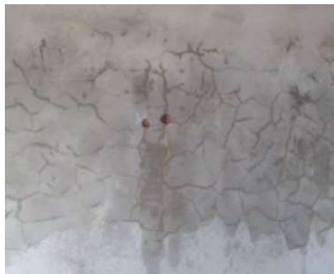
Figura 6: Caso analisado de fissuras em revestimentos de argamassa
