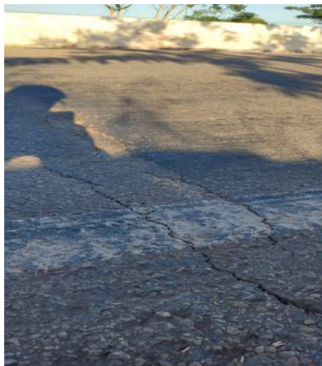
Figura 3. Fissuras no encontro com o pavimento.
