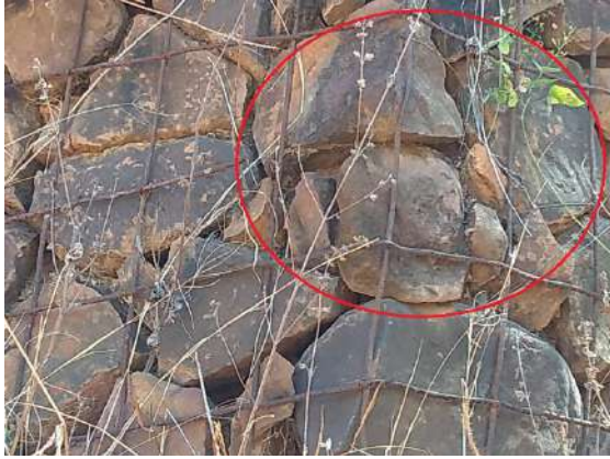
Figura 13. Rompimento da armadura do muro de gabião.
