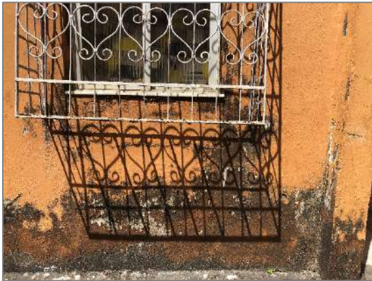
Figura 12 - Manchas na fachada posterior, Edifício B
