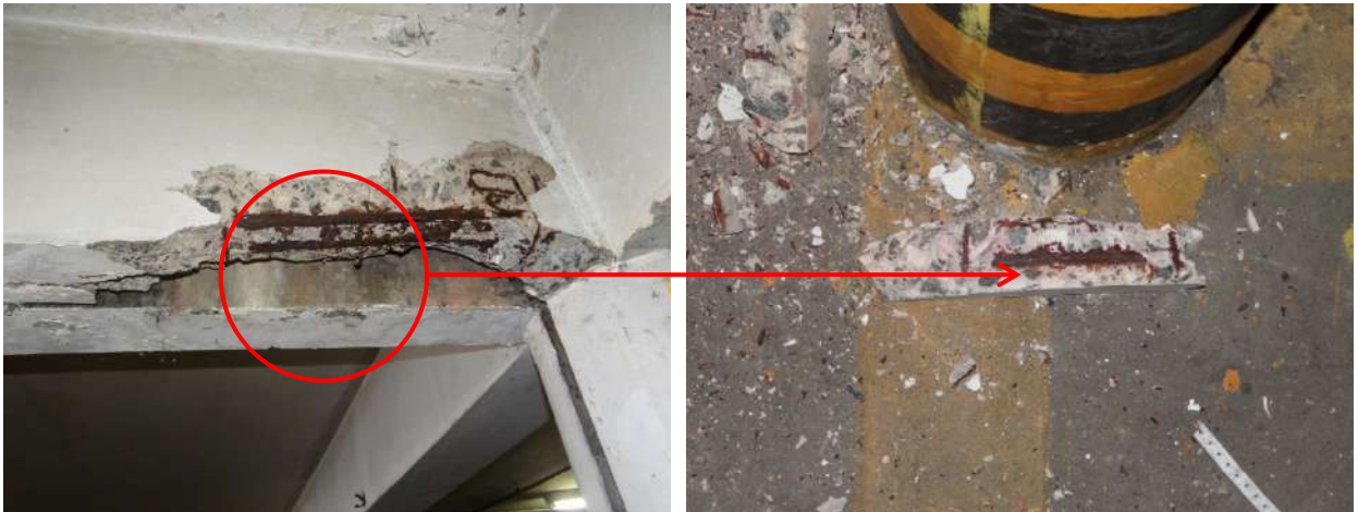
Figura 7 - Detalhe da viga em processo de corrosão e detalhe da seção da viga deslocada no concreto.
