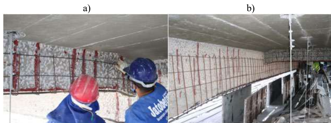
Figura 10. a) Aplicação de resina no encontro das armaduras b) Viga principal armada
