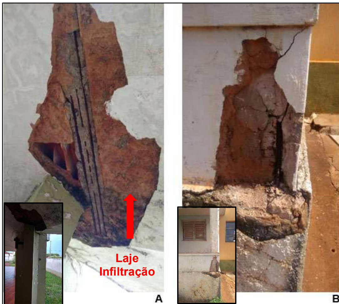
Figura 4. Corrosão em armaduras de concreto armado – Velório Municipal e Centro Comunitário Viradouro/SP.
