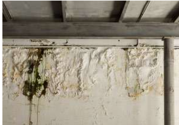
Figura 3. Infiltração em cobertura. Fonte: Leroy Merlin, 2021.
