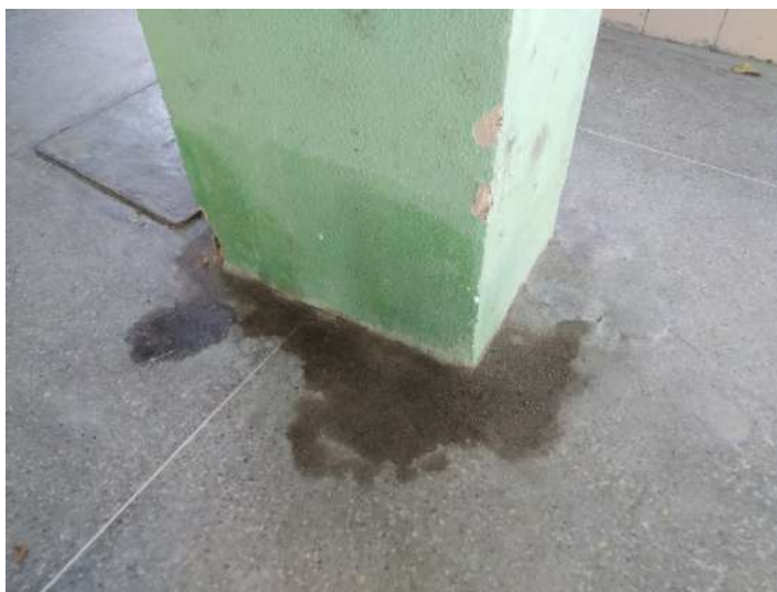
Figura 11. Pilar com destacamento da pintura e de pequena quantidade de concreto. Fonte: própria, 2019.
