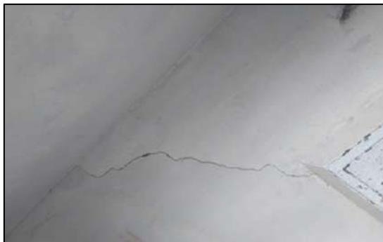
Figura 11: Fissura no hall de entrada
