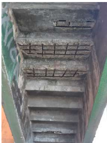
Figura 2: Deslocamento (Fi = 3). Corrosão (Fi = 2).
