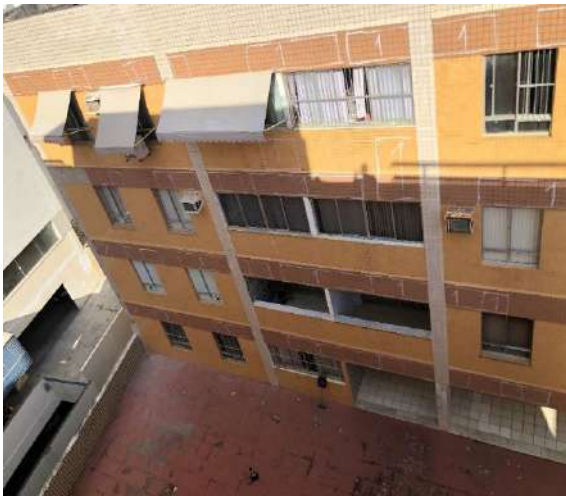
Figura 6: Marcação de som cavo e corrosão na fachada noroeste do Bloco B.
