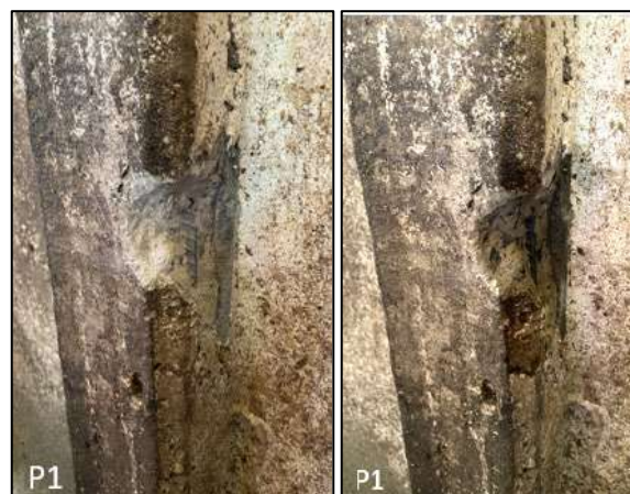
Figura 15 – Pilar P1 da edificação B antes e após aspersão de fenolftaleína.
