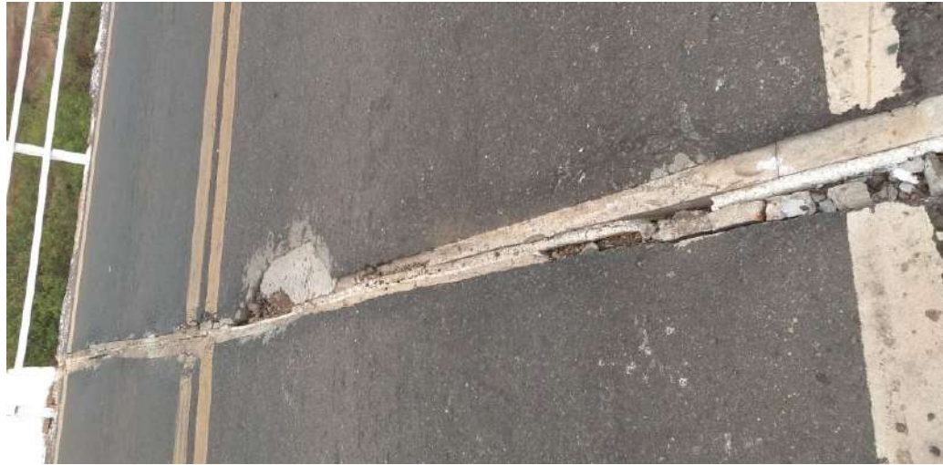
Figura 10. Rompimento do revestimento e aberturas na superestrutura.
