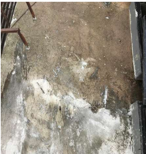
Figura 11. Desgaste da impermeabilização.
