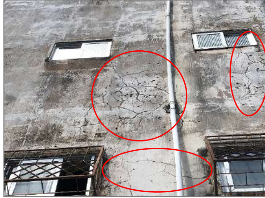
Figura 14 - Fissuras na fachada posterior, Edifício A
