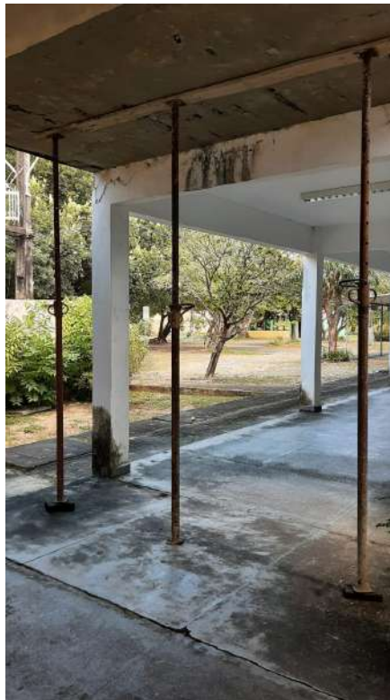
Figura 10. Laje altamente comprometida pela corrosão da armadura. Fonte: própria, 2021.
