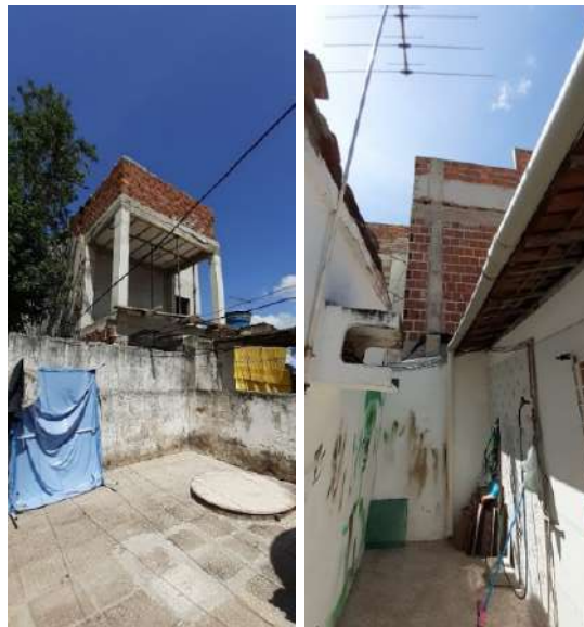
Figuras 7 e 8: Visão externa do reservatório elevado sem proteção, confrontando com dois imóveis. Fonte: Os autores.
