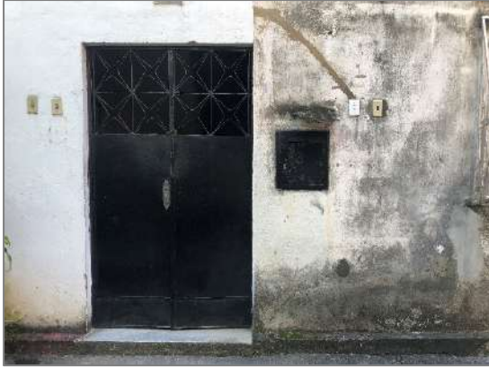
Figura 10 - Manchas na fachada frontal, Edifício A
