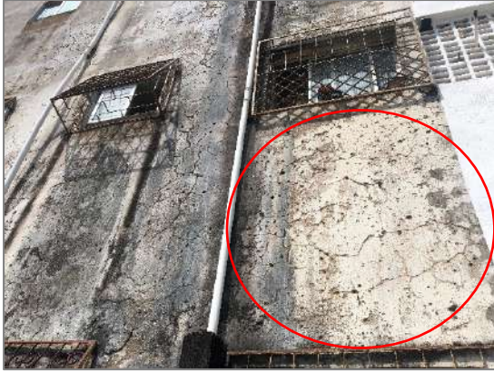
Figura 13 - Fissuras na fachada frontal, Edifício A
