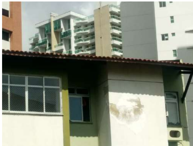
Figura 4. Umidade no quarto andar em uma parede externa. Fonte: própria, 2019.
