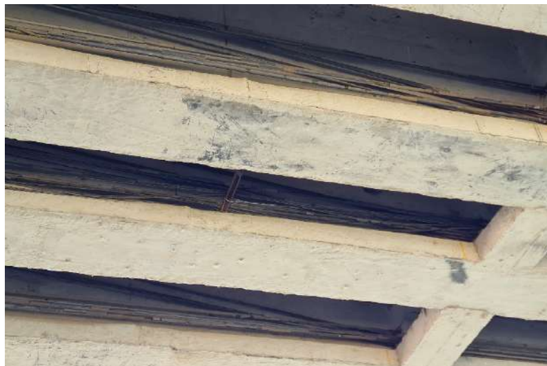
Figura 16. Ressecamento e quebra da bainha de protensão.
