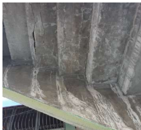
Figura 10: Eflorescência (Fi = 3). Fissuras e indícios de expansão (Fi = 2)
