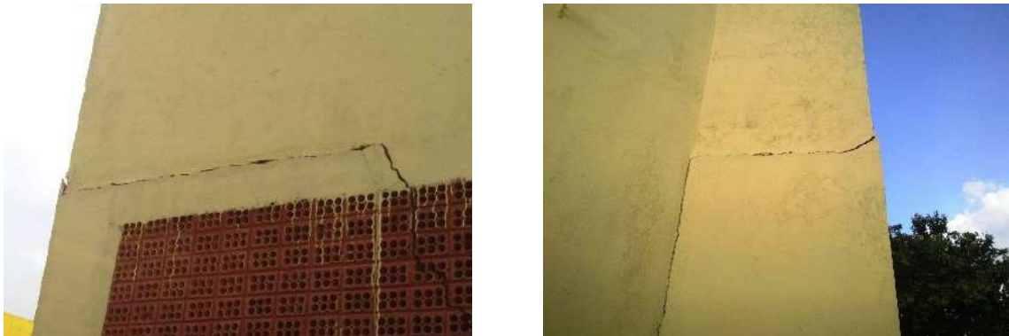
Figura 3.11. Caixa d'água com fissuras excessivas.
