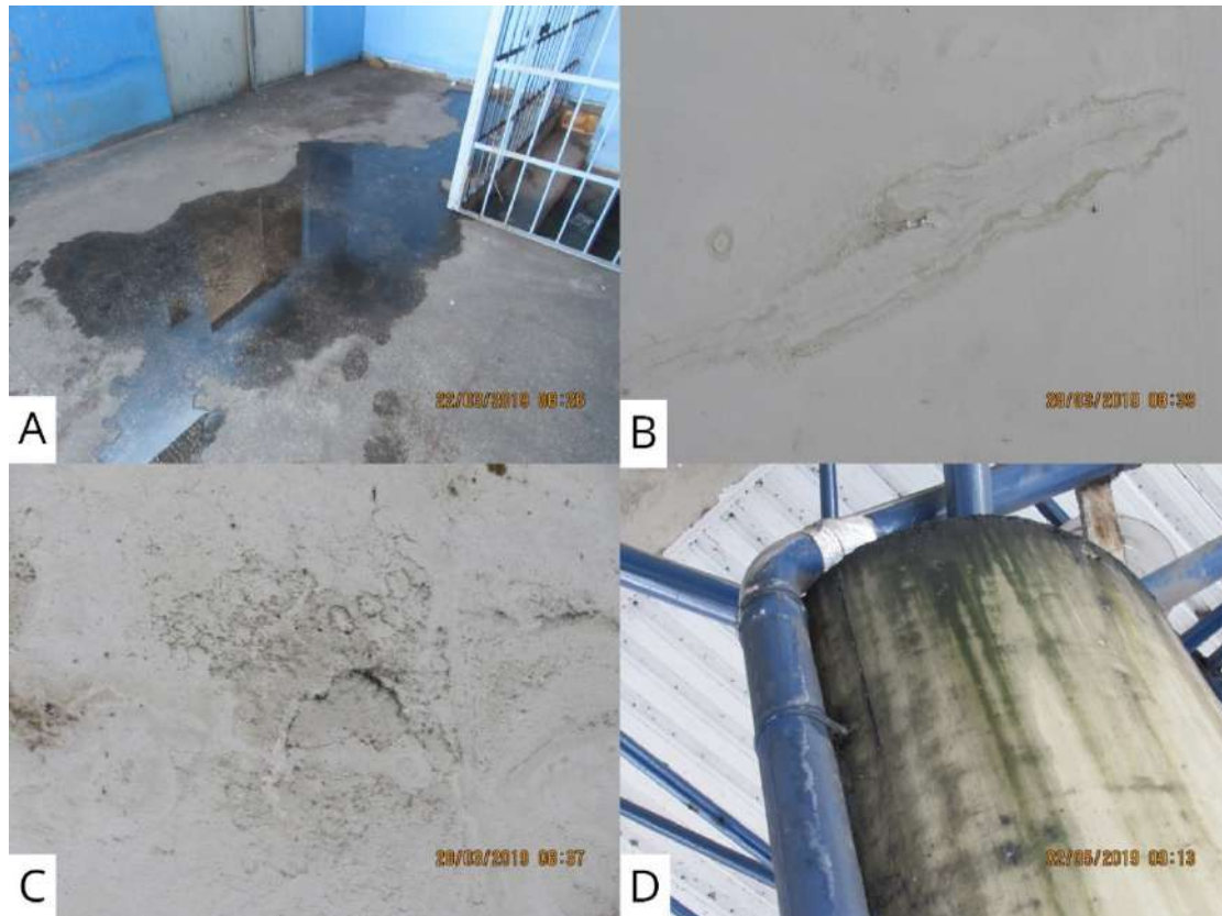
Figura 5. A: Ponto de empoçamento na laje do mezanino do T1; B: Eflorescência na parede do T2 (1/2); C: Eflorescência na parede do T2 (2/2); D: Pilar de concreto com formação de lodo abaixo de tubulação avariada no T5.
