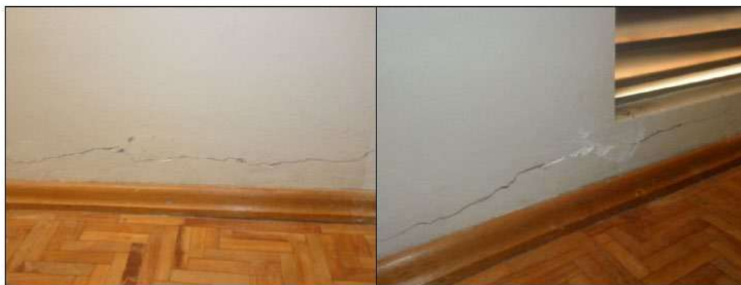
Figura 6: Fissuras horizontais (autoria própria)
