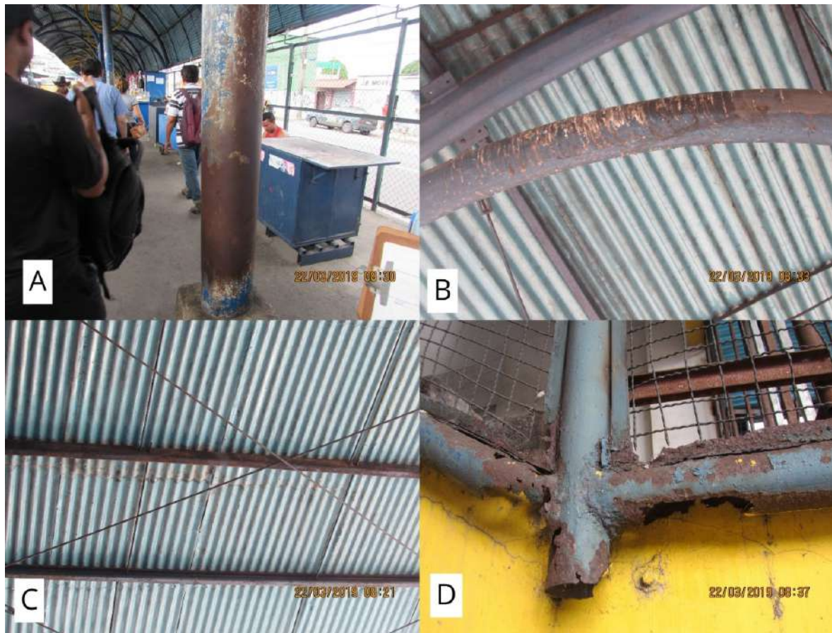
Figura 5 - A: Pilar oxidado; B: Viga contendo dejetos de pombos; C: Corrosão uniforme nas terças da cobertura; D: Corrosão em fresta e por esfoliação com perda de material no gradeamento das escadas.
