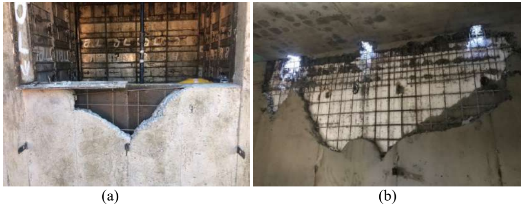
(a) (b) Figura 10. Nicho de concretagem em formato V sob vão de janela em parede de concreto na Obra A (a) e grande falha de concretagem na parte superior de parede na Obra B (b).
