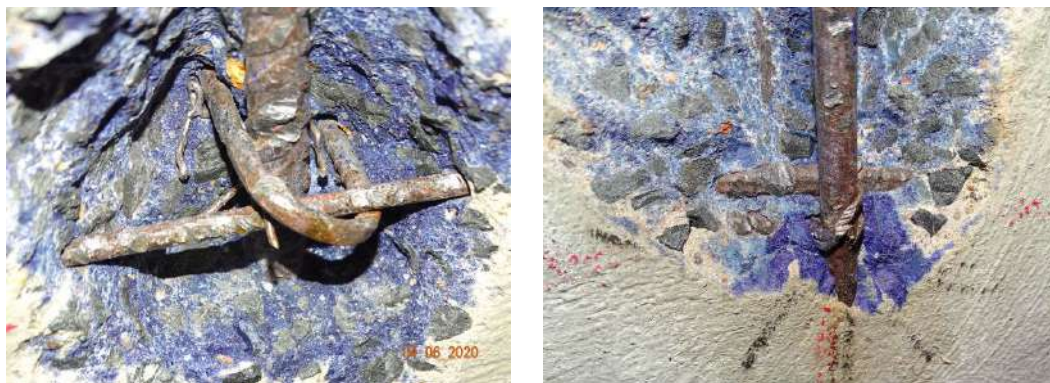
Figura 10. Detalhe do gancho da J12 e do vergalhão com cobrimento mínimo na J7, ambos com princípio de corrosão.
