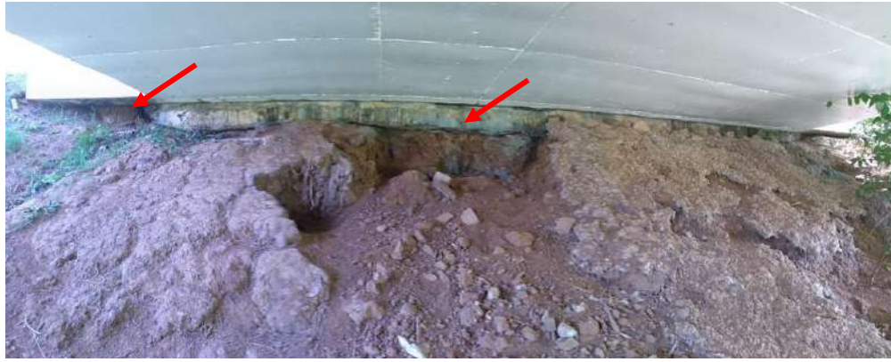
Figura 6. Vista inferior do tabuleiro, com erosão do aterro da cabeceira devido à infiltração de água.
