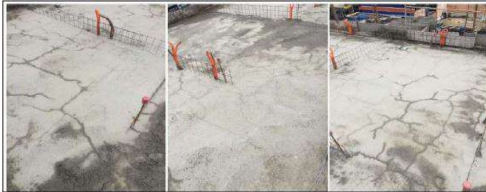
Figura 7. Fissuração mapeada verificada em lajes da Obra B.
