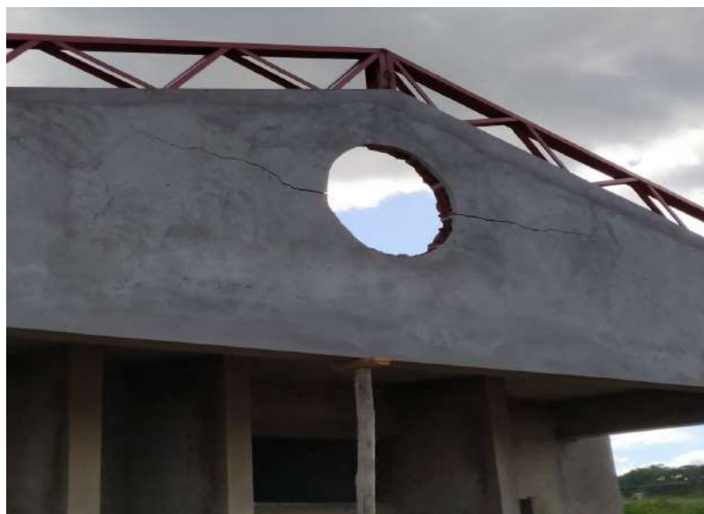
Figura 9. Fissura localizada na alvenaria da fachada.
