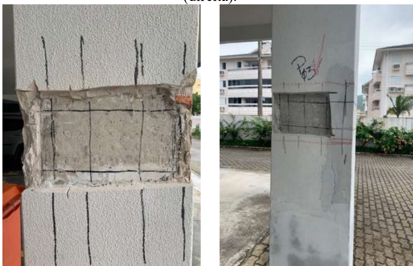
Figura 4. Janela de inspeção aberta em pilar íntegro (esquerda) e em pilar apresentando fissuras (direita).
