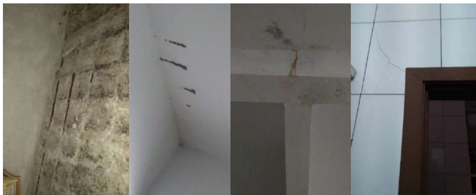
Figura 8. (a) Corrosão das armaduras na rampa do estacionamento; (b) Corrosão na laje; (c) Sinais de umidade e corrosão na viga; (d) Fissura no revestimento cerâmico próximo à abertura.
