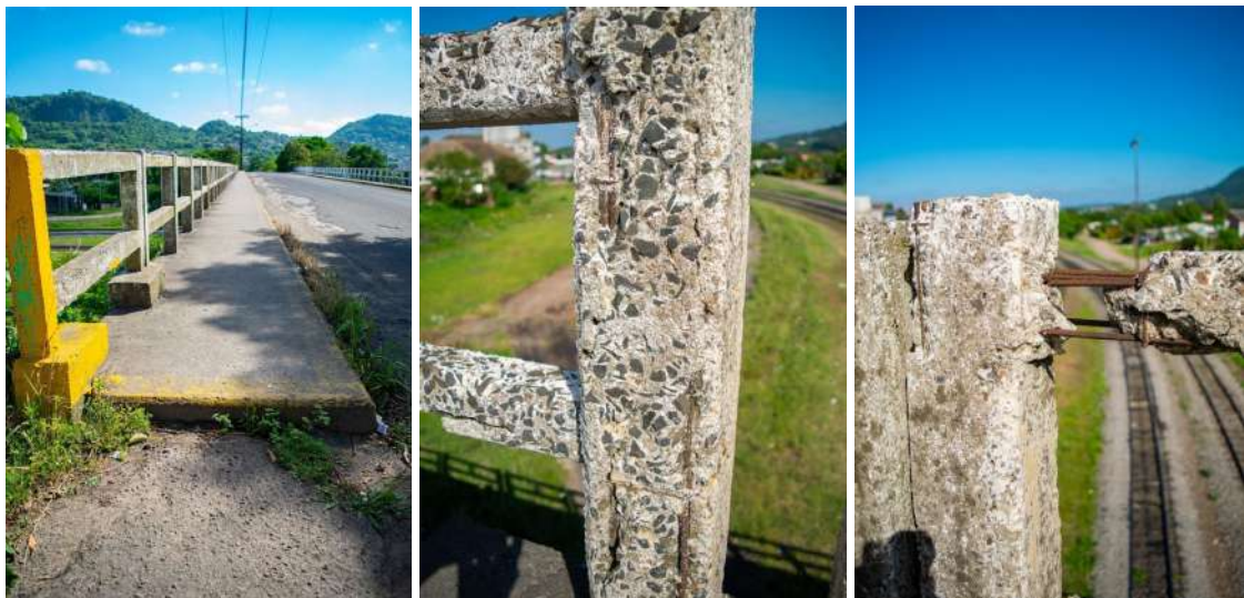
Figura 9. Detalhe dos danos no guarda-corpo.
