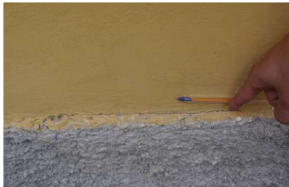
Figura 4. Fissura geométrica horizontal na base da alvenaria na fachada frontal. Fonte: os autores.
