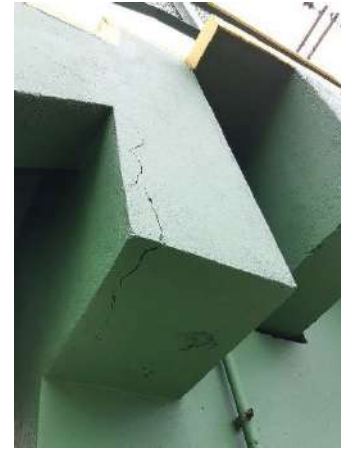
Figura 33: Fissuras (Fi = 1). Armadura exposta (Fi = 1)
