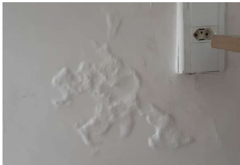
Figura 4. Formação de bolhas na pintura de acabamento.
