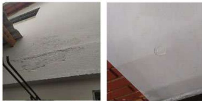
Figura 16. Irregularidade no acabamento por falta de material de regularização
