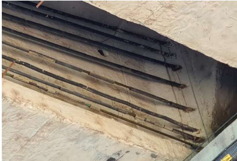
Figura 17. Ressecamento e quebra da bainha de protensão.
