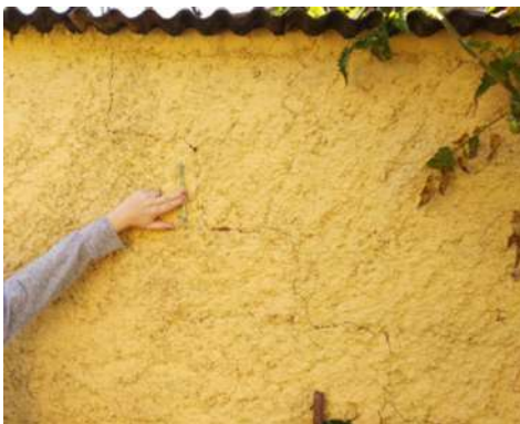
Figura 3. Trinca no muro frontal causada por variação térmica da estrutura. Fonte: os autores.
