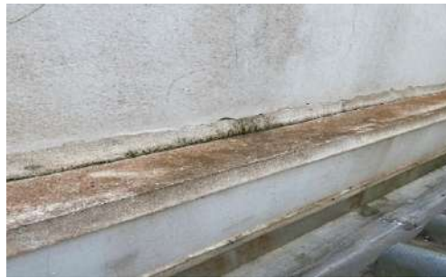
Figura 12. Fissura no revestimento.
