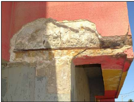
Figura 5 – Deslocamento e corrosão, V25
