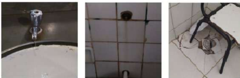
Figura 17. Problemas nas instalações hidráulicas que não tiveram soluções propostas
