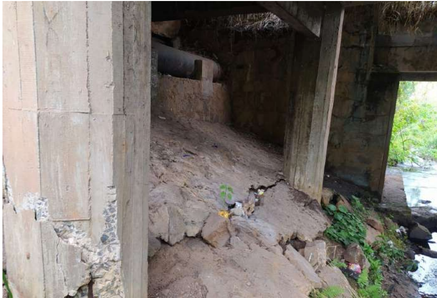
Figura 10. Processo de Erosão do encontro.
