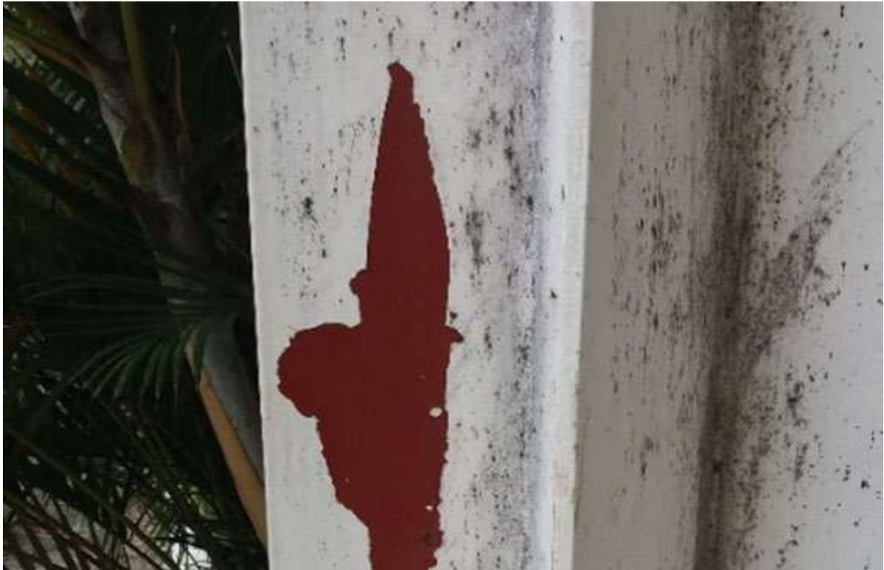
Figura 4. Patologia em pintura detectada na estrutura
