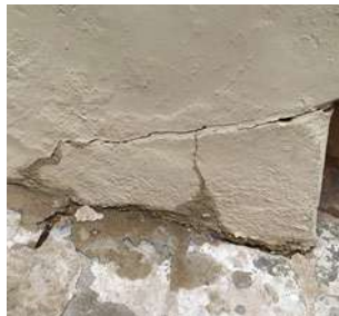
Figura 5. Reincidência de trinca ativa
