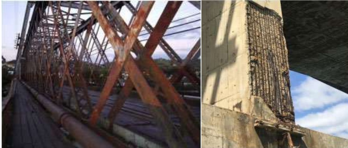
Figura 2. Corrosão da superestrutura da ponte. Figura 3. Corrosão das armaduras do pilar. Fonte: Lourenço et al. (2009, p.28) Fonte: Santos e Silva (2017, p.54)
