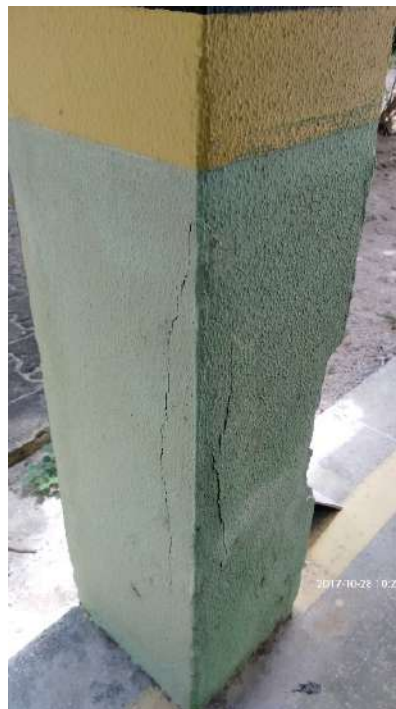
Figura 6. Esmagamento do concreto que gerou trincas no pilar. Fonte: própria, 2019.
