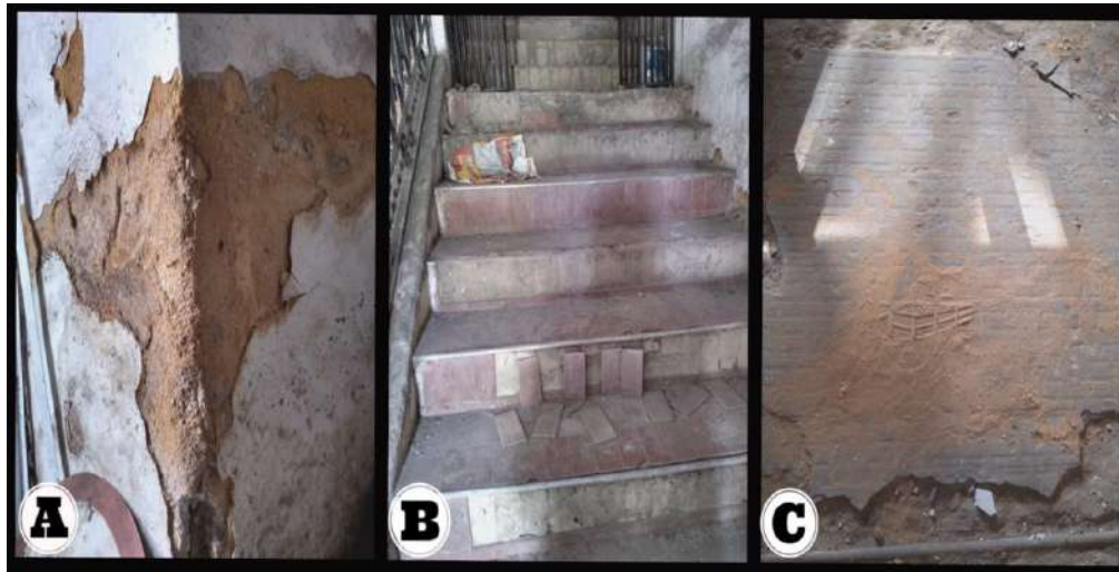
Figura 3. Deslocamento de: emboço em alvenaria (A), emboço em revestimento cerâmico da escada (B), revestimento cerâmico do piso (C) (Autor, 2021).
