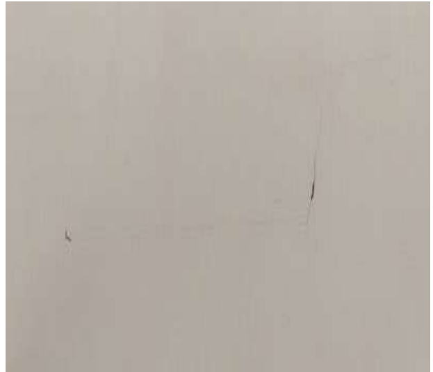
Figura 14- Parede do lado direito das portas principais. Patologia: fissura Fonte: Os autores, 2021.
