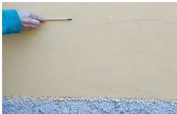
Figura 5. Fissura geométrica horizontal em camada inferior da alvenaria na fachada posterior. Fonte: os autores.
