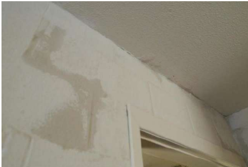
Figura 3. Vazamento da tubulação de água, gerando mancha úmida e extensa na parede (Ramos, 2015).
