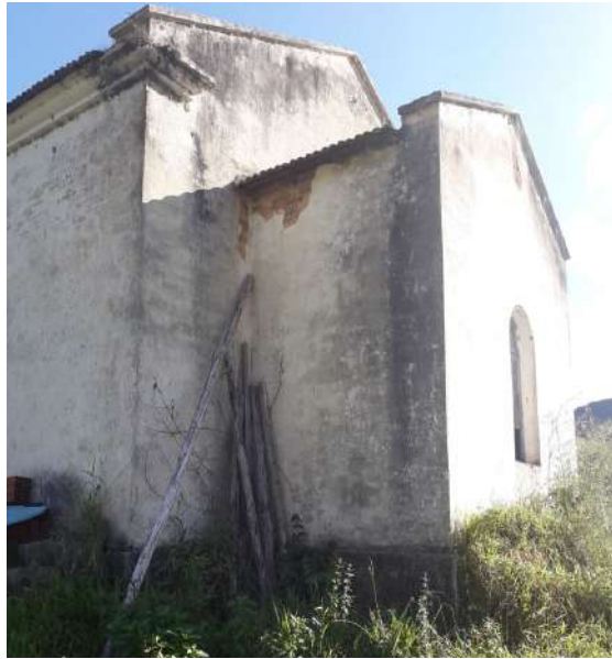
Figura 4. Manifestações patológicas verificadas na fachada norte. Fonte: (Lessa, 2021).
