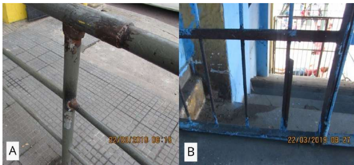
Figura 6 - A: Corrosão em torno do cordão de solda; B: Corrosão por pite nos portões do mezanino
