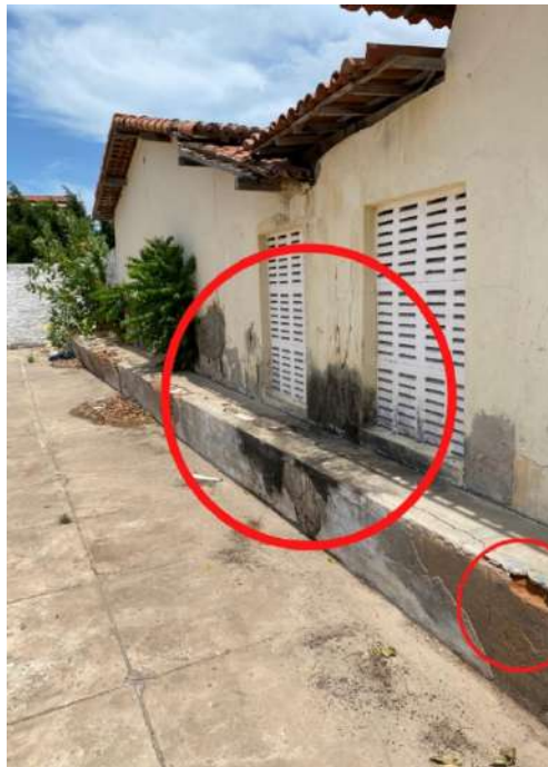
Figura 8: Fissuração e degradação da estrutura.
