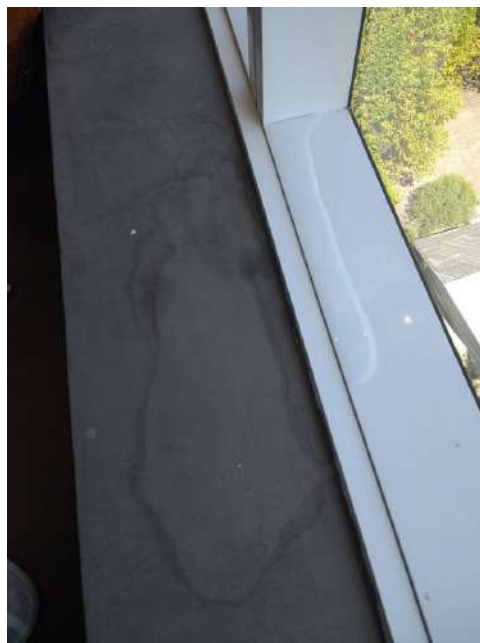
Figura 7: Mancha de infiltração da esquadria
