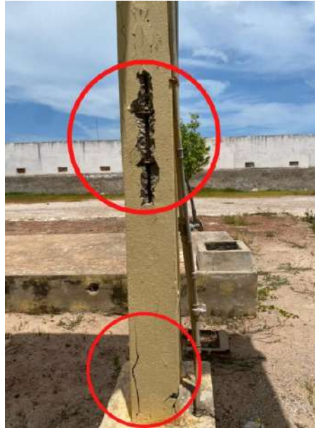
Figura 5: Exposição da armadura e fissuras
