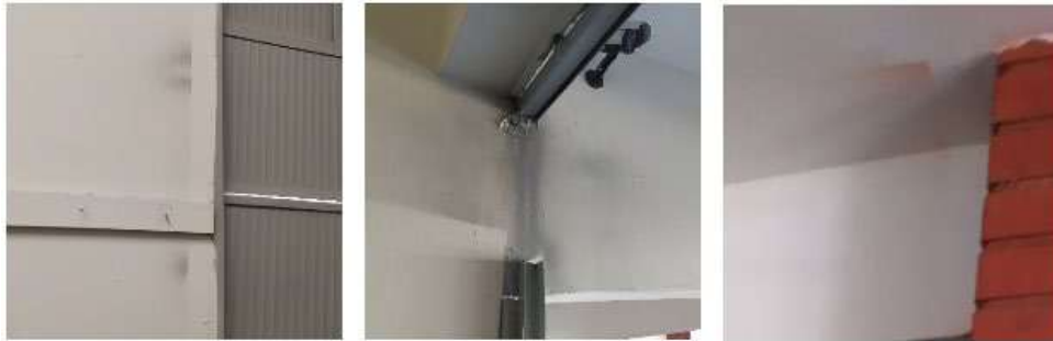
Figura 15. Mancha de tinta por não proteção adequada dos outros acabamentos
