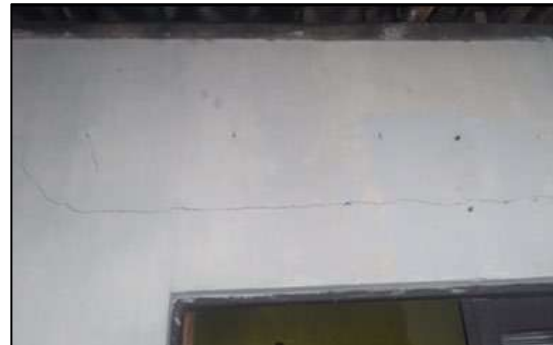
Figura 12: Fissura acima da porta de entrada
