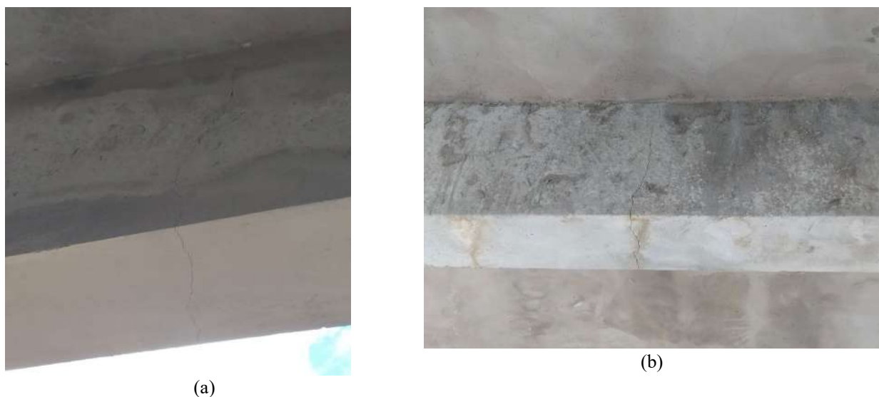
Figura 7. Fissura localizada na viga (a) e (b).
