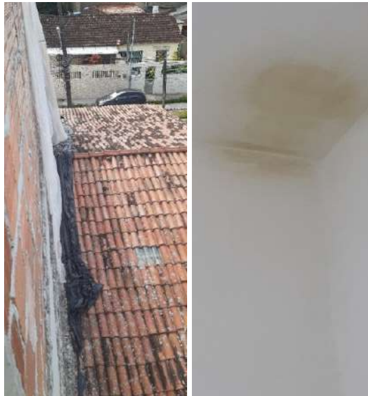
Figuras 5 e 6: Infiltrações no teto da parede divisória entre os imóveis. Fonte: Os autores.
