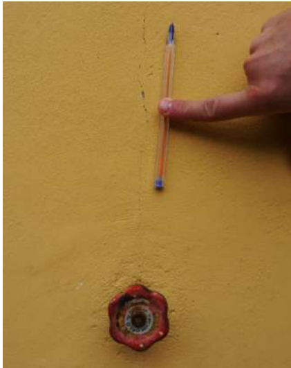
Figura 98. Fissura provávelmente causada pelo embutimento de tubulação hidráulica na alvenaria. Fonte: os autores
