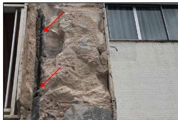
Figura 12 – Deslocamento e corrosão
