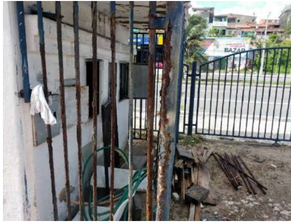
Figura 2. Grades de proteção da edificação com alto grau de corrosão. Fonte: própria, 2019.
