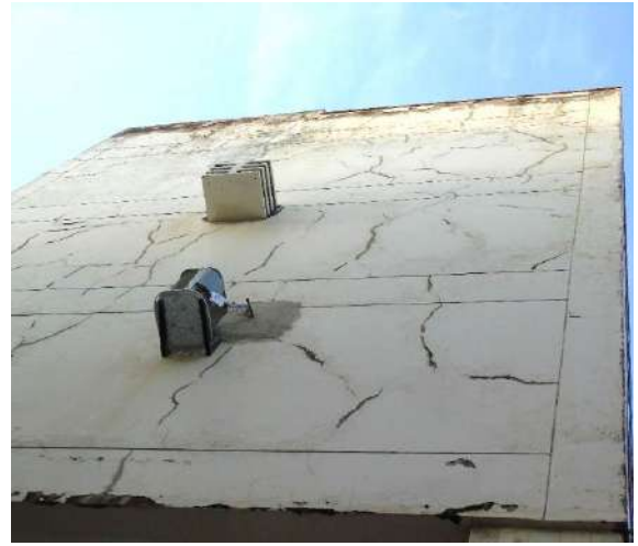
Figura 17: Fissuras na fachada sudoeste do Bloco A.
