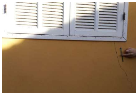
Figura 7. Fissura inclinada em aproximadamente 45^\circ na parte inferior do vão de janela. Fonte: os autores.
