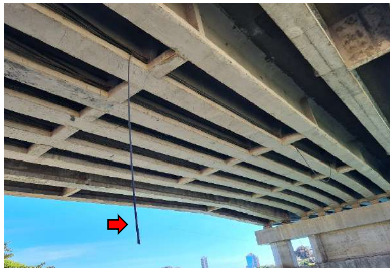
Figura 13. Vista da ruptura do cabo de protensão, por baixo da estrutura.
