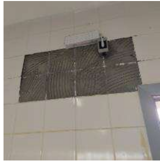
Figura 12. Desplacamento de revestimento cerâmico após a intervenção
