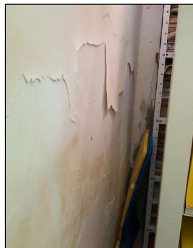
Figura 7 - Descolamento na pintura da parede do térreo devido a infiltração. Fonte: (Autoria própria, 2020)
