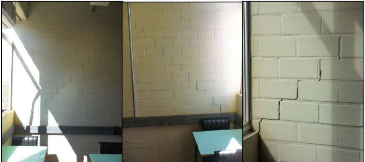
Figura 2: Fissuras a 45° em alvenaria (autoria própria)
