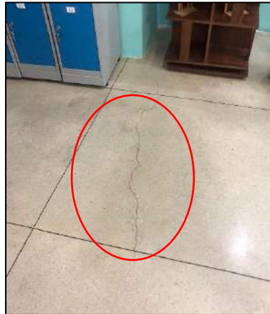
Figura 12 - Fissura e som cavo no piso da biblioteca. Fonte: (Autoria própria, 2020)
