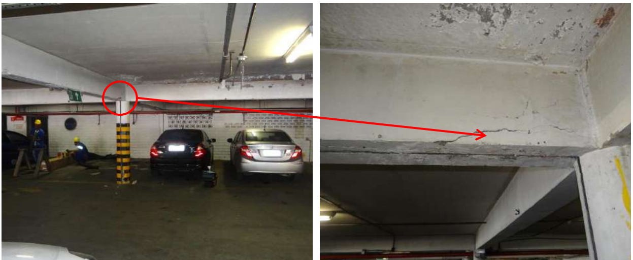
Figura 6 – Vista da viga (trecho 1) em processo de corrosão e detalhe 1 da viga em processo de corrosão.
