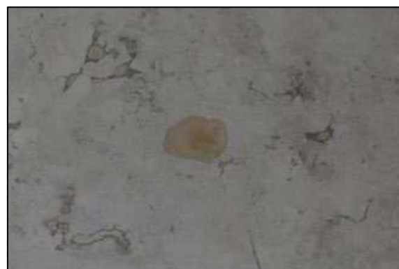
Figura 14 – Manchamento de superfície
