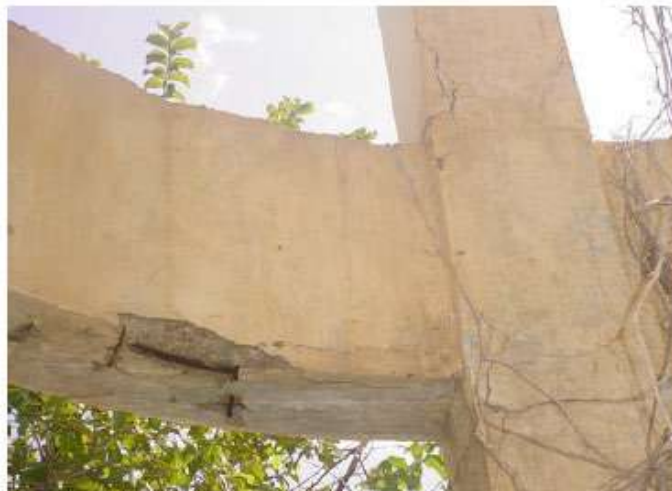
Figura 03. Destacamento em reservatório de concreto armado. Fonte: Borges (2008).
