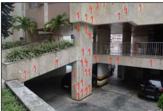
Figura 11 – Mapeamento de danos na fachada
