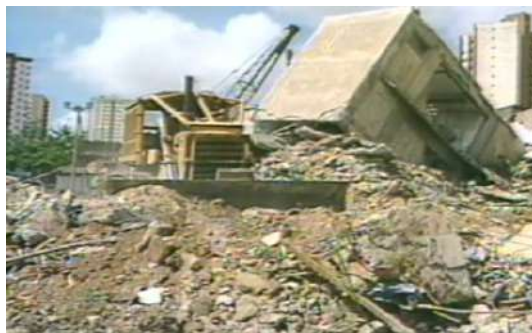
Figura 2. Desabamento do edifício Raimundo Farias ocorrido em 1987, que apresentava 13 andares, e estava em fase de execução. 39 operários vieram a óbito. Belém/Pa.
