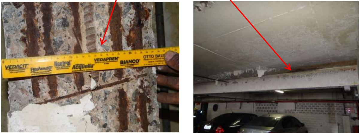
Figura 9 – Detalhe da corrosão da viga (trecho 2) e vista da desfragmentação da pintura da laje.
