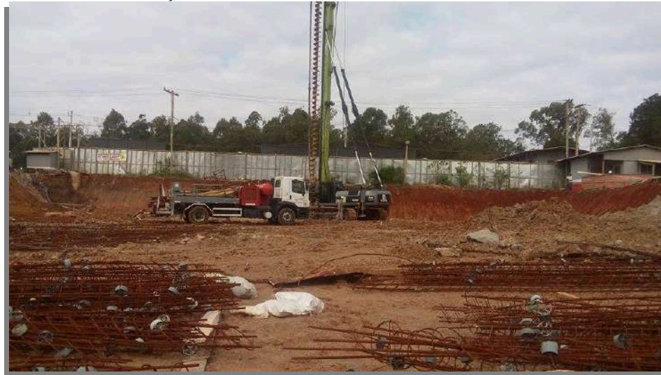
Figura 1: Perfuratriz e caminhão bomba na obra de estudo – compreendendo a execução de fundações em estacas hélice contínua monitorada
