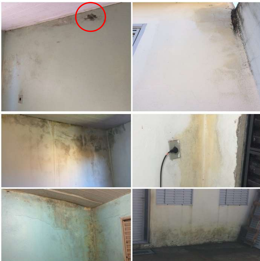
Figura 4: Exemplo de manchas de mofo nas residências
