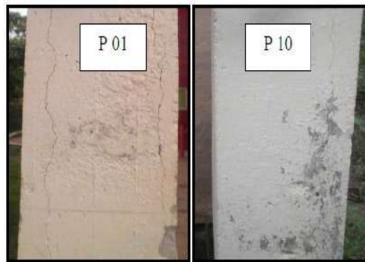
Figura 3.6. Pilar com fissuras.
