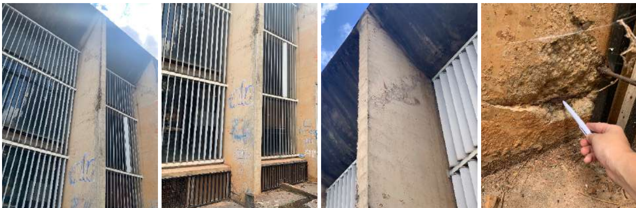
Figura 9 - Pilar 13: ninhos de concretagem e corrosão das armaduras.
