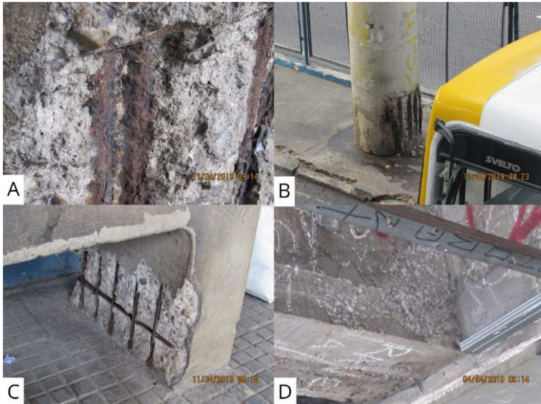
Figura 4. A: No T4, base de pilar com armadura exposta em estágio avançado de oxidação; B: No T4, base de pilar de passarela com armadura exposta em alto grau de corrosão; C: Base de assento de concreto deslocada e com armadura exposta no T4; D: Viga no T3 apresentando ninhos de concretagem gerados na execução do elemento estrutural.
