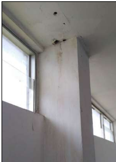
Figura 10 - Infiltração de água pluvial com degradação do forro de gesso no terceiro pavimento. Fonte: (Autoria própria, 2020)
