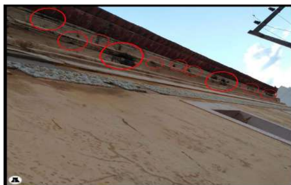
Figura 6. Infiltração em: (A) Alvenaria da Fachada (Autor, 2019).
