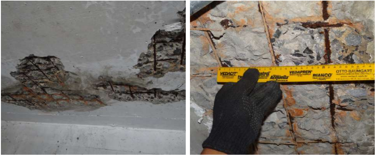
Figura 16 - Detalhe da corrosão na laje e detalhe da corrosão na laje.
