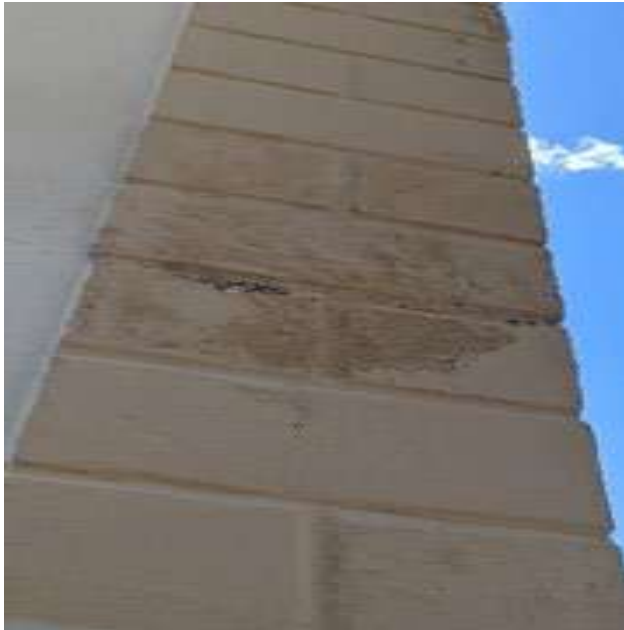
Figura 11- Parede da vista esquerdo frontal. direito da parede, no canto superior. Patologia: Saponificação. Fonte: Os autores, 2021.
