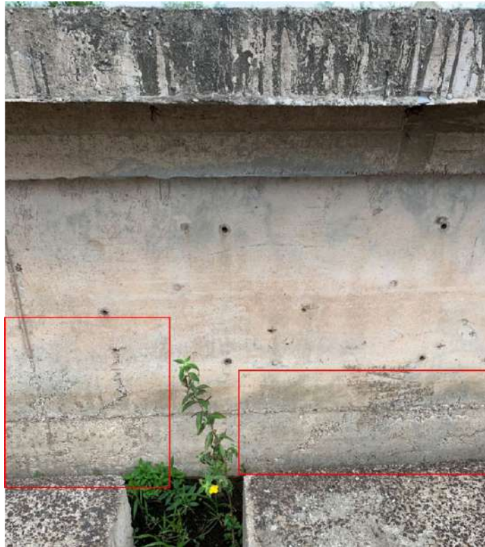
Figura 9. Segregação das partes constituintes do concreto
