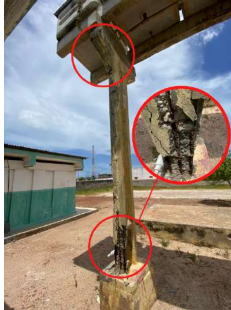
Figura 4: Exposição da armadura e oxidação
