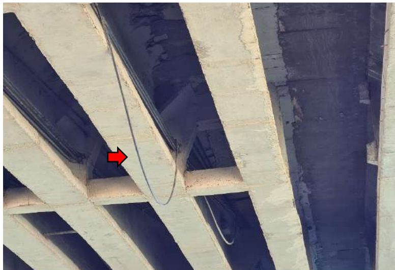
Figura 14. Cabo de protensão com afrouxamento.
