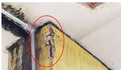
Figura 7 – Deslocamento de Concreto e exposição de ferragens no pilar 3
