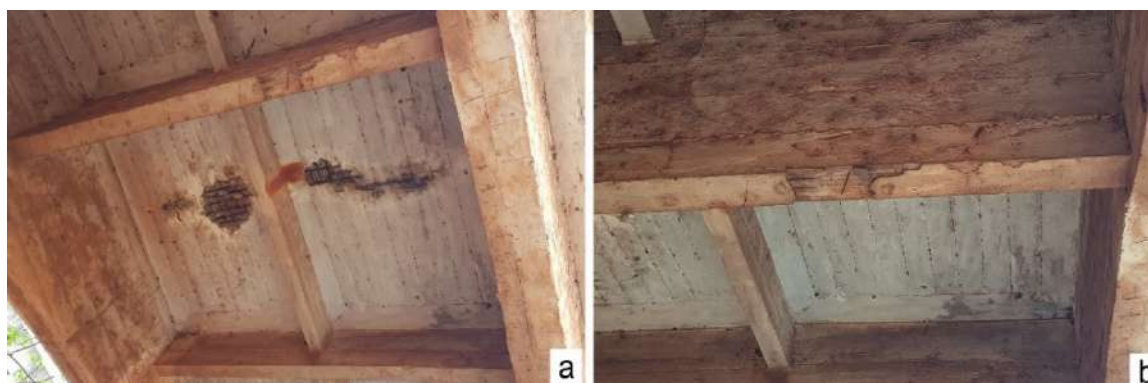
Figura 3. (a) Corrosão da armadura na laje (b) corrosão da armadura na transversina
