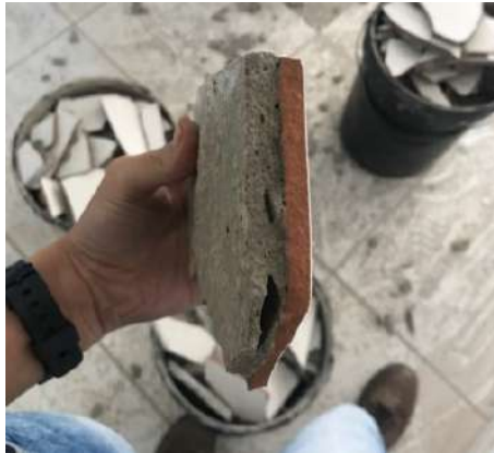
Figura 4. Descolamento entre a argamassa colante ACII e a argamassa polimérica em um piso de banheiro da Obra A.
