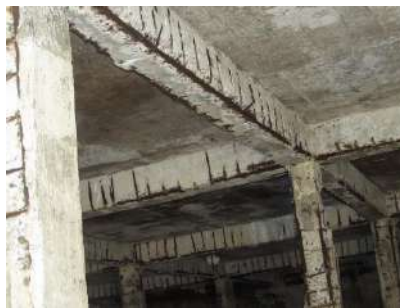
Figura 9. Vigas em estado de ruína em RAP.
