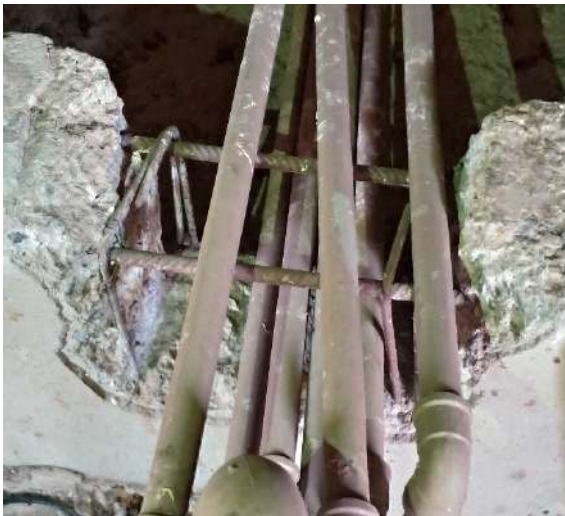
Figura 9. Danos na viga.
