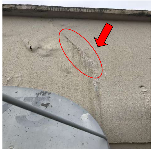
Figura 2. Manchas brancas de eflorescência.
