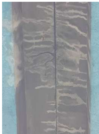
Figura 29: Eflorescência (Fi = 2) e deslocamento (Fi = 1).
