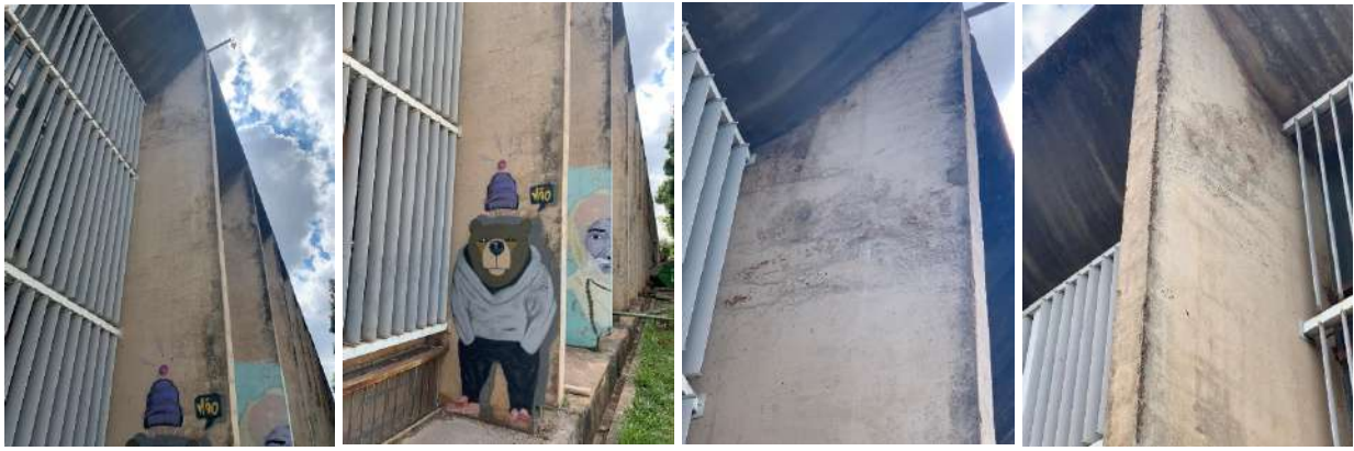
Figura 7- Pilar 8: ninho de concretagem.
