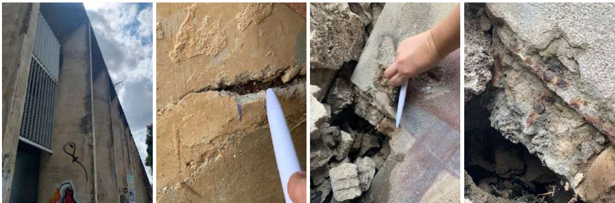
Figura 6 - Pilar 6: ninho de concretagem e corrosão das armaduras.
