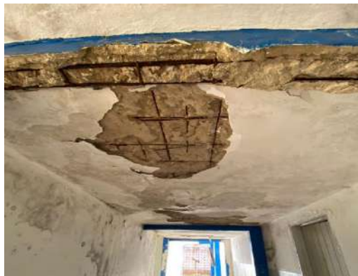
Figura 9: Armaduras expostas no teto
