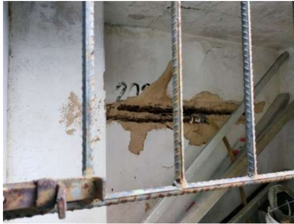
Figura 13. Corrosão da tubulação de gás GLP (Gás Liquefeito de Petróleo). Fonte: própria, 2018.
