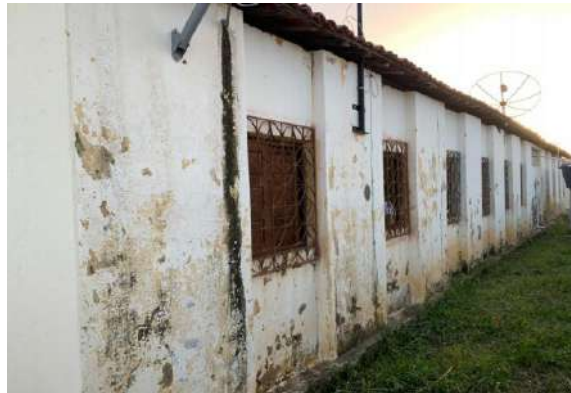
Figura 5: Degradação das paredes
