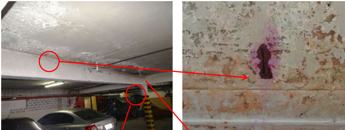
Figura 81 - Vista da viga (trecho 2) em processo de corrosão e detalhe da corrosão da laje.
