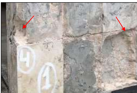
Figura 13 – Desagregação da argamassa
