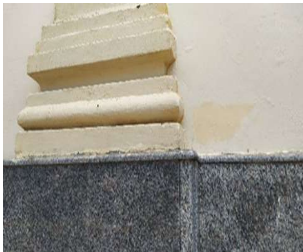
Figura 7- Parede da vista frontal da fachada. Lado esquerdo. Patologia: eflorescência. Fonte – Os autores, 2021
