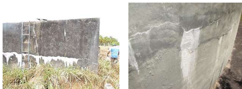
Figura 12. Paredes de caixas em estado ruim
