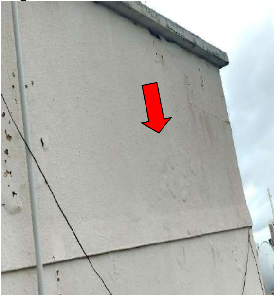
Figura 3. Sinais de infiltração.
