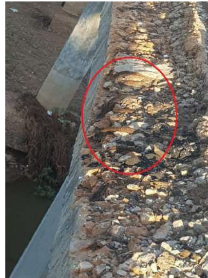
Figura 6. Armadura exposta no tabuleiro da ponte.
