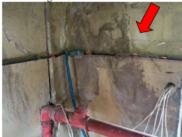
Figura 8. Fissuras na casa de máquinas.
