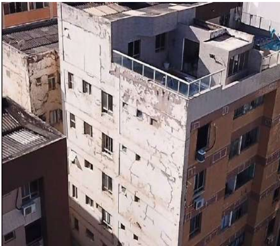
Figura 18: Vista da fachada sudoeste do Bloco B com fissuras e deslocamento.
