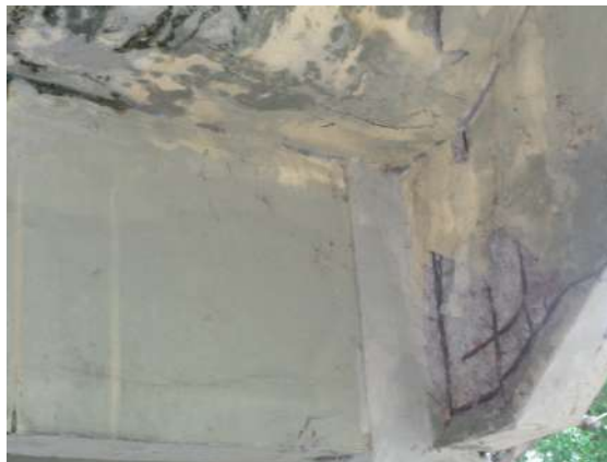
Figura 2. Armadura de uma viga exposta e corroída como também a eflorescência. Fonte: própria, 2021.
