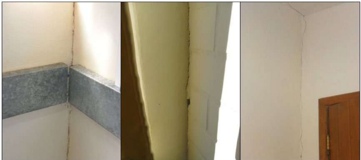
Figura 3: Fissuras de destacamento entre ligações de estrutura/vedação (autoria própria)
