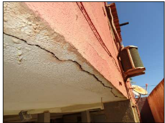
Figura 6 – Fissuração no fundo da viga
