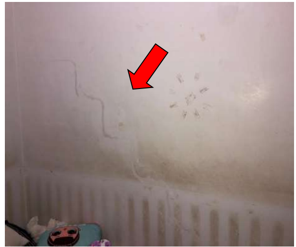
Figura 16. Fissura na parede do apartamento.
