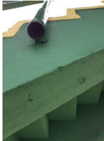
Figura 32: Falhas de concretagem (Fi = 1).
