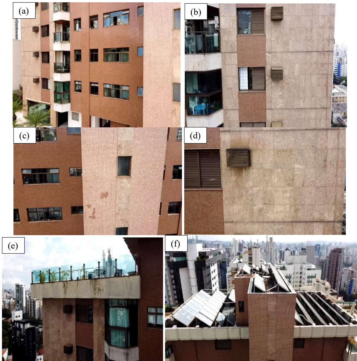
Figura 4. Vistorias da fachada capturada com o auxílio de drone: a) vista da fachada posterior; b) revestimento em pedras de granito; c) na fachada já houve recomposição do revestimento em pastinha que se deu em outra tonalidade; d) manchas no revestimento das pedras. Indica-se a realização do teste a percussão para verificação da aderência das peças; e) devido à presença de manchas e trincas, é necessário realizar a quebra do material ou um ensaio de potencial de corrosão, de modo a aferir as barras de aços no interior do concreto; f) vista da cobertura.
