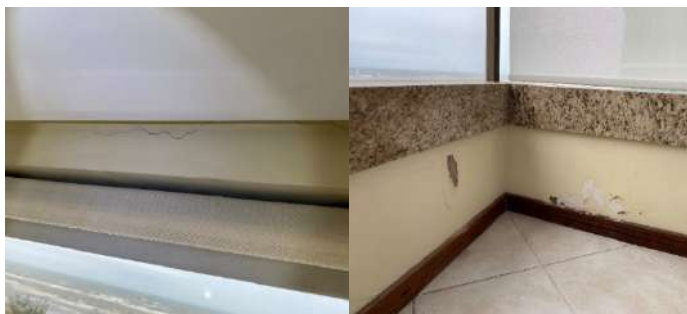
Figura 10. (a) Dano no revestimento próximo à abertura; (b) Problema por umidade ascensional no revestimento da sacada.
