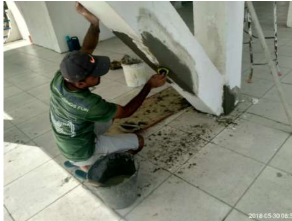
Figura 8. Operário fazendo o reparo convencional da corrosão na armadura em uma viga de contraventamento. Fonte: própria, 2018.
