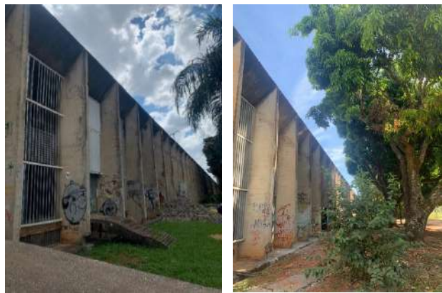
Figura 5 – Linha de pilares da fachada externa sem vegetação próxima(esquerda) e com vegetação próxima (direita)– Ala leste do Bloco A.
