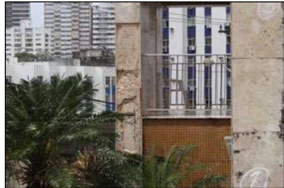
Figura 4 – Desplacamento do revestimento
