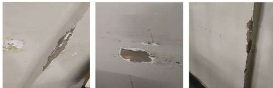
Figura 10. Perda de material por impacto de equipamentos
