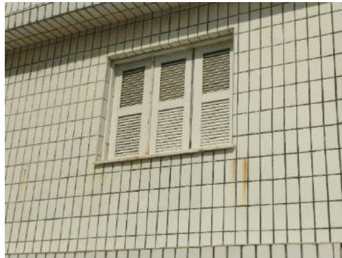
Figura 11. Corrosão nos pregos que foram fixados na fachada da edificação sobre o revestimento cerâmico. Fonte: própria, 2019.
