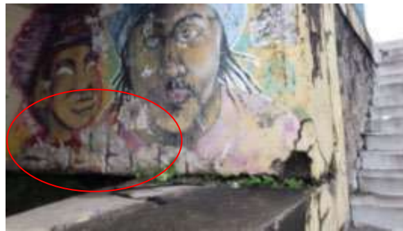
Figura 10 – Deterioração da estrutura de contenção na Cabeceira Sul da OAE
