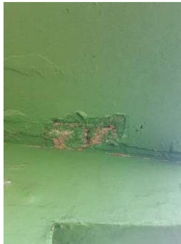
Figura 6: Exposição de armadura (Fi = 2).
