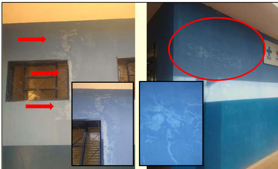
Figura 5. Eflorescência em alvenarias – Posto de Saúde PSF2 Viradouro/SP
