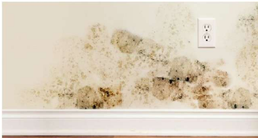
Figura 1. Parede com o surgimento de manchas escuras, como mofo, que podem indicar a presença de microrganismos danosos à saúde (Brucke, 2018).
