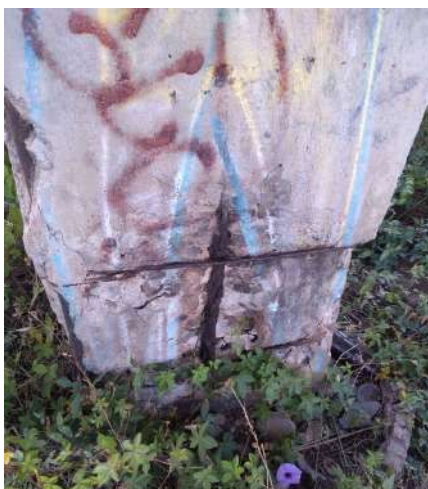
Figura 6. Pilar 5 com armaduras expostas.
