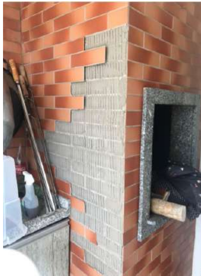
Figura 6. Descolamento de revestimento
