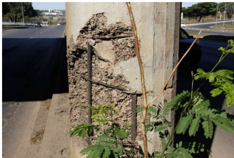
Figura 5 - Elemento pilar com corrosão de armadura e deslocamento
