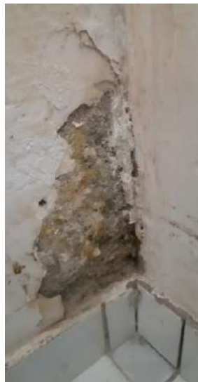
Figura 6. Eflorescência (depósitos de sais).
