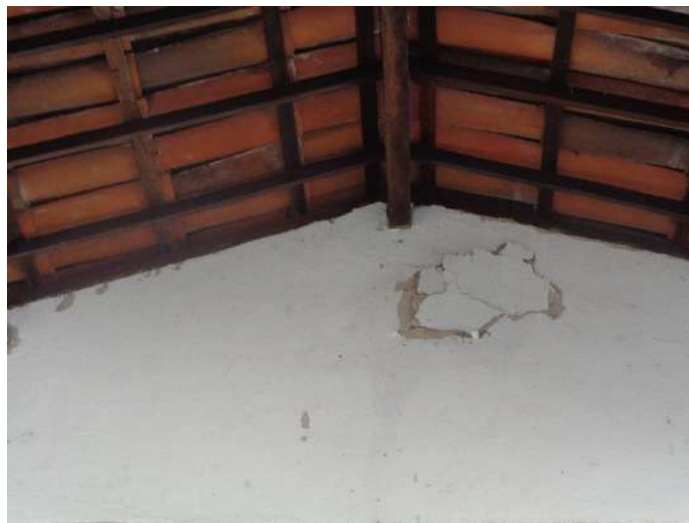
Figura 6. Fissuras com o deslocamento do reboco. Fonte: própria, 2021.
