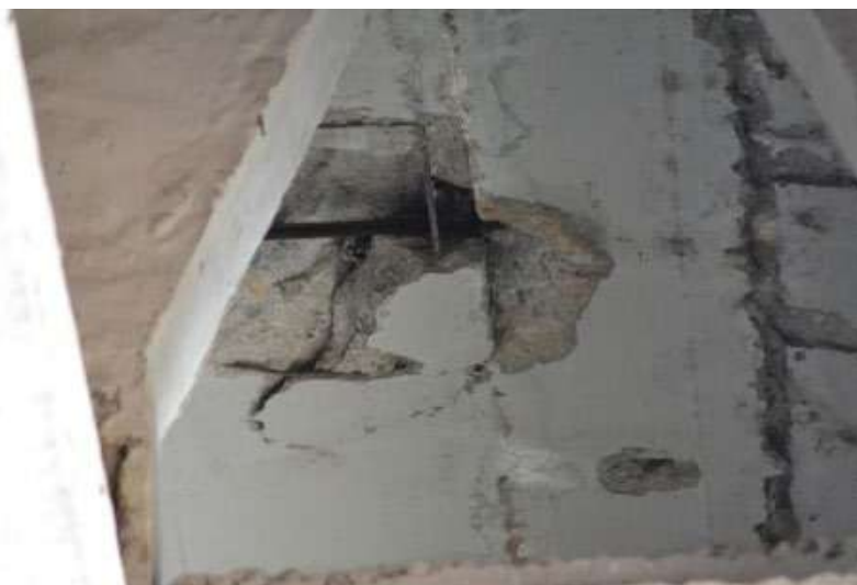
Figura 7. Outro ponto da laje com armadura sem cobertura e com indicio de corrosão.
