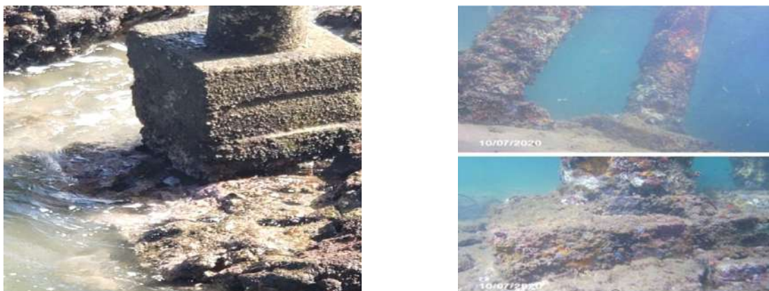
Figura 2: Corrosão avançada no bloco do atracadouro do píer.
