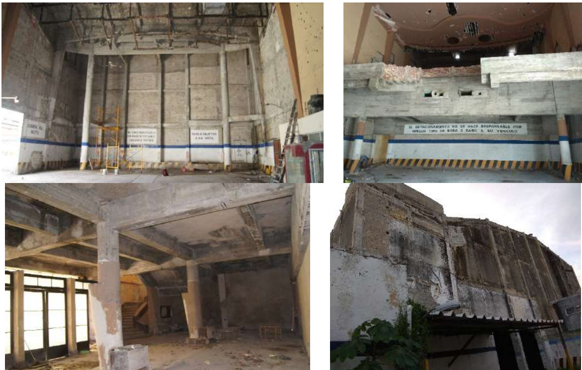
Figura. 2. Estado en que se encontraba la estructura antes de ser intervenida
