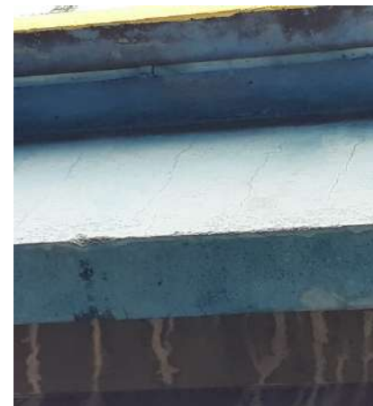
Figura 30: Fissuras de flexão (Fi = 1) em vigas.
