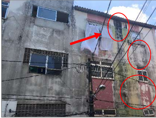
Figura 6 - Descoloração na fachada frontal, Edifício A
