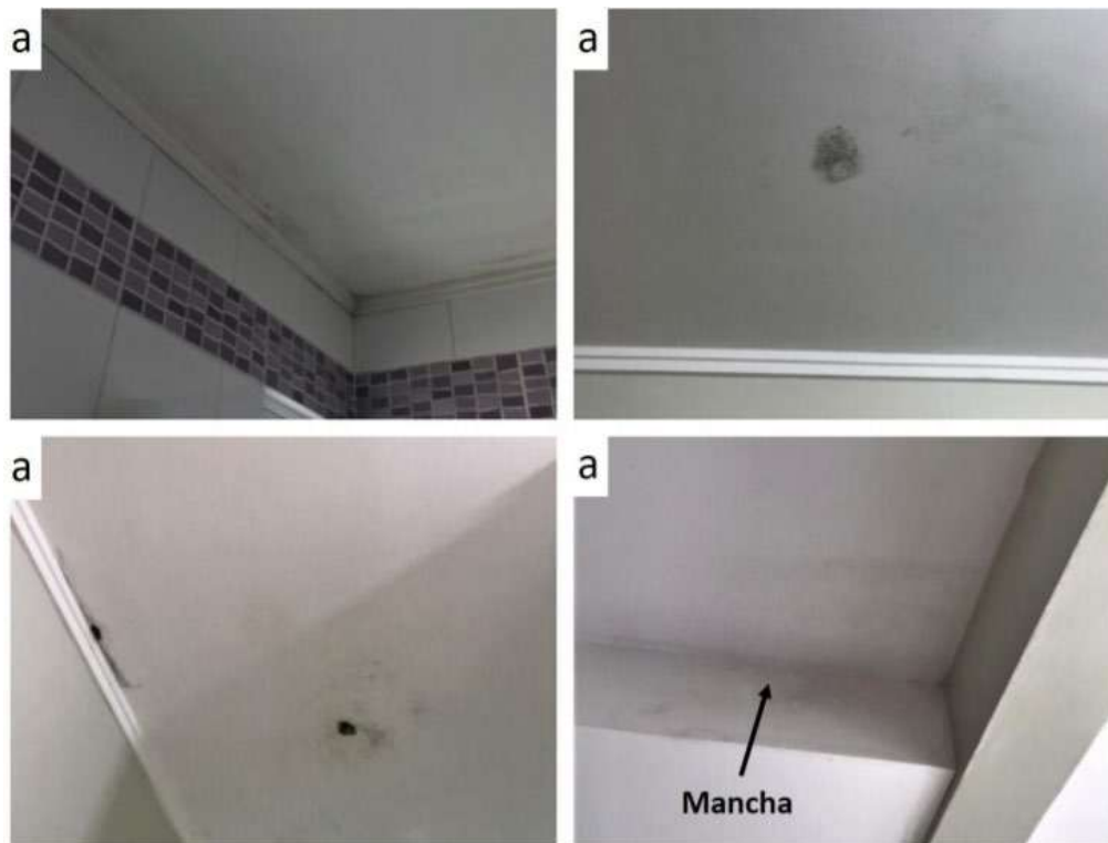
Figura 4. Bolor em forro do banheiro
