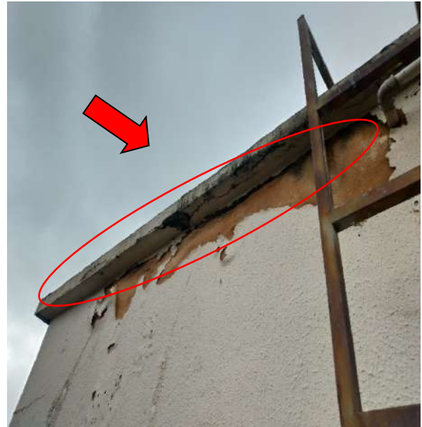
Figura 14. Destacamento da pintura.
