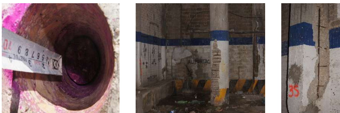
Figura. 3. Carbonatación y desprendimiento del concreto
