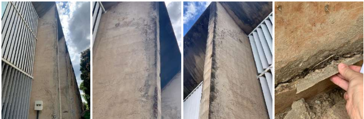
Figura 8 - Pilar 10: ninho de concretagem e corrosão das armaduras.
