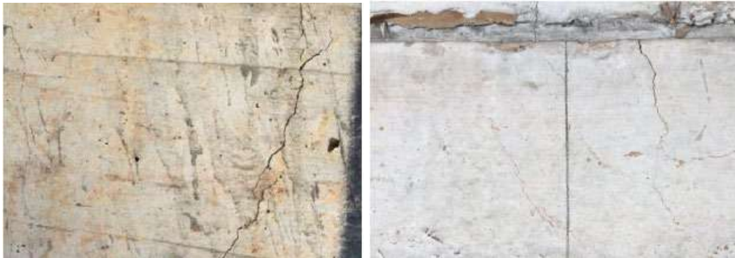
Figura 6. Fissuras em elementos estruturais.
