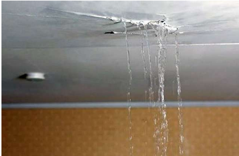
Figura 5. Presença de extensa goteira devido a vazamento de água através da laje danificando a parte interna da edificação (Prado Condomínios, 2016).
