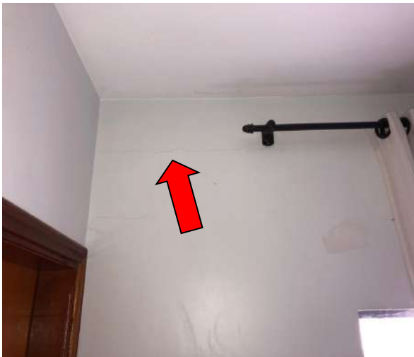
Figura 17. Fissura na parede do apartamento.
