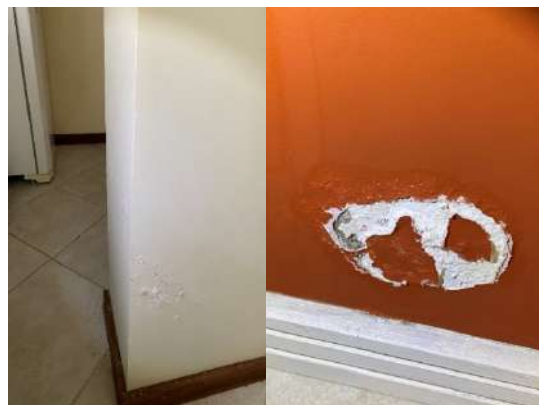
Figura 13. (a) Pintura danificada; (b) Dano no revestimento.
