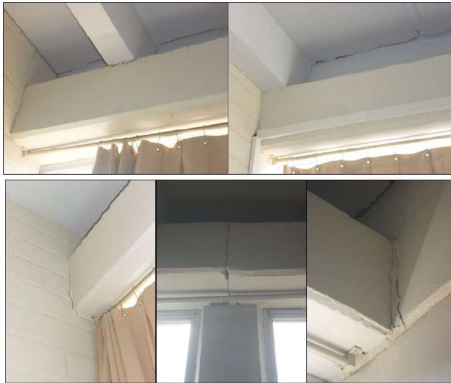
Figura 5: Fissura no encontro dos elementos (autoria própria)
