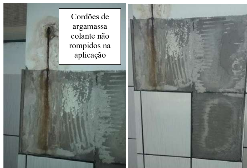
Figura 10. Destacamento do revestimento cerâmico pela presença de umidade proveniente de infiltrações, bem como registro da má aplicação do revestimento na etapa de execução.
