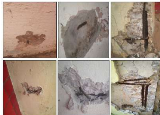
Figura 3.16. Presença de Corrosão nos pilares.
