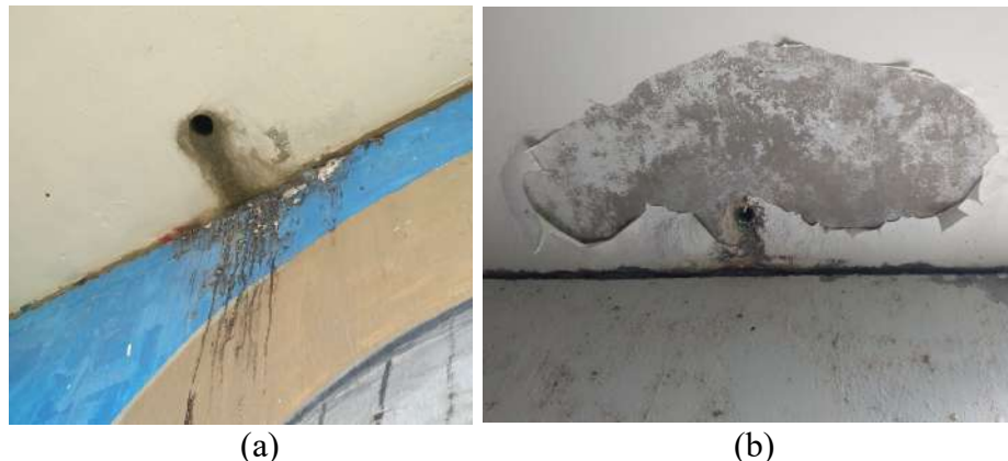
Figura 3. Vista da laje inferior da seção caixão com: manchas (a) e infiltração (b).
