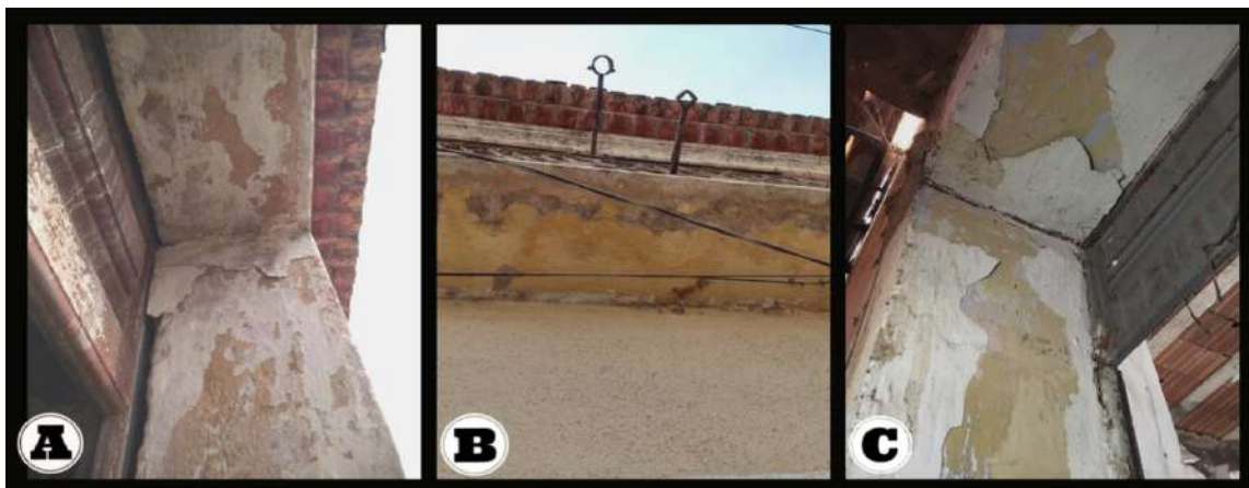
Figura 4. Descascamento em: (A) e (C) Portais das portas e (B) Sacada (Autor, 2021).
