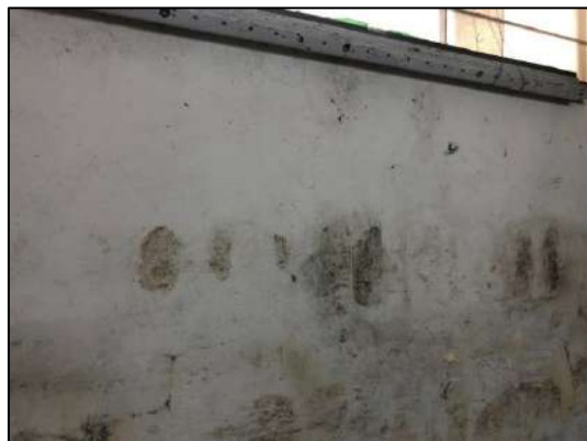
Figura 8 - Fissuras, manchamento e mofo em parede do subsolo. Fonte: (Autoria própria, 2020)
