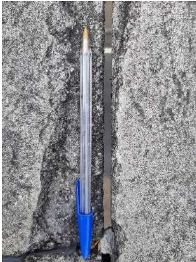
Figura 24: Desgaste do material da junta (Fi = 4).
