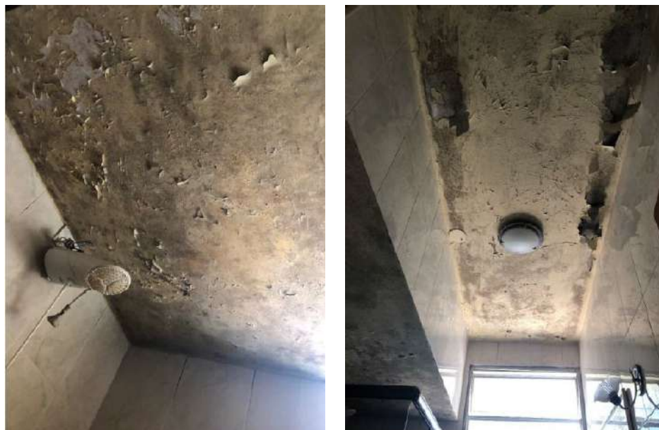
Figura 2. Surgimento de mofo e destacamento da pintura devido ao intenso contato com o vapor quente com a superfície fria do teto, localizado em uma residência em Ouro Preto, MG (Fonte: Autora).
