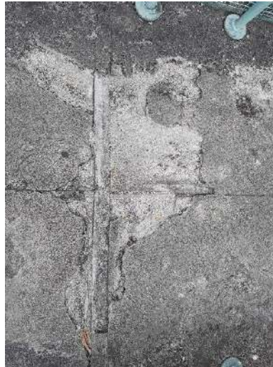
Figura 25: Desplacamento de do tabuleiro (Fi = 3).
