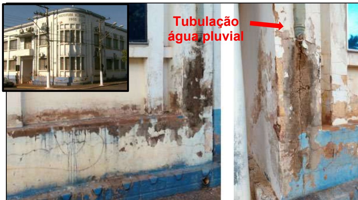
Figura 2. Manchas de bolor e mofo - Prefeitura Municipal de Viradouro/SP
