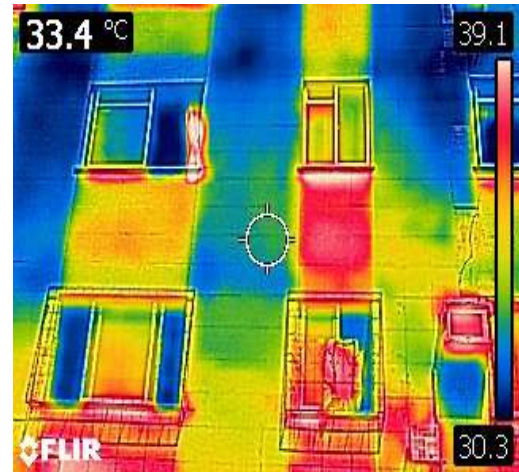
Figura 8 - Fachada Norte – Imagem termográfica
