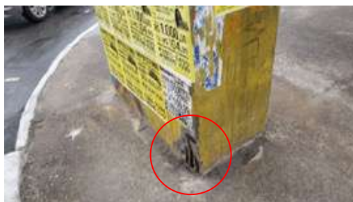
Figura 8 – Armadura exposta no Pilar 5
