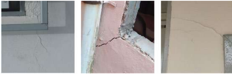
Figura 4. Fissuração por concentração de tensões nas esquadrias
