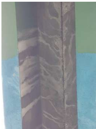
Figura 28: Eflorescência (Fi = 2) e manchas (Fi = 1).
