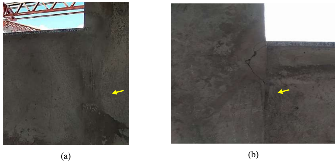
Figura 6. Trincas e manchas de fluxo de água no peitoril da janela (a) e (b).
