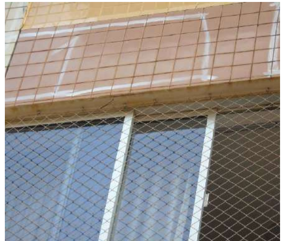
Figura 7: Corrosão em verga na fachada noroeste do Bloco B.
