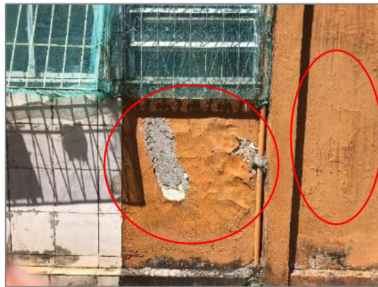
Figura 20 - Destacamento da pintura, Edifício B
