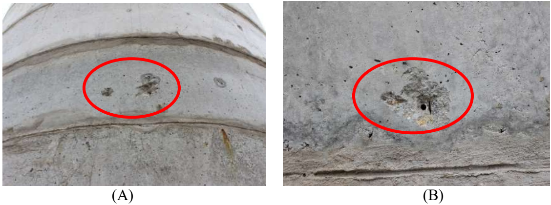
Figura 07. Destacamentos na estrutura do Reservatório 1. Fonte: Autor (2017).
