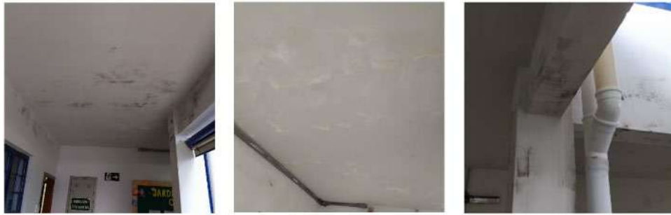
Figura 6. Infiltração por reabilitação inadequada em cobertura
