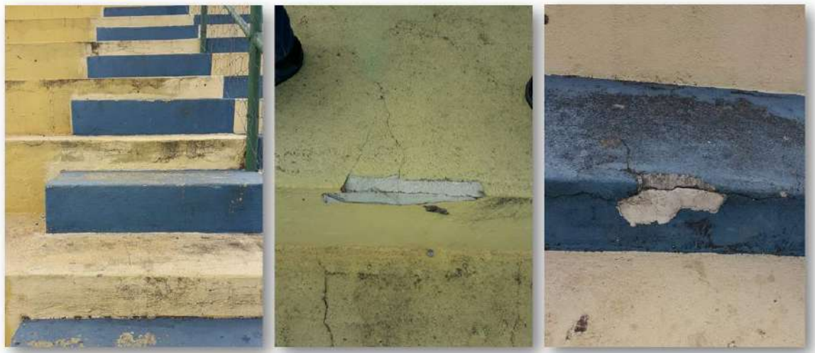
Figura 16. Sujidades, manchamentos e pequenos desprendimentos de argamassa na arquibancada do estádio. Fonte: Autor: (2020).
