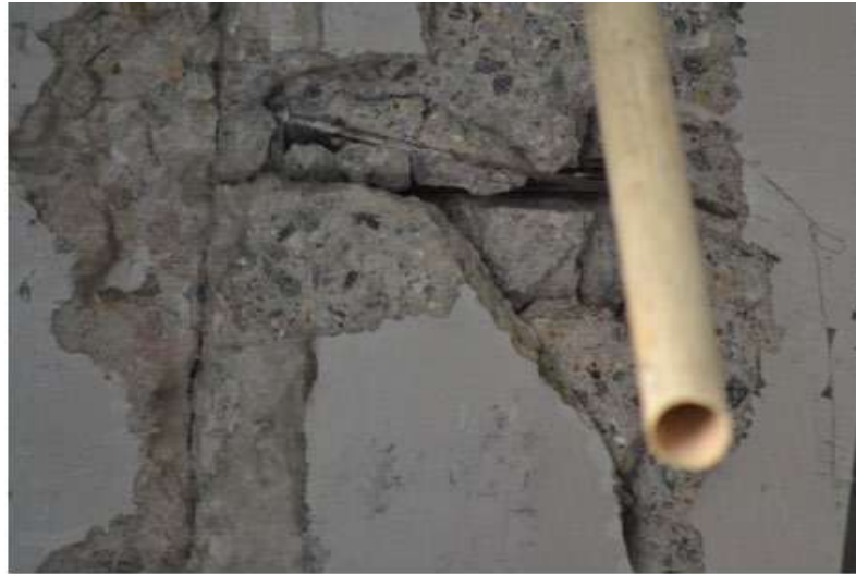
Figura 8. Outro ponto da laje com armadura sem cobertura e com indicio de corrosão.
