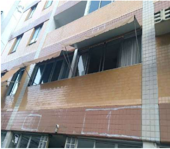
Figura 4: Marcação de som cavo na fachada noroeste do Bloco A.
