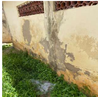
Figura 11: Degradação da parede
