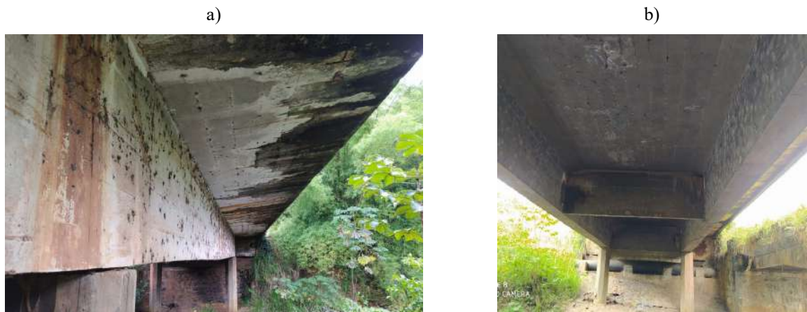
Figura 6. Manchas a) vista lateral, das vigas principais e lajes, b) vista inferior da laje (mancha esbranquiçada) e vigas transversais (mancha escura).
