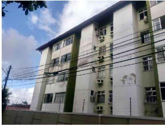
Figura 3. Destacamento da pintura de revestimento da fachada externa. Fonte: própria, 2019.
