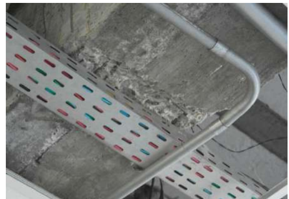
Figura 9 - Indícios de ocorrência de Corrosão de Armaduras. Fonte: O autor (2019).
