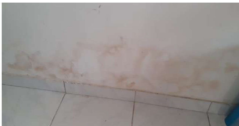
Figura 3. Manchas causadas pela ascensão de água por capilaridade.
