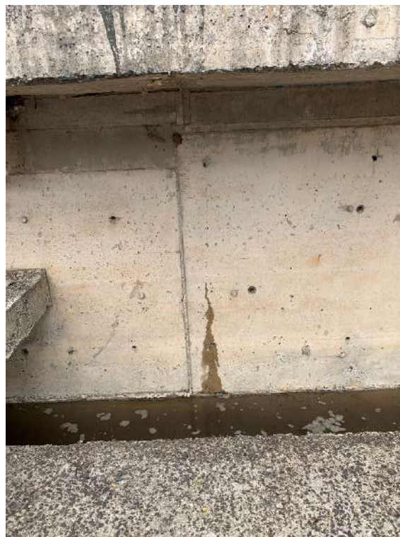
Vazamento de água pela fissura
