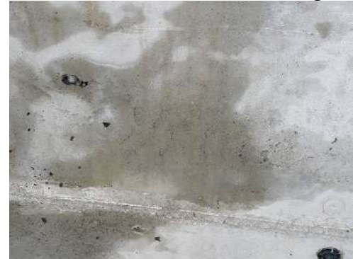
Figura 7. Manchamento observado na parede e falha de concretagem.
