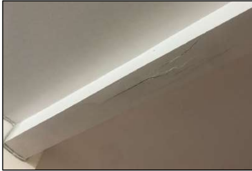
Figura 2 - Fissuras geométricas longitudinais em fundo de viga do subsolo. Fonte: (Autoria própria, 2020)
