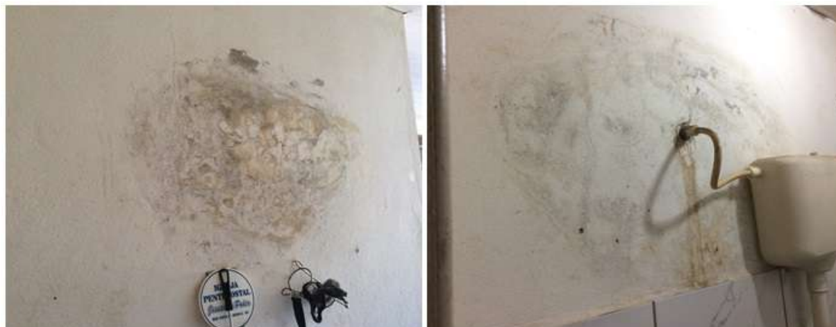
Figura 8: Exemplos de vazamentos de tubulação hidráulica nas residências.
