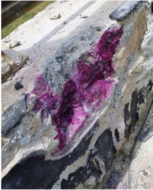
Figura 7 - Parede do canal de efluente tratado, concreto superficial degradado com armadura preservada, envolta por concreto com pH superior a 8,5.
