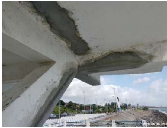
Figura 10. Recuperação da corrosão na armadura das lajes lisas da edificação que era bastante acentuada. Fonte: própria, 2018.
