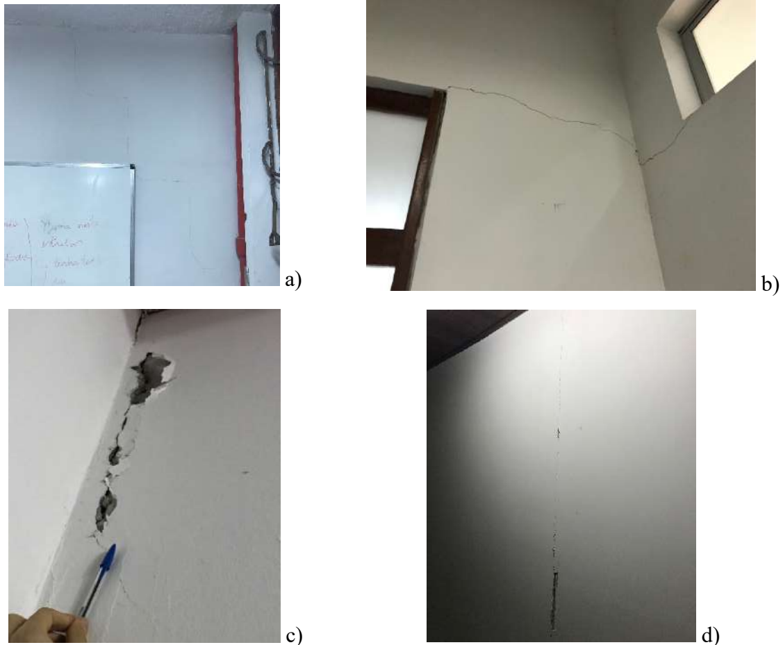
Figura 8 – Principais manifestações patológicas nas edificações da UFES (fissuras), em 2021.
