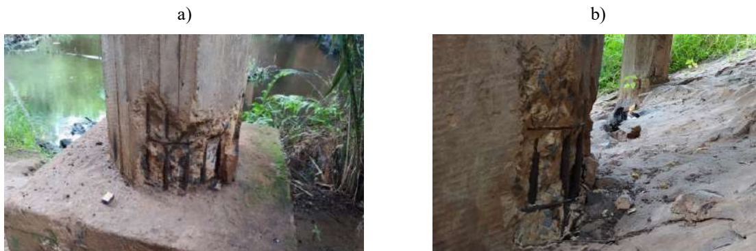
Figura 2- Corrosão de armaduras a) e b) armadura exposta e com aspecto corroído.
