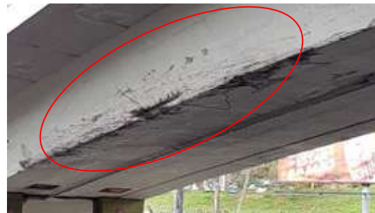
Figura 13 – Rompimento de armadura Vão 3
