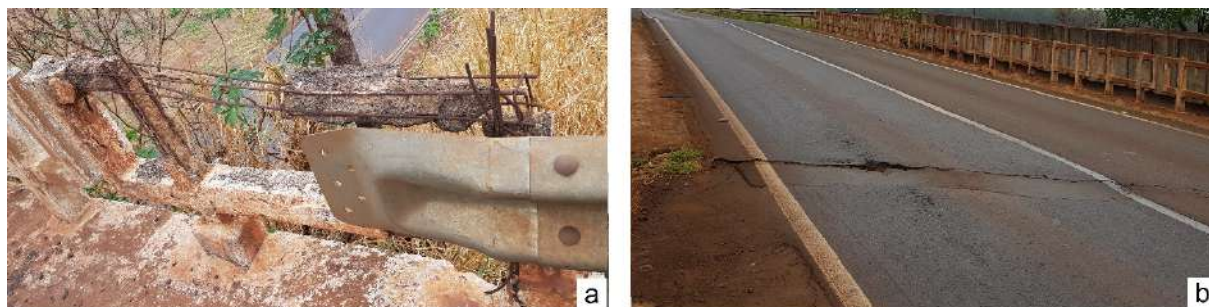
Figura 2 – (a) Corrosão da armadura do guarda-corpo (b) problemas na plataforma do tabuleiro
