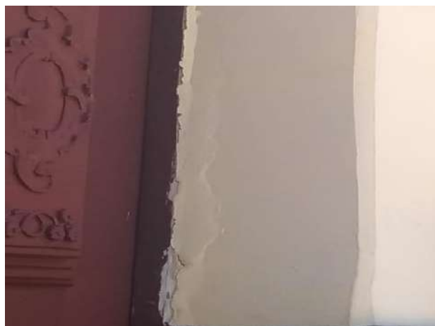
Figura 5- Parte superior da parede próxima à porta da entrada principal. Patologia: Empolamento Fonte – Os autores, 2021
