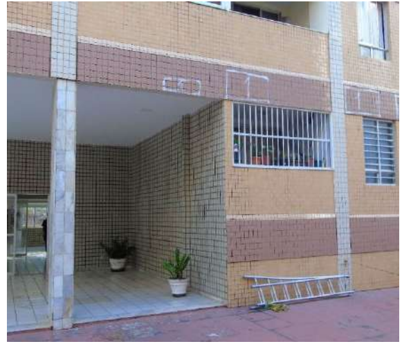
Figura 9: Marcações de som cavo na fachada sudeste do Bloco A.
