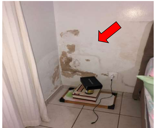
Figura 18. Fissura intensificada pela umidade.
