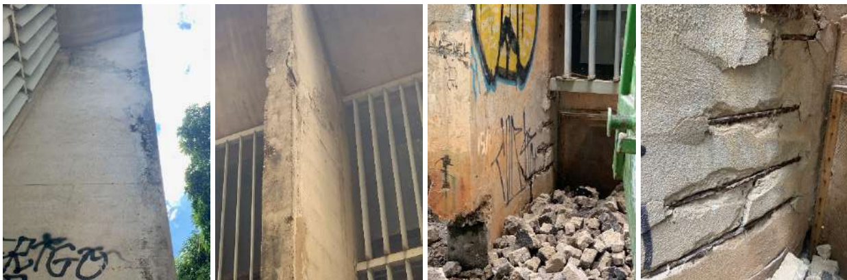
Figura 11 - Pilar 17: ninhos de concretagem, bolor/manchas de umidade e corrosão das armaduras.
