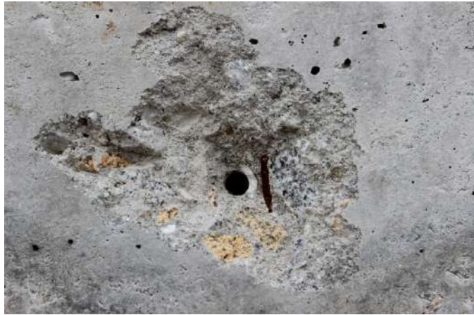
Figura 09. Início de corrosão na estrutura do Reservatório 1. Fonte: Autor (2017).
