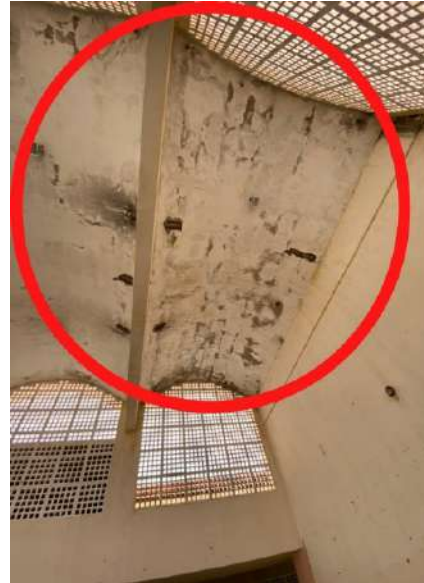
Figura 3: Infiltração na laje
