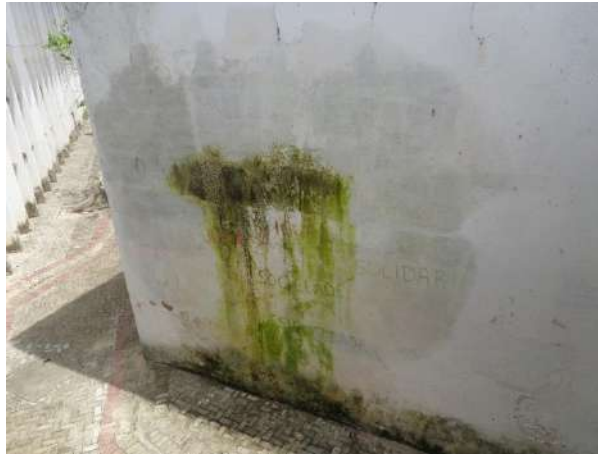
Figura 5. Parede com umidade em um dos blocos. Fonte: própria, 2021.
