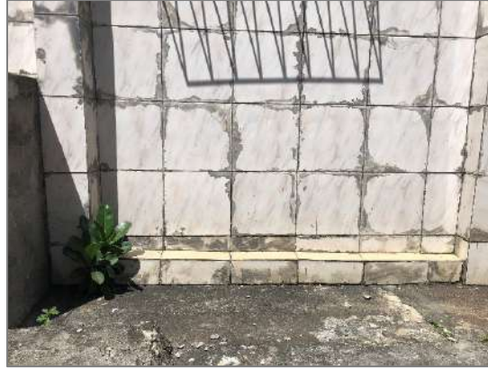
Figura 21 - Manchas na fachada posterior, Edifício B
