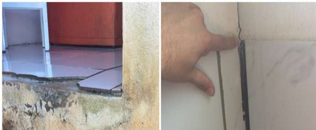
Figura 6: Exemplo de descolamento de cerâmica
