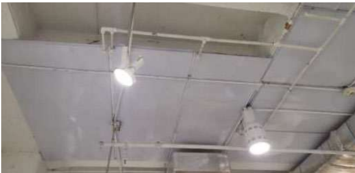
Figura 4: Bandejas metálicas para recolección de agua proveniente por filtración
