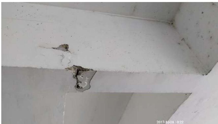
Figura 12. Corrosão na armadura de uma viga de concreto armado. Fonte: própria, 2017.
