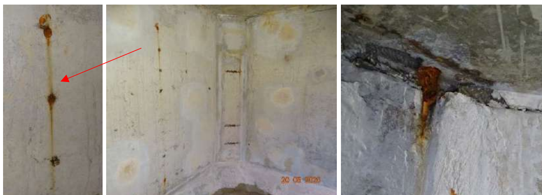
Figura 5. Exemplo de armadura aparente na mísula e de pontos de corrosão (bolhas) de arames nas vigas parede.
