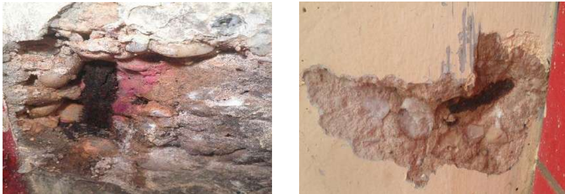
Figura 3.4. Trechos com carbonatação na quadra do ginásio.
