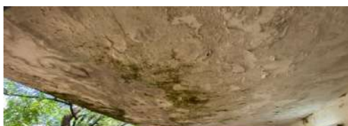
Figura 7: Mofo e degradação da pintura no teto
