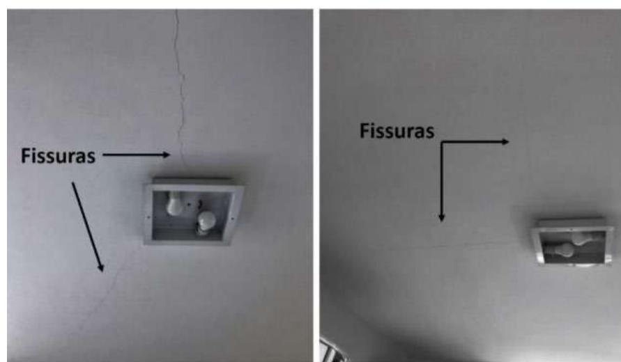
Figura 3. Fissuras na laje
