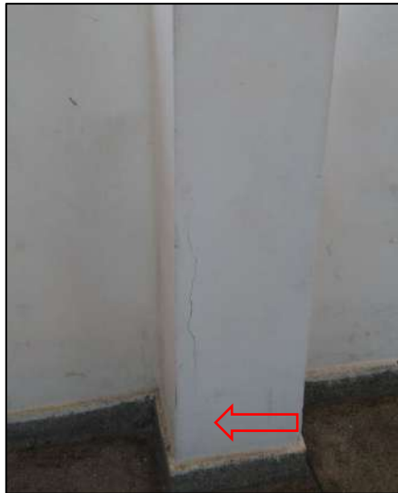
Figura 1 - Fissura geométrica vertical em pilar do 4º pavimento. Fonte: (Autoria própria, 2020)
