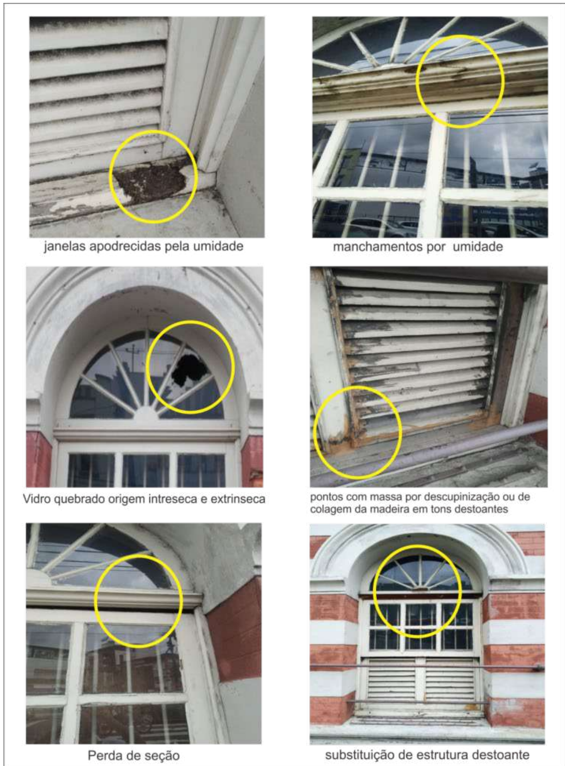
Figura 3. Levantamento fotográfico das patologias nas esquadrias do CCBM.
