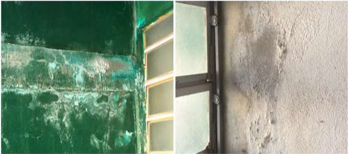
Figura 5: Exemplo de eflorescências nas residências analisadas.
