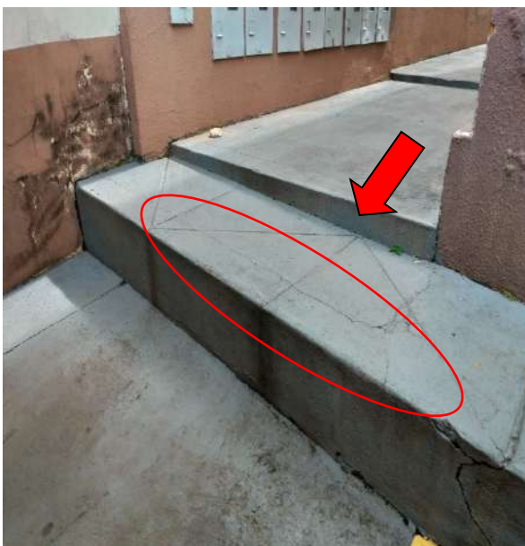
Figura 19. Fissuras de possível recalque.
