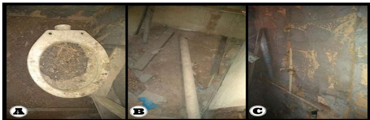
Figura 10: Na parte hidrossanitária em: (A) vaso sanitário, (B) Tubulação do Vaso sanitário e (C) Tubulação de chuveiro (Autor, 2021).
