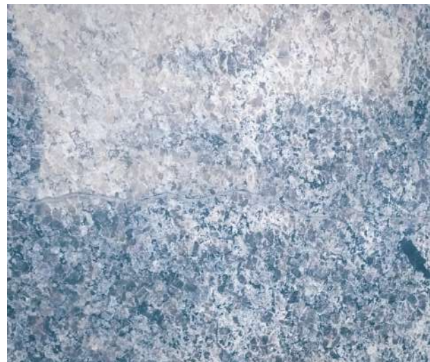
Figura 8- Região inferior da parede, no granito. Lado esquerdo as três portas principais. Patologia: Fissura Fonte: Os autores, 2021.
