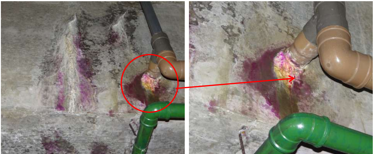
Figura 15 – Detalhe da infiltração no reservatório e detalhe da infiltração no reservatório.
