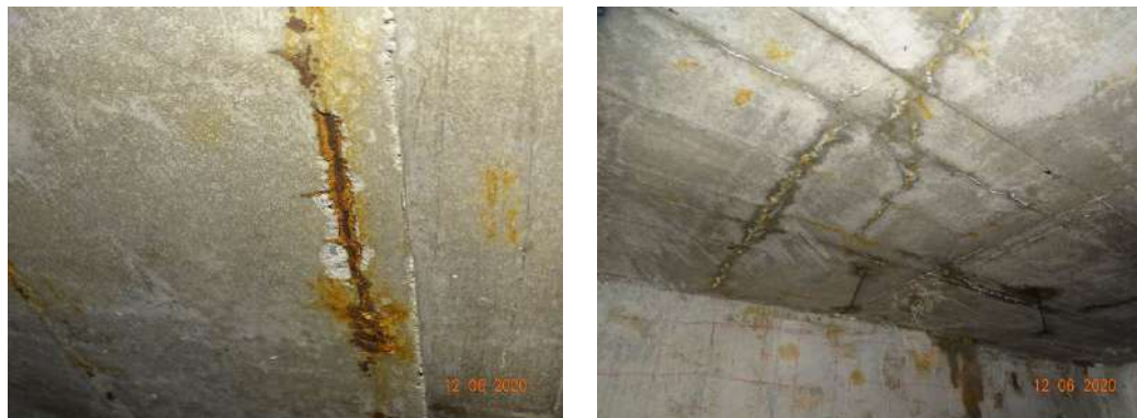
Figura 4. Armaduras em processo de corrosão e eflorescências molhadas, pela infiltração de água que ocorre na laje superior (face superior ainda sem impermeabilização).
