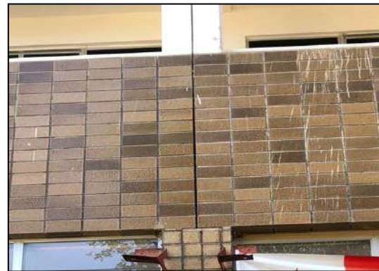
Figura 5 - Ausência de continuidade e vedação da junta de movimentação estrutural. Fonte: (Autoria própria, 2020)
