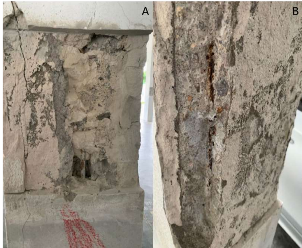
Figura 6. Degradação da área recuperada em 2016, com aplicação de técnicas e materiais não eficiente.
