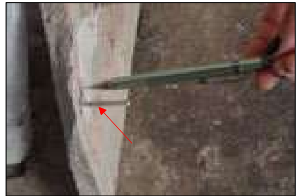
Figura 16 – Antigos arames de fixação
