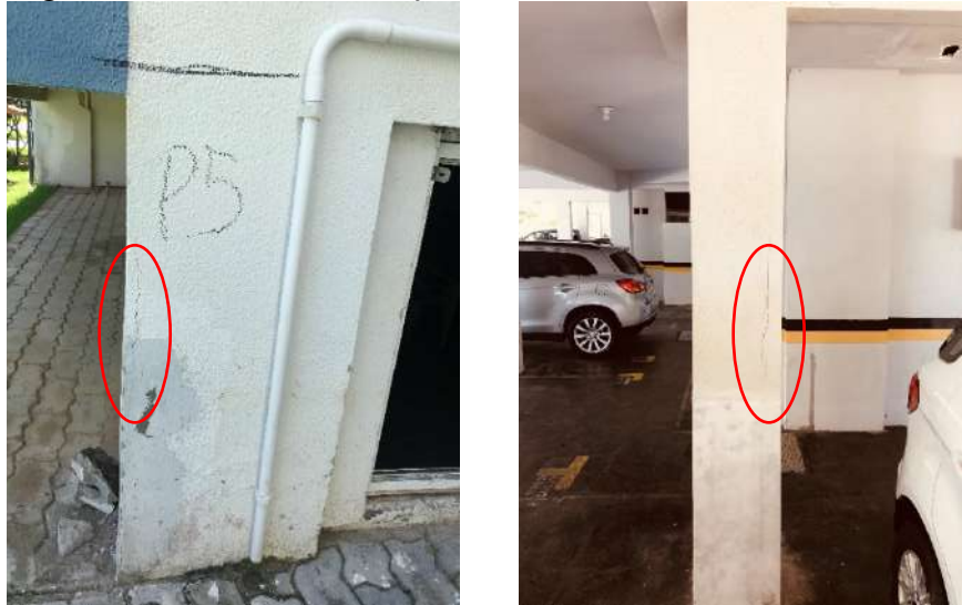
Figura 3. Pilares com indicações de corrosão de armadura.
