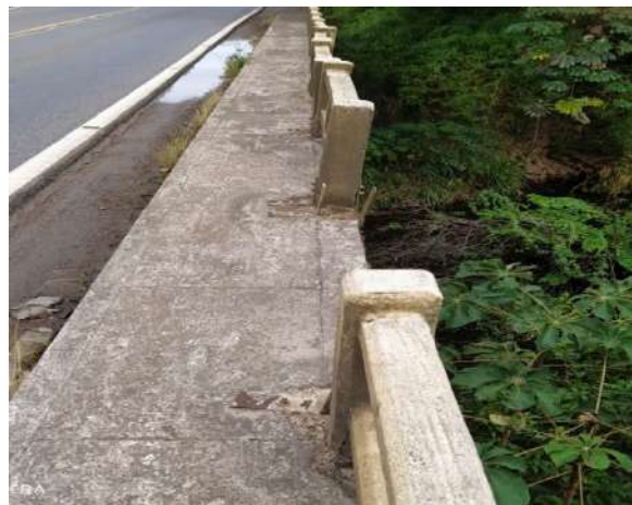
Figura 8. Falha no guarda-corpo.
