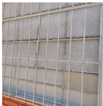
Figura 14. Esquadria com pintura sobre sujeira
