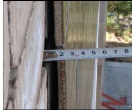
Figura 6 - Desplacamento do revestimento em detalhe. Fonte: (Autoria própria, 2020)
