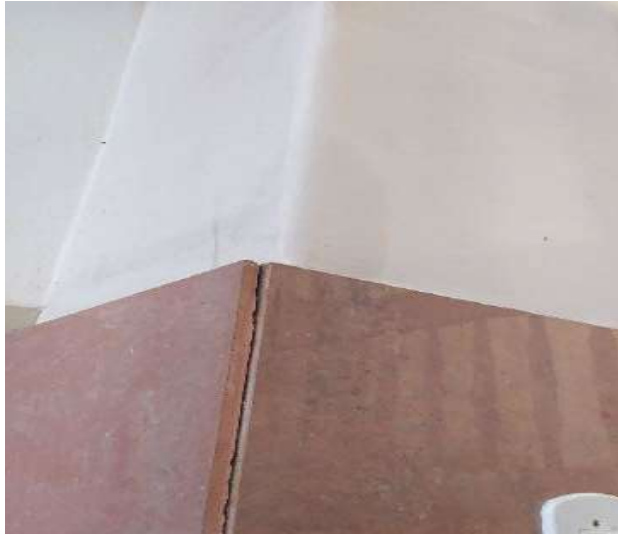
Figura 15- Parede próxima a entrada principal e à entrada do local de batismo. Patologia: infiltração Fonte: Os autores, 2021.
