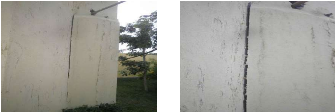
Figura 3.10. Descolamento do revestimento da caixa d'água.
