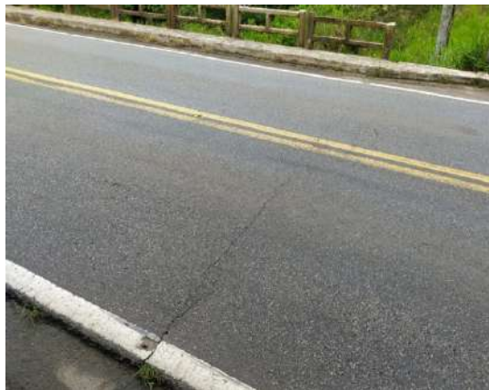
Figura 4. Trincas no pavimento asfáltico.
