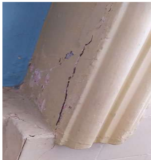
Figura 21- Parede entre os altares de santuários. Lado esquerdo. Patologia: Empolamento da pintura. Fonte: Os autores, 2021.
