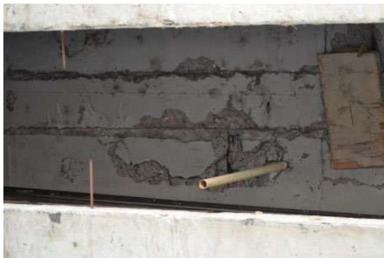
Figura 6. Laje com armadura sem cobertura e com indicio de corrosão.
