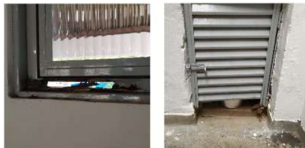
Figura 19. Esquadrias com defeitos de corrosão
