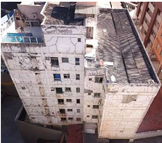
Figura 14: Vista da fachada nordeste do Bloco B com fissuras, corrosão e deslocamento.
