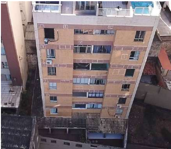
Figura 10: Vista da fachada sudeste do Bloco B com marcações de som cavo e revestimento solto.
