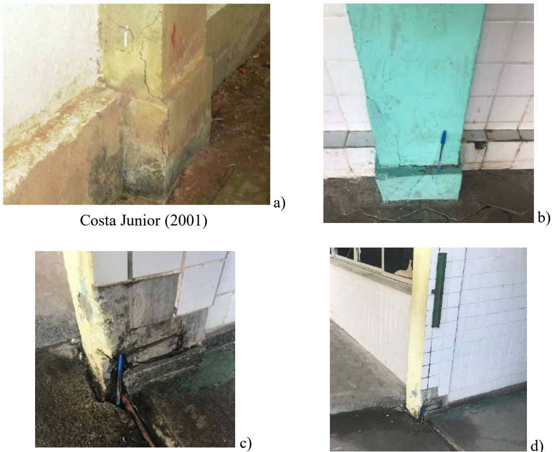
Figura 11 – Análise de 2001 (Figura a) e atual das bases de pilar na escola de 1º grau (Figura b, c, d), em 2021.
