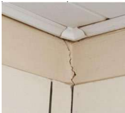
Figura 6. Trincas em parede de alvenaria
