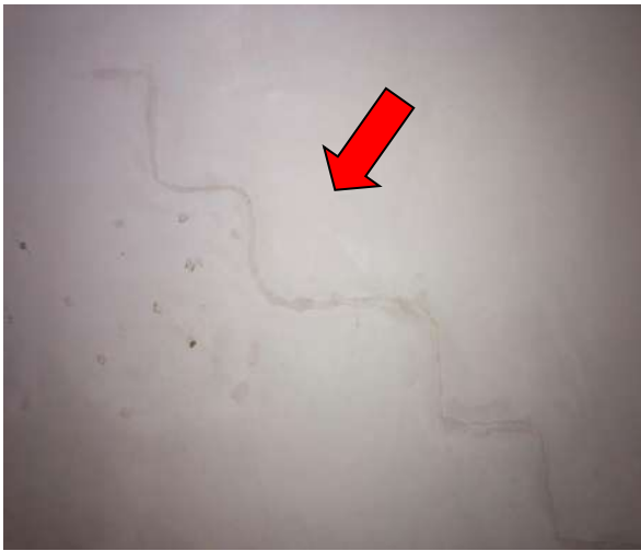
Figura 15. Fissura na parede do apartamento.
