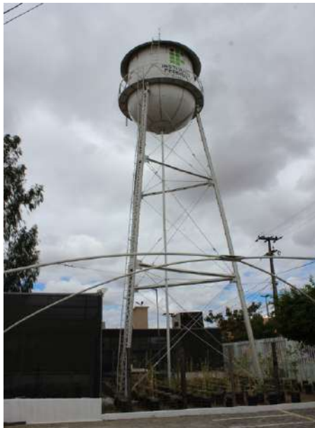
Figura 10. Reservatório 2-Caixa d'água metálica IFCE. Fonte: Autor (2017).
