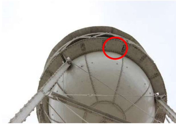
Figura 11. Ponto com corrosão na estrutura do Reservatório 2. Fonte: Autor (2017).
