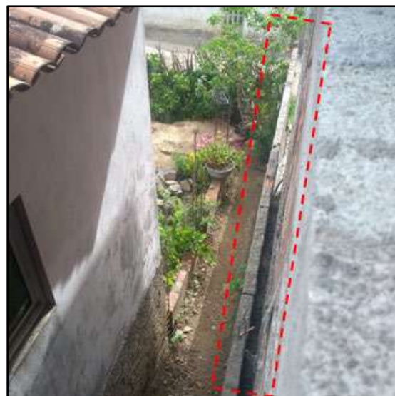
Figura 3: Ausência de recuo lateral
