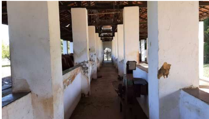
Figura 9. Colocação de um novo reboco e novas manifestações patológicas apareceram, como o destacamento da pintura. Fonte: própria, 2021.
