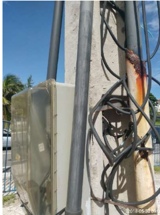
Figura 12. Corrosão da tubulação de aço fixada em um poste de concreto armado. Fonte: própria, 2018.
