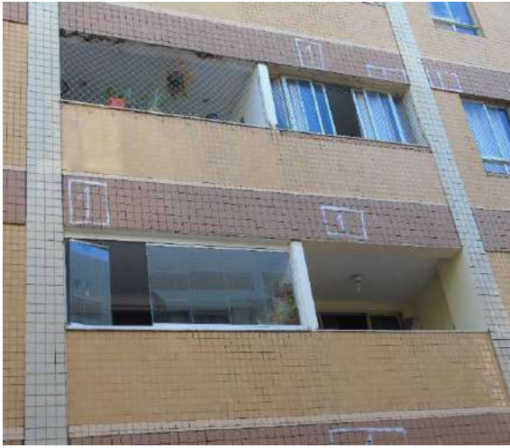
Figura 8: Marcações de som cavo na fachada sudeste do Bloco A.
