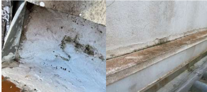
Figura 11. (a) Falha na calha e impermeabilização; (b) Formação de fungos.
