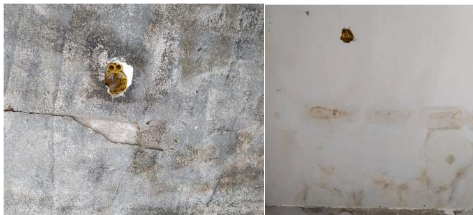
Figura 11. Laje com sinais de umidade e bolor, descascamento do revestimento e detalhe da caixa de passagem elétrica.
