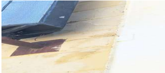
Figura 9- Parede da vista frontal da fachada. Lado esquerdo. Patologia: Empolamento da pintura e infiltração.
