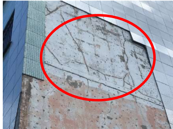
Figura 4 - Área de Fissurações
