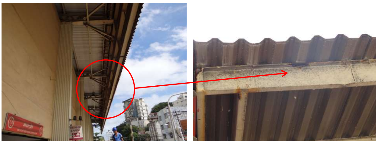
Figura 3 – Vista da estrutura metálica da fachada e Detalhe da corrosão na estrutura metálica da fachada
