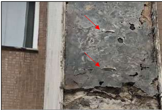
Figura 15 – Antiga fixação da placa
