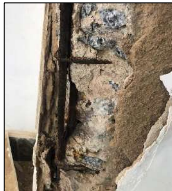
Figura 4 - Detalhe após retirada do reboco do pilar da figura 4. Fonte: (Autoria própria, 2020)
