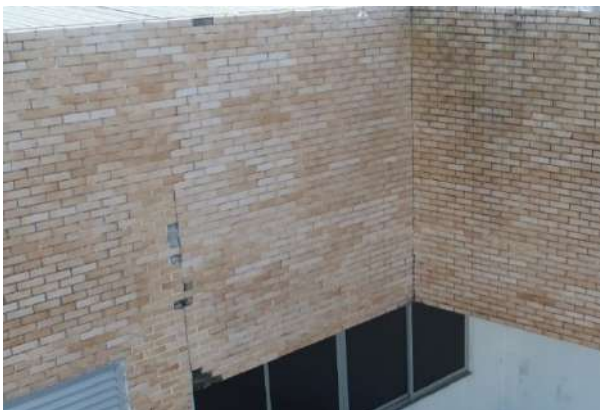
Figura 8 - Destacamento em Fachada Localizada na Ala C. Fonte: O autor (2019).
