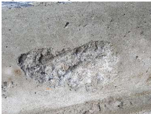
Figura 6. Deslocamento do concreto.
