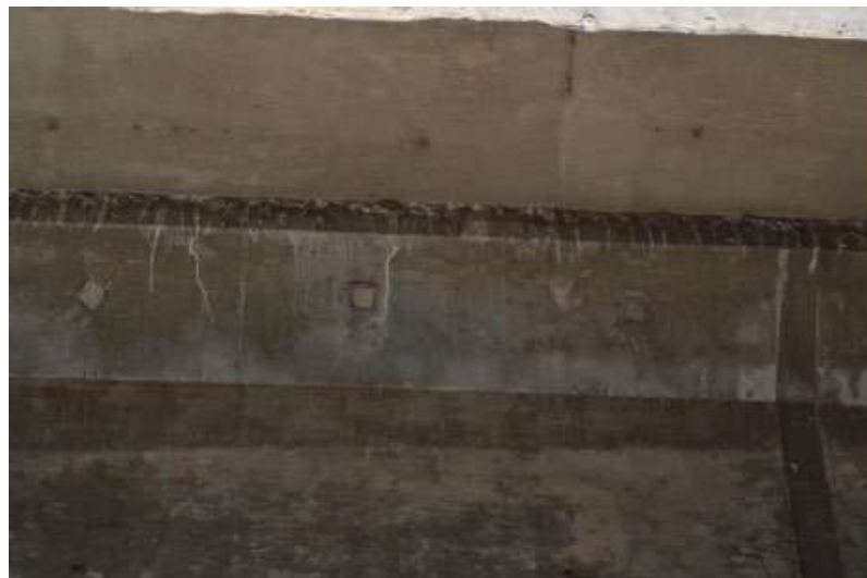
Figura 9. Trecho da laje com indicação de eflorescência.
