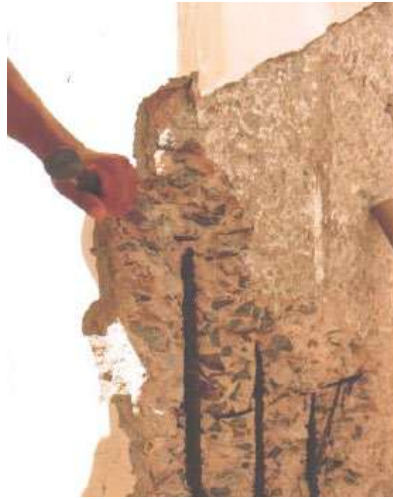
Figura 02. Corrosão em pilar de reservatório de concreto armado. Fonte: Borges (2008).
