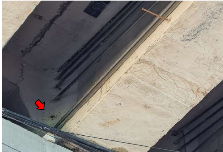
Figura 15. Cabo de protensão rompido na zona de encunhamento.
