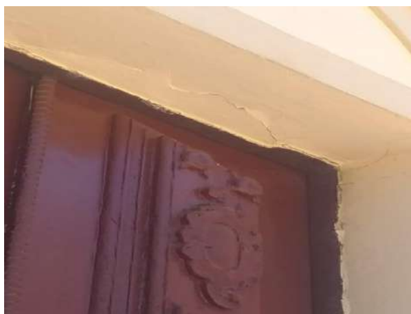
Figura 4- Parte superior da parede próxima à porta. Patologia: fissura Fonte – Os autores, 2021.
