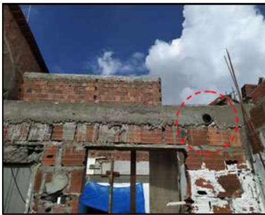
Figura 9: Furo na viga, feito para passagem das instalações hidráulicas.
