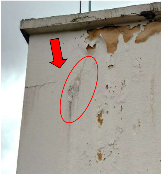
Figura 1. Manchas brancas de eflorescência.
