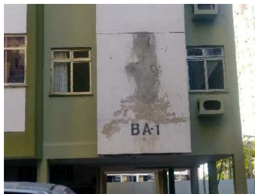
Figura 2. Recuperação e retirada da manifestação patológica da umidade ocasionada pelo vazamento da tubulação. Fonte: própria, 2019.
