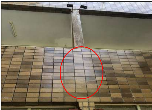
Figura 6 - Revestimento abaixo do pilar apresenta som cavo. Fonte: (Autoria própria, 2020)
