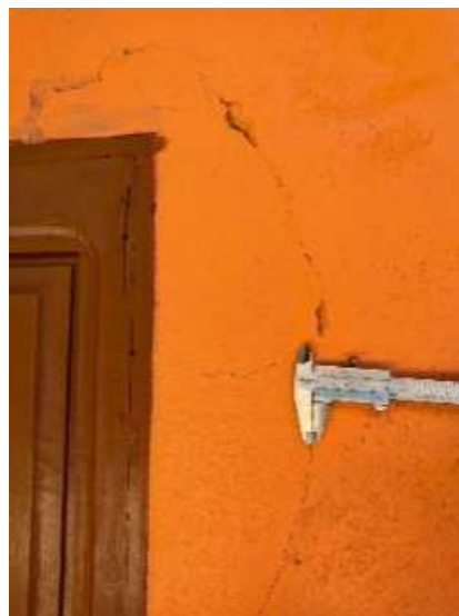
Figura 5- Presença de patologia: (A) fissuras inclinadas na parte superior da janela.
