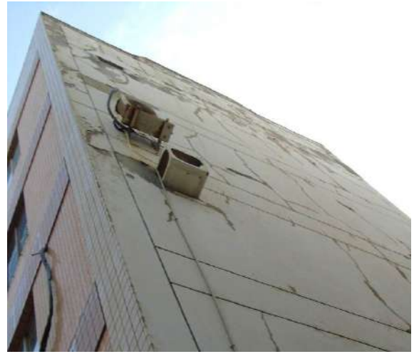
Figura 13: Fissuras na fachada nordeste do Bloco A.
