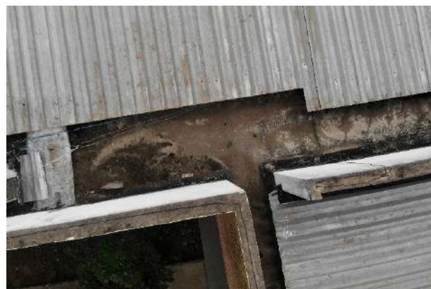
Figura 11 - Degradação da Impermeabilização das Calhas. Fonte: O autor (2019).
