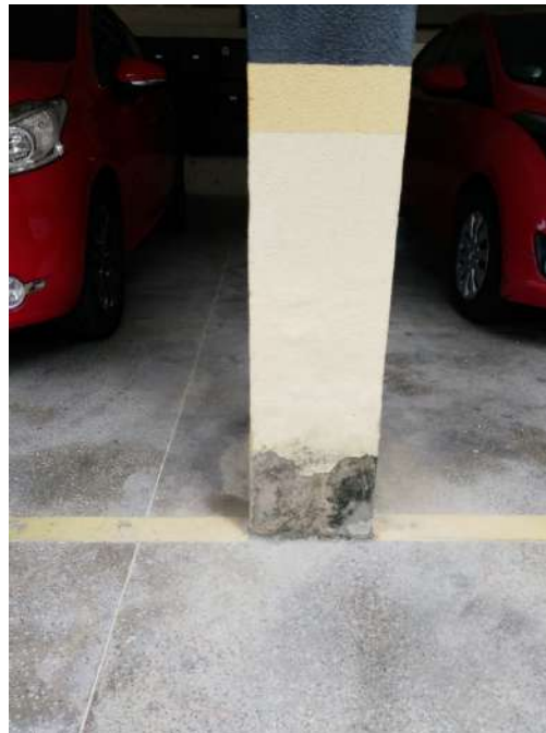
Figura 16. Destacamento da pintura, como também bolor na base de um dos pilares devido a umidade. Fonte: própria, 2019.
