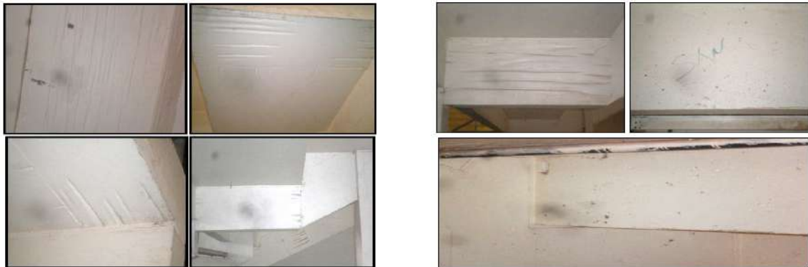
Figura 3.15. Deformação na parte inferior das arquibancadas e nas vigas.
