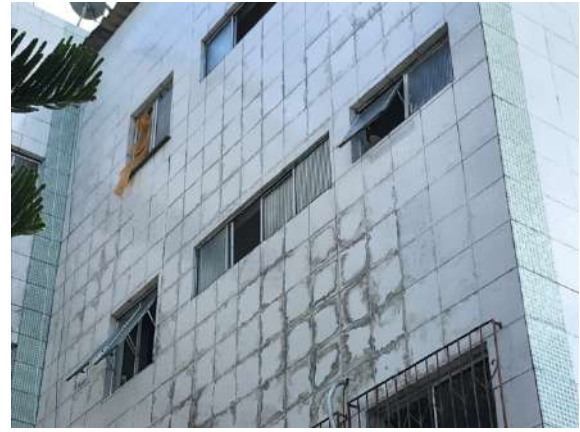
Figura 6 - Carbonatação na área dos rejuntas
