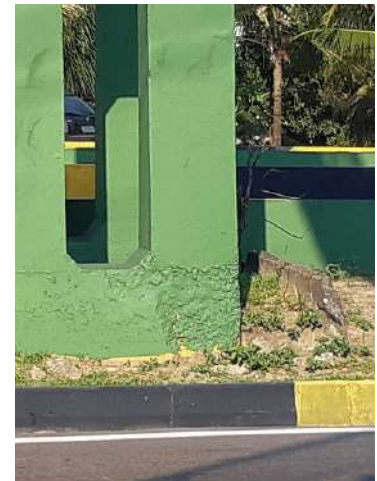
Figura 7: Falha de concretagem. (Fi = 2).
