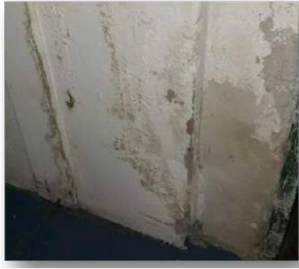
Figura 14. Manchamentos relativos à presença de umidade em pilares internos do estádio. Fonte: Autor (2020).
