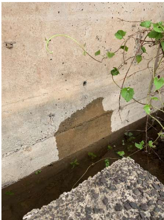
Vazamento na segregação do concreto
