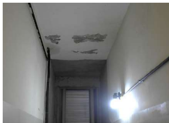
Figura 13 – Manchas de umidade na laje do shaft - Ala D. Fonte: O autor (2019).
