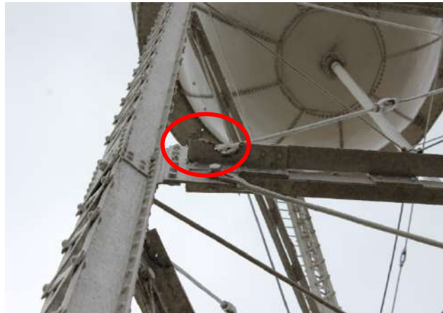
Figura 12. Outro ponto na estrutura do Reservatório 2 com corrosão. Fonte: Autor (2017).
