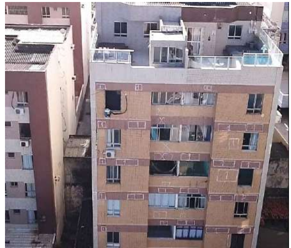
Figura 11: Vista da fachada sudeste do Bloco B com marcações de som cavo e revestimento solto.
