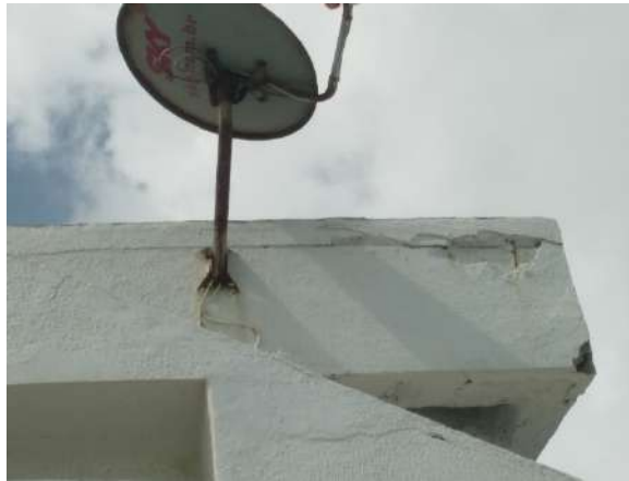
Figura 4. Corrosão na armadura da viga lateral da igreja com destacamento de parte do concreto (cobrimento). Fonte: própria, 2019.
