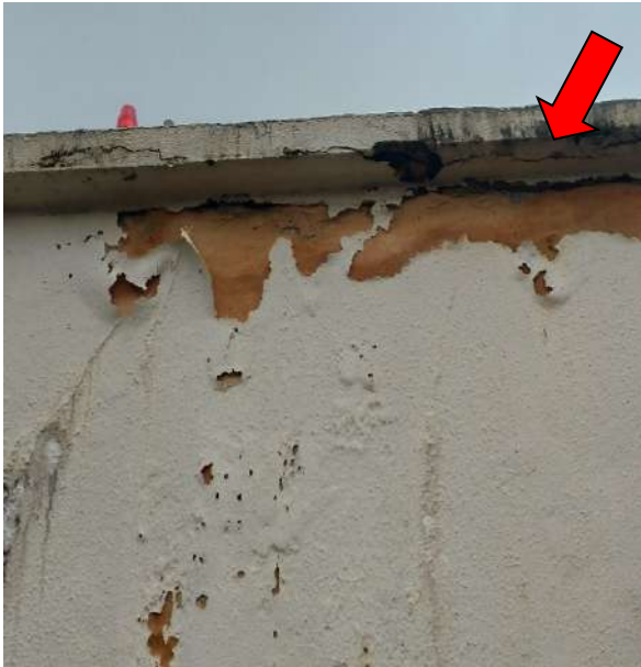
Figura 13. Destacamento da pintura.
