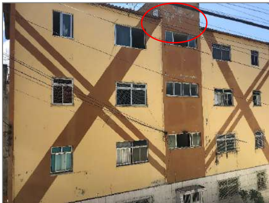
Figura 8 - Descoloração na fachada frontal, Edifício B
