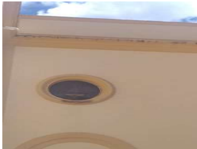
Figura 10- Parede da parte lateral da fachada, acima da porta secundária. Lado direito. Patologia: Manchas de bolor.
