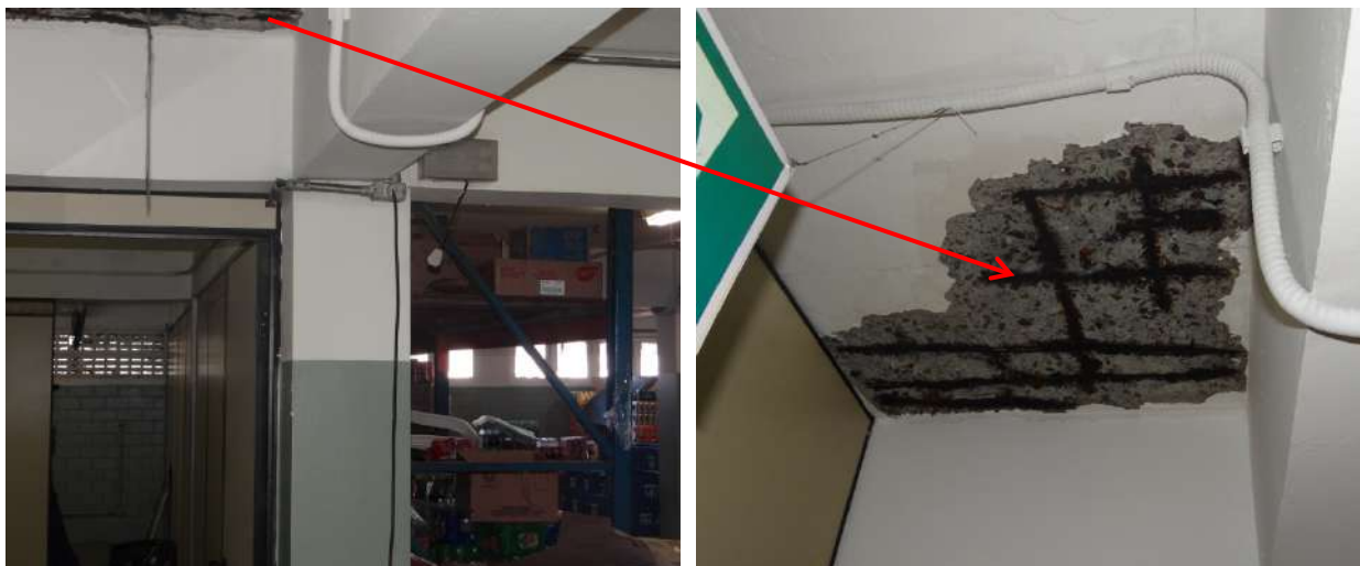
Figura 122 – Vista do processo de corrosão e deslocamento da laje (trecho 1) e detalhe 1 do processo de corrosão e deslocamento da laje.
