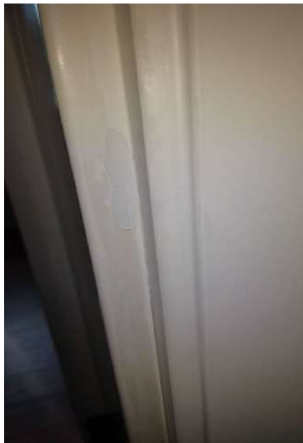
Figura 5: Descascamento de pintura em esquadrias de madeira
