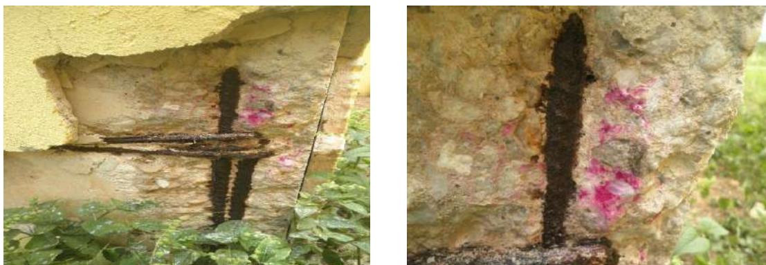
Figura 3.5. Trechos com carbonatação na caixa d'água.
