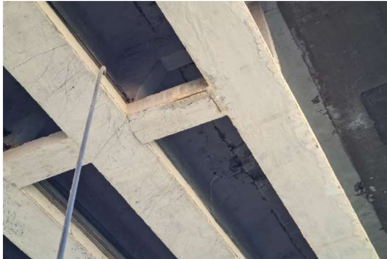
Figura 10. Trecho da laje com indicação de eflorescência.
