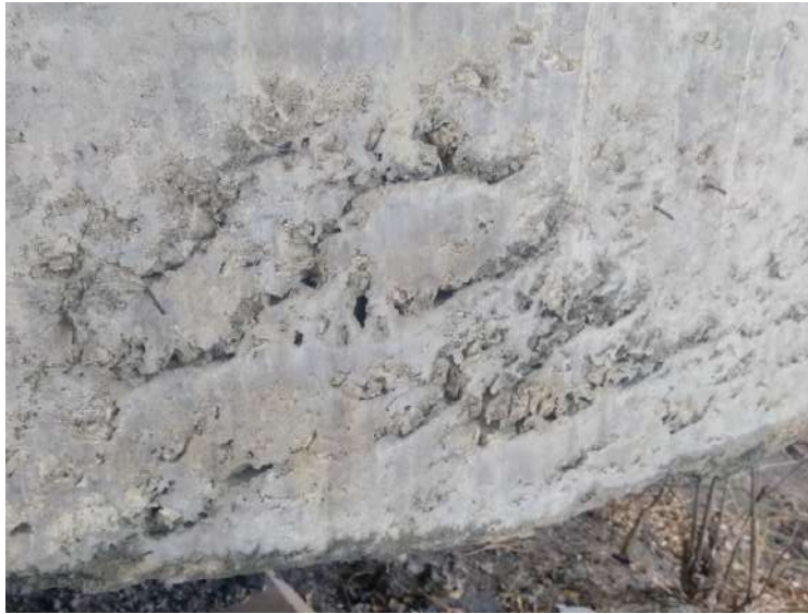
Figura 4. Viga em concreto armado cheia de vazios de concretagem (bicheiras). Fonte: própria, 2019.
