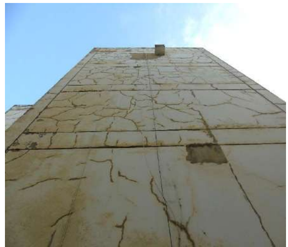
Figura 15: Fissuras na fachada nordeste do Bloco B.
