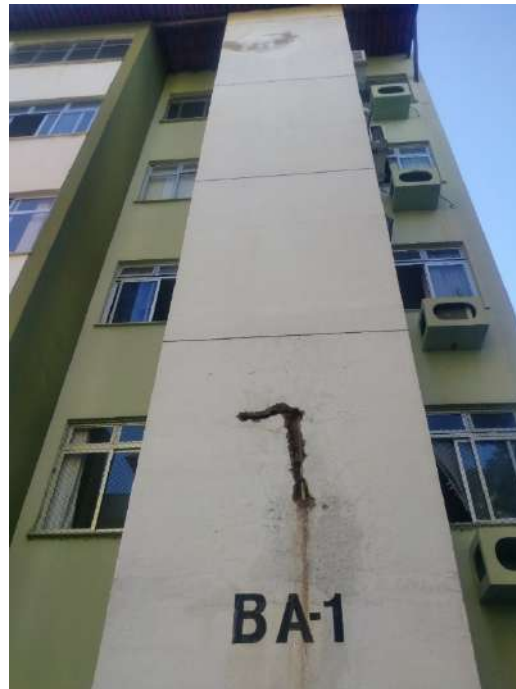
Figura 1. Fissura na tubulação de água, acarretou uma grande umidade na parede (vedação). Fonte: própria, 2019.
