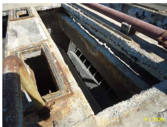
Figura 5 - Detalhe concreto degradado nas aberturas da laje do reator 1.
