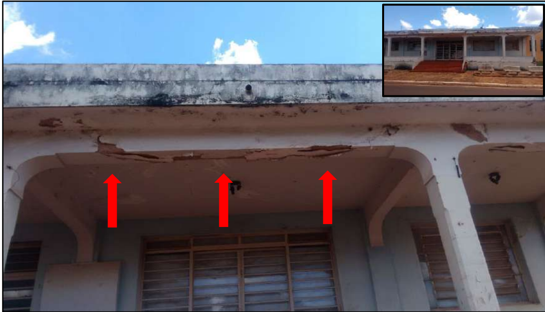
Figura1. Deterioração do reboco devido a infiltração - Centro Comunitário, salão de festas de Viradouro/SP.
