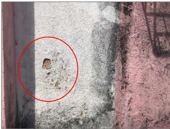
Figura 19 - Destacamento da pintura, Edifício A
