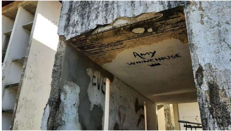
Figura 7. Alto grau da corrosão da armadura. Fonte: própria, 2021.
