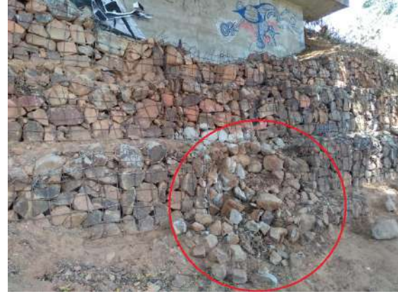
Figura 14. Desabamento de parte do muro de gabião.
