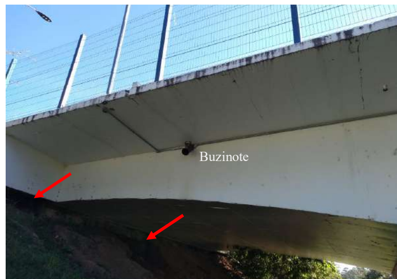
Figura 5. Vista lateral da ponte, com erosão no aterro da cabeceira devido à infiltração de água.
