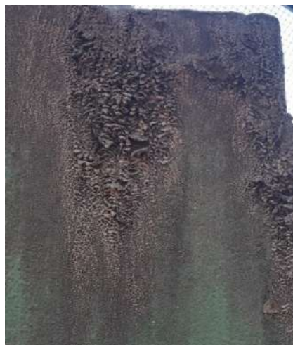
Figura 3: Manchas em estado avançado (Fi = 2).
