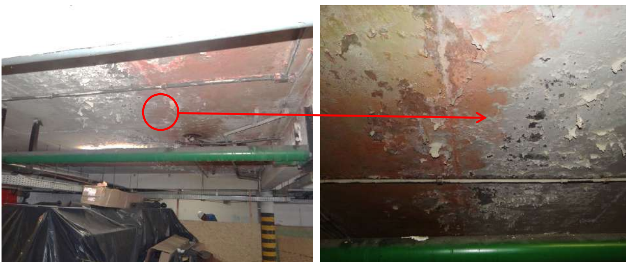
Figura 11 - Detalhe da desfragmentação da pintura da laje (abaixo)
