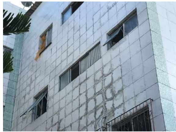
Figura 6 - Carbonatação na área dos rejantes
