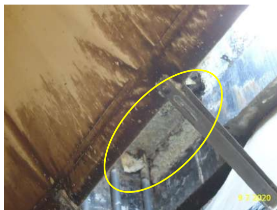
Figura 6 - Vista do concreto degradado sob a laje de cobertura do reator em detalhe, e vista da lona do separador trifásico e sistema de fixação.
