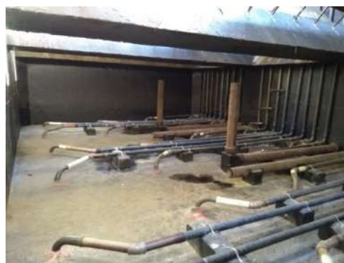
Figura 3 - Vista Interna do compartimento de digestão (região submersa) do reator UASB.
