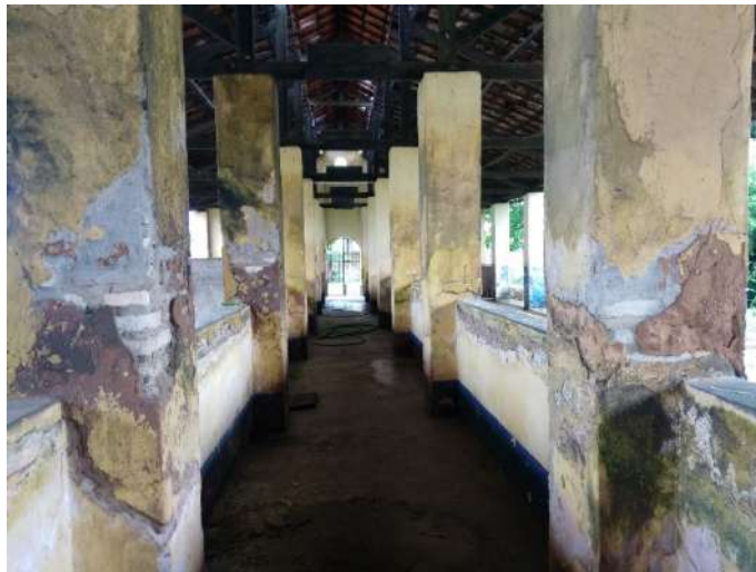
Figura 8. Pilares apresentando manifestações patológicas em alto grau, como o destacamento do reboco e mofo. Fonte: própria, 2021.
