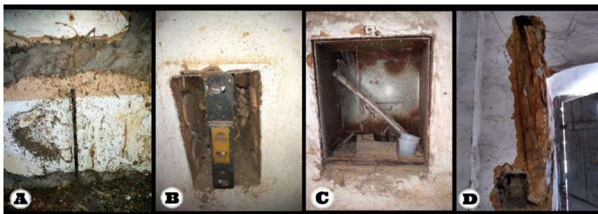
Figura 7. Deterioração em: (A) Fiação elétrica (B) Tomada (C) Caixa de distribuição. e (D) Fiação telefônica (Autor, 2021).
