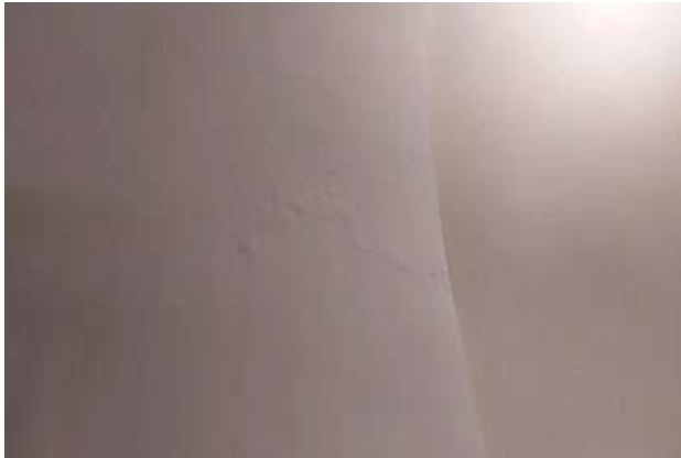
Figura 16- Parede da lateral esquerda do cômodo de batismo. Patologia: Empolamento da pintura e infiltração Fonte: Os autores, 2021.
