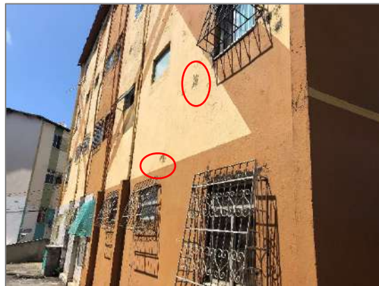
Figura 9 - Descoloração na fachada posterior, Edifício B
