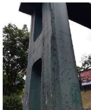
Figura 23: Falhas de concretagem (Fi = 1) e manchas em pilar (Fi = 1).
