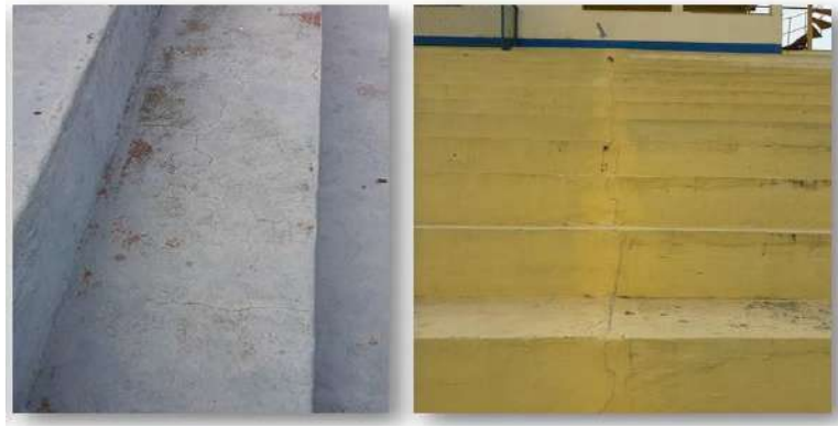
Figura 17. Fissuras mapeadas típicas de retração por secagem e juntas estruturais defeituosas ou mau executadas ao longo da arquibancada.
