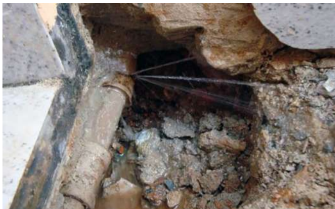
Figura 1. Vazamento localizado em tubulação embutida. Fonte: SAAE Salto/SP, 2021.
