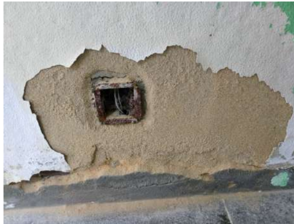
Figura 14. Destacamento da pintura e o deslocamento da argamassa de uma parede. Fonte: própria, 2018.
