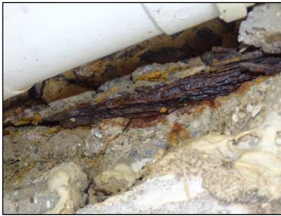
Figura 3 – Corrosão na viga V22
