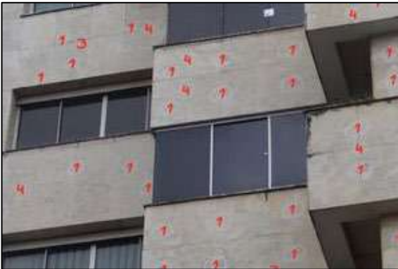
Figura 3 – Mapeamento de danos na fachada
