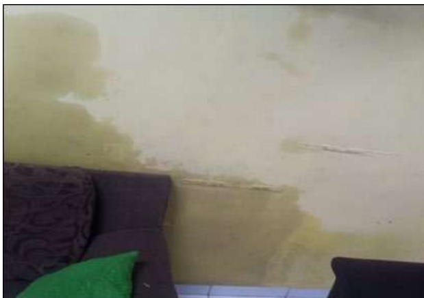
Figura 13: Infiltração da Sala
