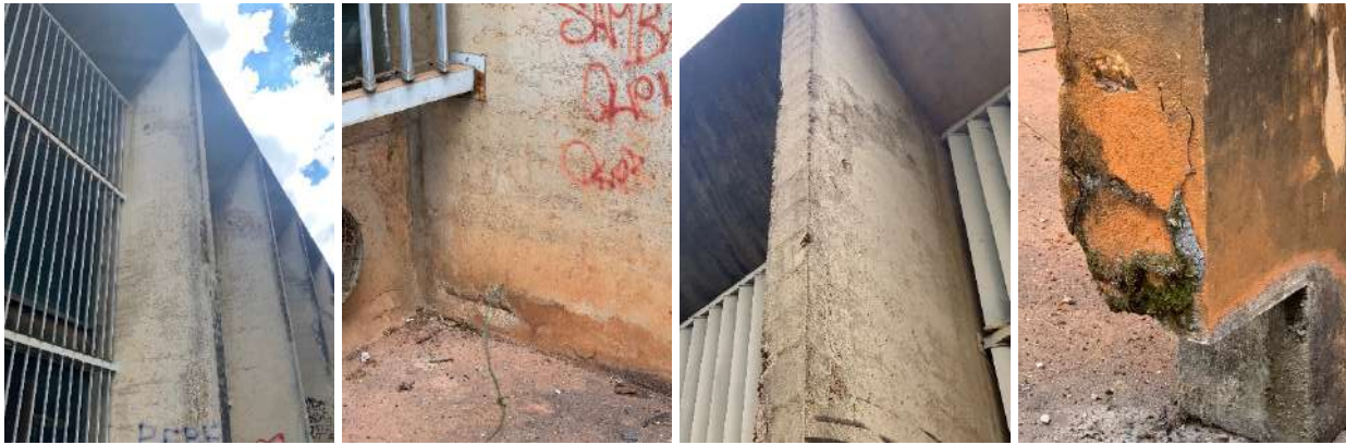
Figura 10 - Pilar 15: ninhos de concretagem, bolor/manchas de umidade e corrosão das armaduras.
