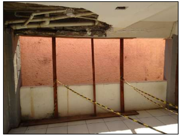
Figura 4 – Deslocamento e fissuras, V22
