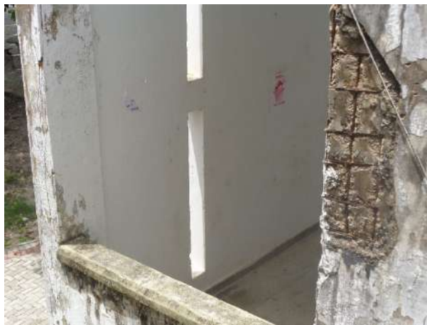
Figura 4. Corrosão na armadura de um pilar. Fonte: própria, 2021.
