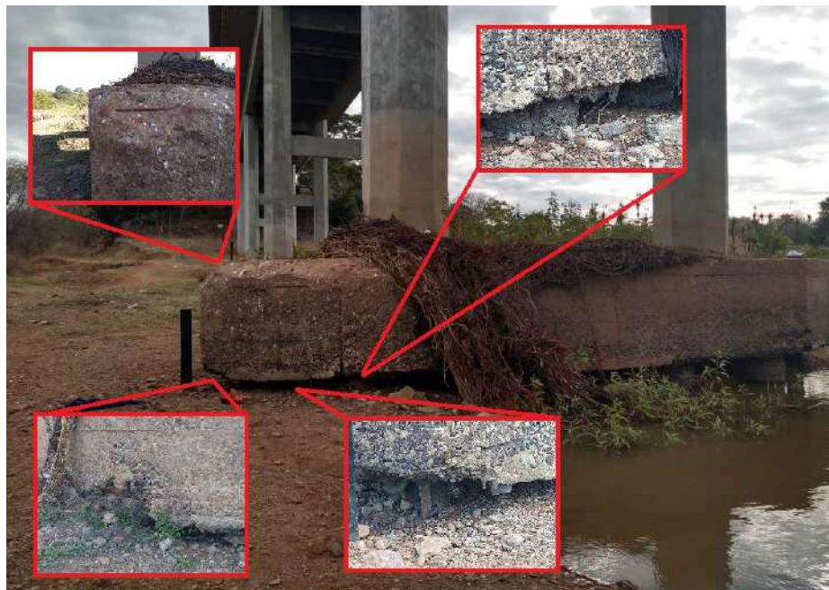
Figura 7. Mapeamento de manifestações patológicas na infraestrutura da ponte.
