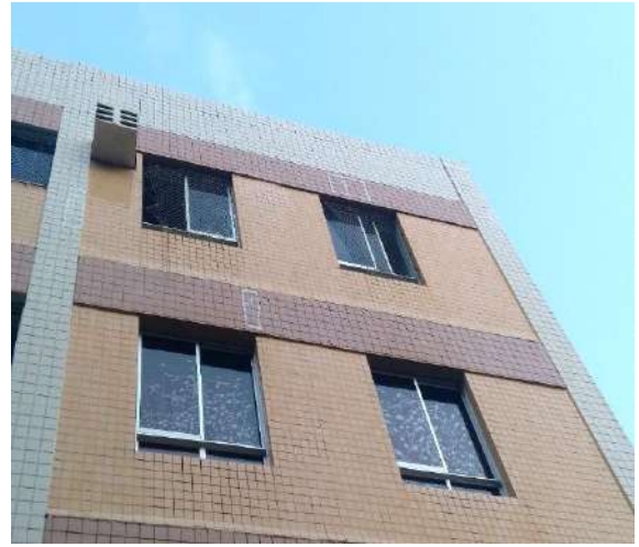
Figura 5: Marcação de som cavo na fachada noroeste do Bloco A.
