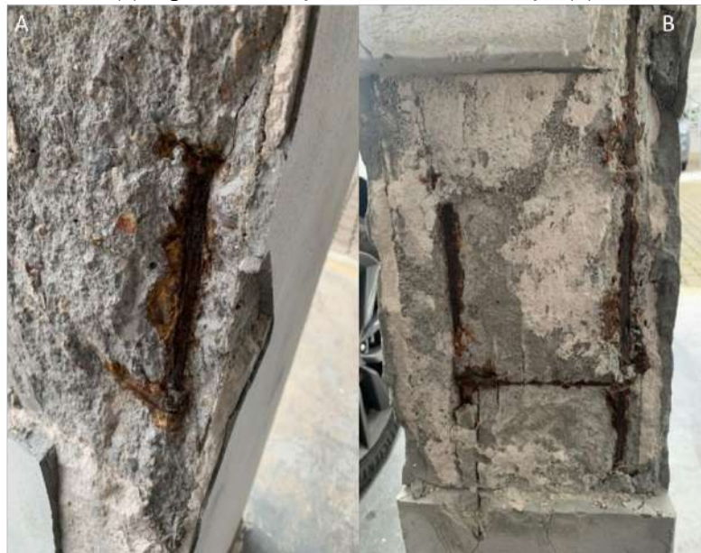
Figura 5. Corrosão de armadura em estado avançado, apresentando deslocamento do concreto (a) e perda de seção transversal do aço (b) .
