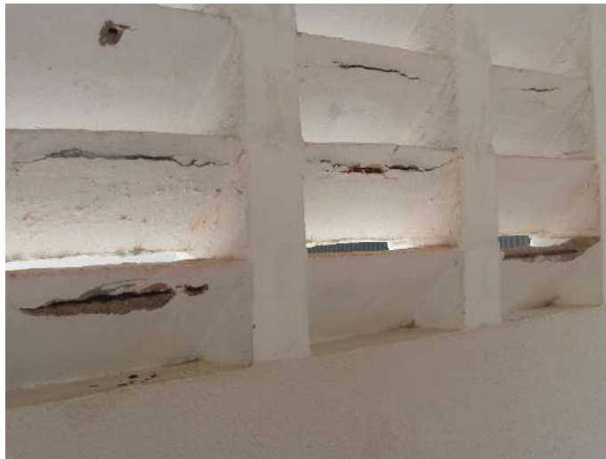
Figura 5. Corrosão nos vergalhões dos combogós feito de concreto. Fonte: própria, 2020.
