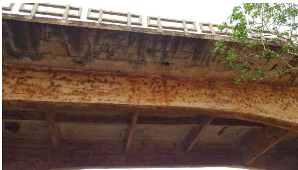
Figura 4. Bolor, eflorescência e manchas de ferrugem presentes no viaduto
