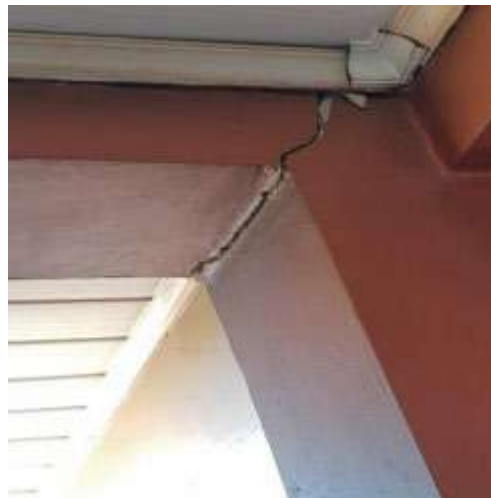
Figura 8. Trincas verticais em viga cinta
