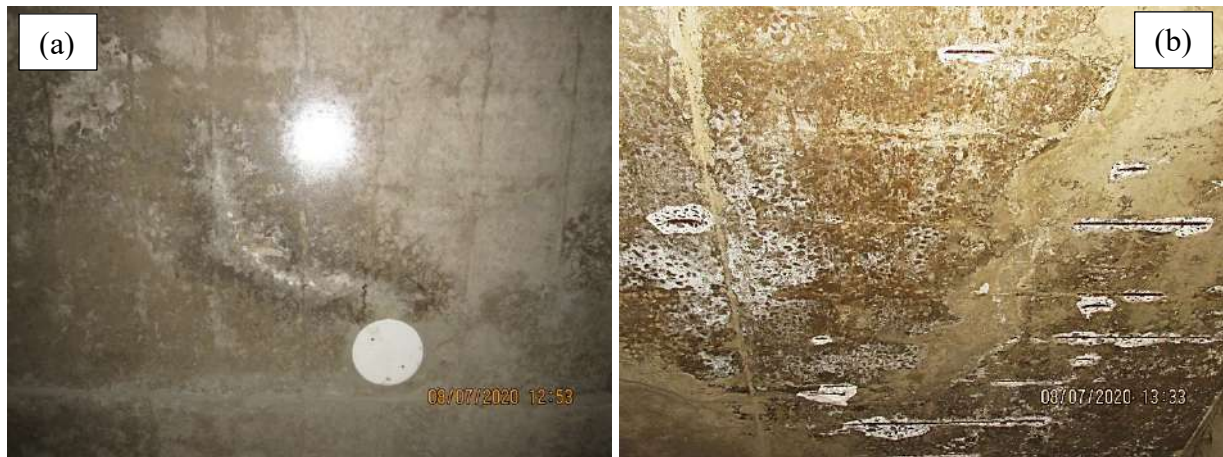
Figura 1. Registros fotográficos das anomalias formadas por lixiviação na estrutura da laje do 1º nível da garagem: a) eflorescências na laje L12; b) estalactites na laje L10.
