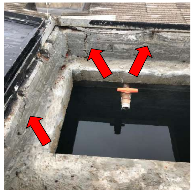
Figura 12. Sinais de desgaste da base da tampa.
