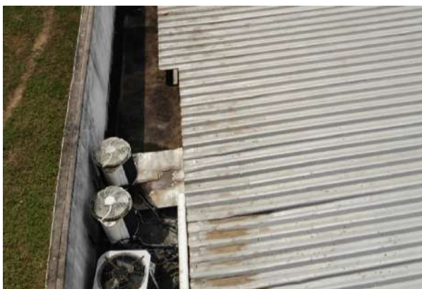
Figura 12 – Irregularidades nas telhas e zonas de instalação de ar-condicionado. Fonte: O autor (2019).
