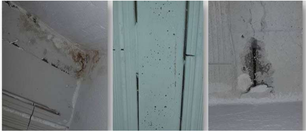
Figura 13. Fissuras, umidade nas extremidades e rachaduras com armadura exposta nas lajes do estádio. Autor: (2020).
