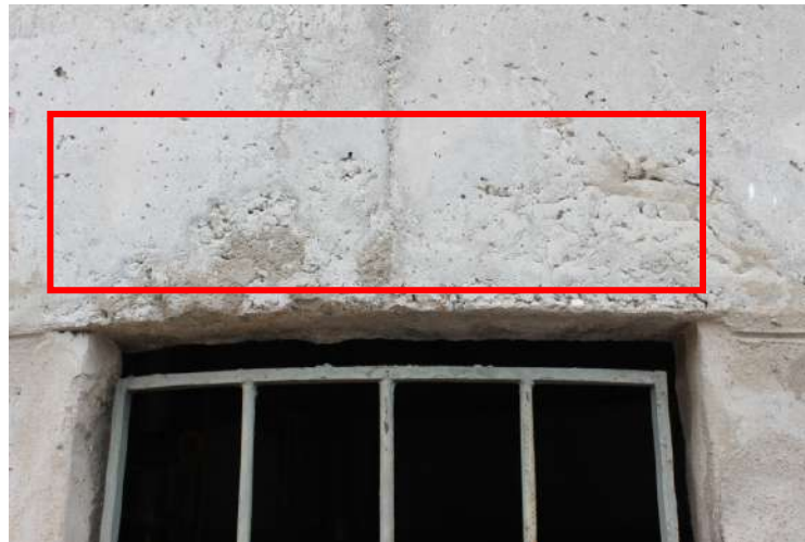
Figura 08. Falhas na concretagem na estrutura do Reservatório 1. Fonte: Autor (2017).
