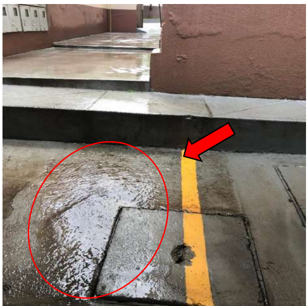
Figura 20. Infiltração da água da chuva.
