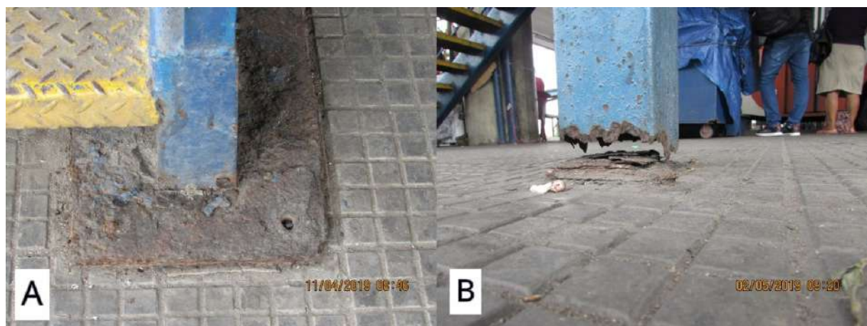
Figura 9 - A: Corrosão em placa e por esfoliação no pilar metálico da escada do T5; B: Perda de material no pilar da escada.
