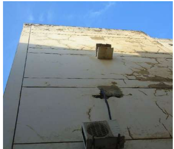
Figura 19: Fissuras na fachada sudoeste do Bloco B.
