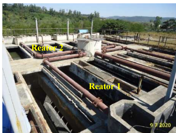
Figura 4 - Vista Geral dos Reatores 1 e 2.
