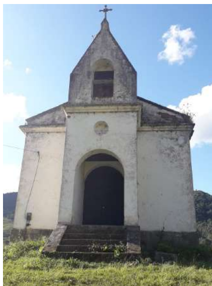
Figura 1. Manifestações patológicas verificadas na fachada frontal. Fonte: (Lessa, 2021).
