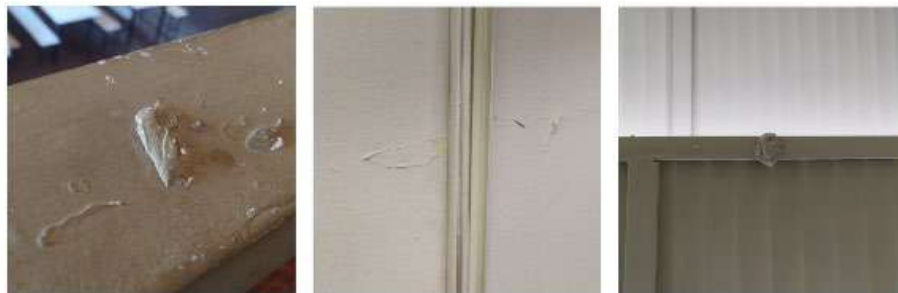
Figura 13. Materiais não removidos na base da pintura
