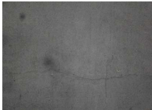
Figura 3.8. Fissuras no sentido transversal nas paredes e pilares do palco.
