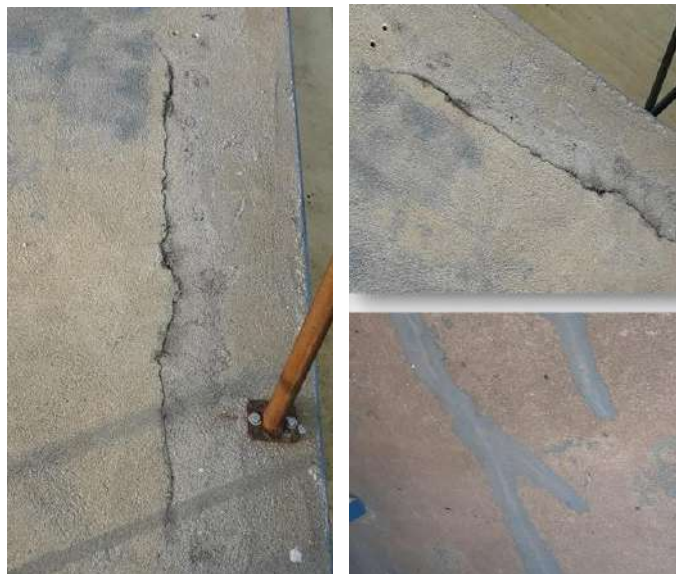
Figura 11. Fissuras nas lajes do estádio. Fonte: Autor (2020).
