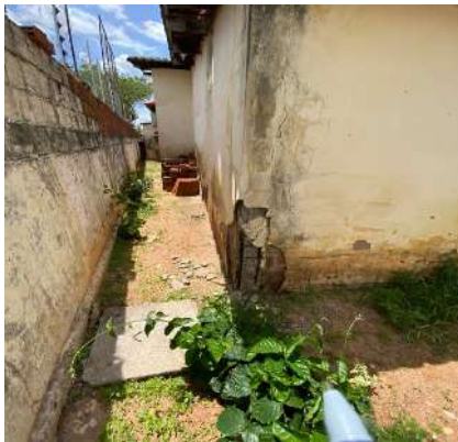
Figura 10: Reboco e armação exposta
