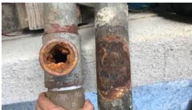
Figura 2. Corrosão em tubulação de água quente. Fonte: Confea, 2021.
