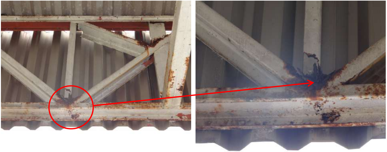
Figura 5 – Vista da corrosão na estrutura metálica da fachada e detalhe da corrosão na estrutura metálica da fachada.
