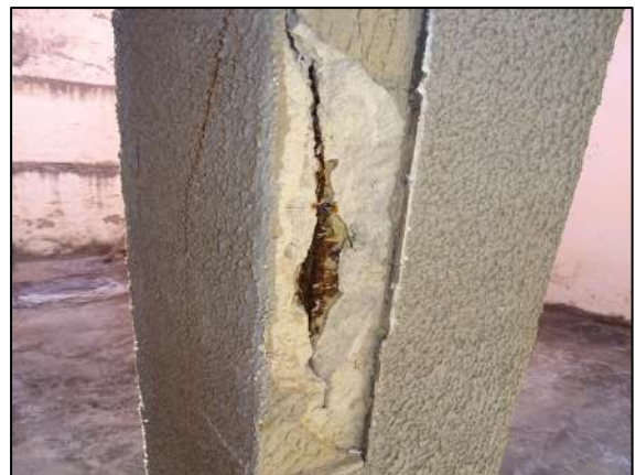
Figura 8 – Deslocamento com corrosão, P1
