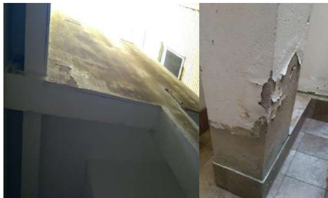
Figura 9. (a) Formação de fungos; (b) Pintura do pilar danificada.
