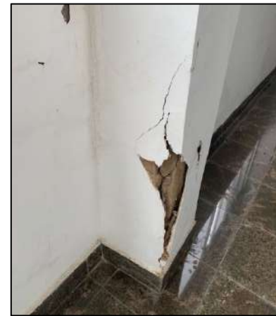
Figura 3 - Trinca e deslocamento do revestimento no pilar do térreo. Fonte: (Autoria própria, 2020)
