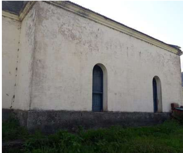
Figura 2. Manifestações patológicas verificadas na fachada leste. Fonte: (Lessa, 2021).
