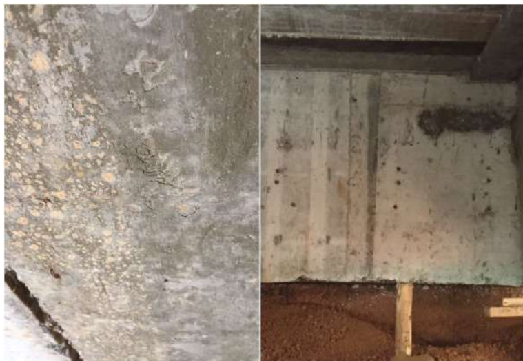
Figura 4. Manchas em elementos estruturais. Fonte: Costa (2016, p.30 e 46)
