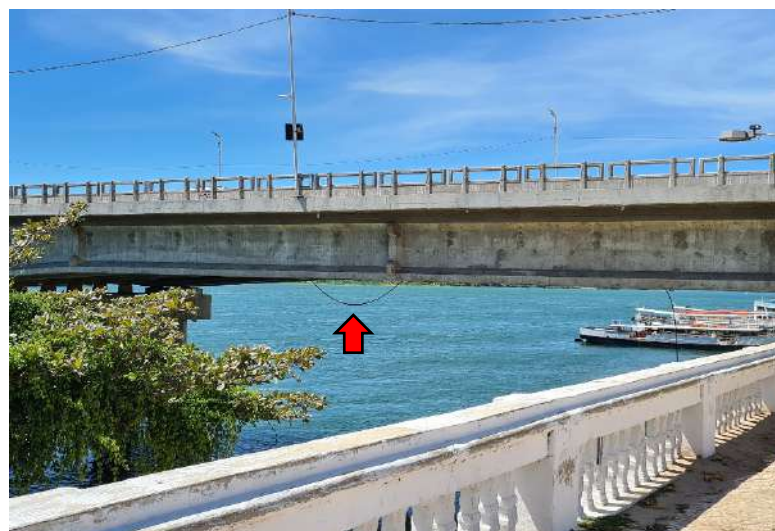
Figura 12. Vista da ruptura do cabo de protensão.
