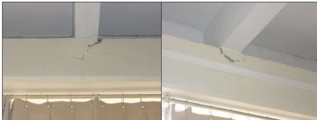
Figura 7: Fissuras sobre as vigas (autoria própria)
