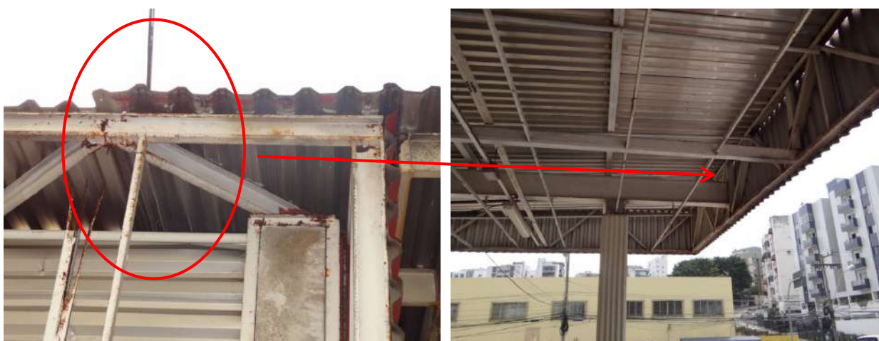
Figura 4 – Detalhe da corrosão na estrutura metálica da fachada e vista interna da corrosão na estrutura metálica da fachada
