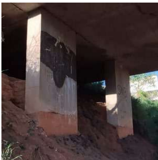
Figura 5. Pilares Calcinação do concreto.
