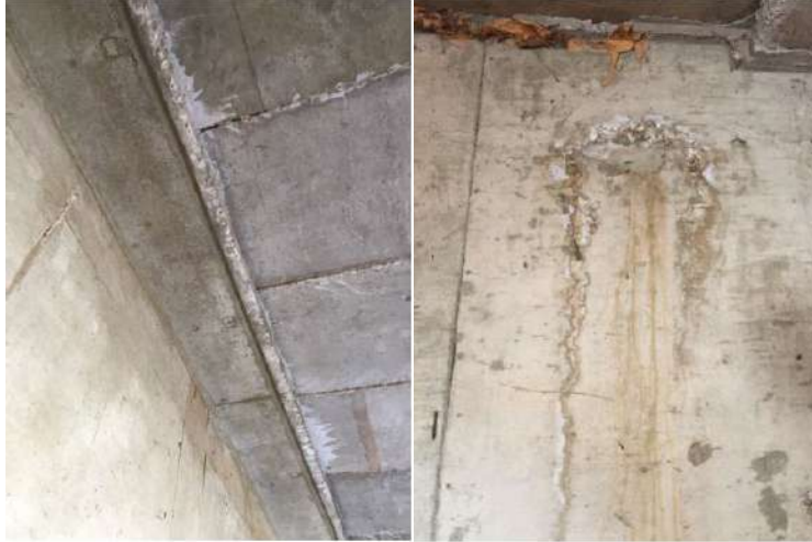
Figura 5. Eflorescência em elementos estruturais.
