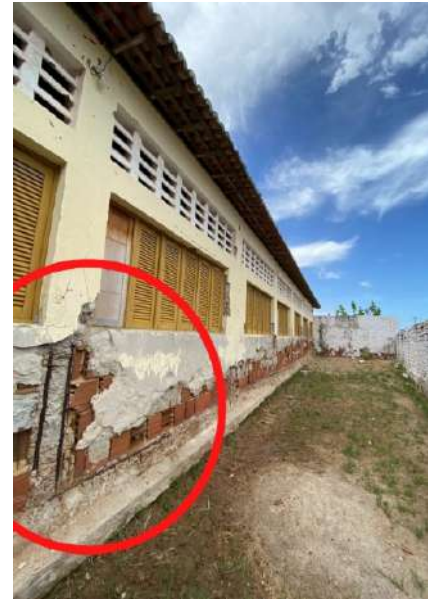
Figura 7: Exposição da alvenaria e do com alto nível de oxidação dos pilares.
