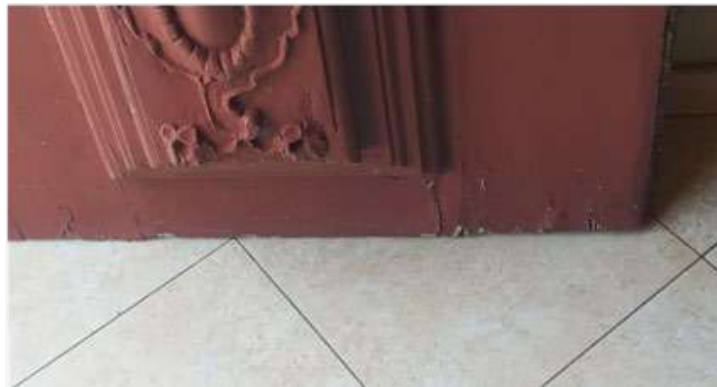
Figura 6- Porta da entrada principal. Patologia: Presença de umidade na parte inferior da porta. Fonte – Os autores, 2021
