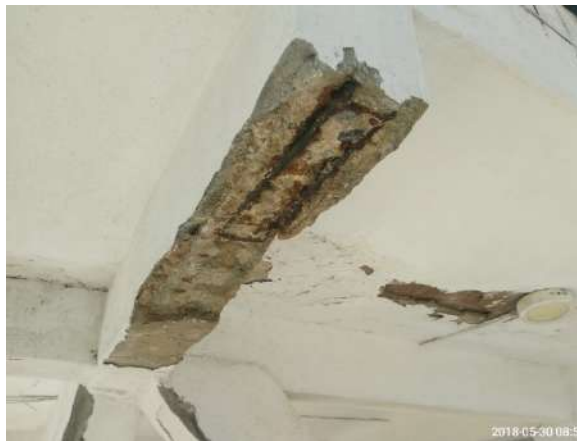
Figura 5. Armaduras em uma das vigas de concreto armado altamente comprometidas pela corrosão. Fonte: própria, 2018.
