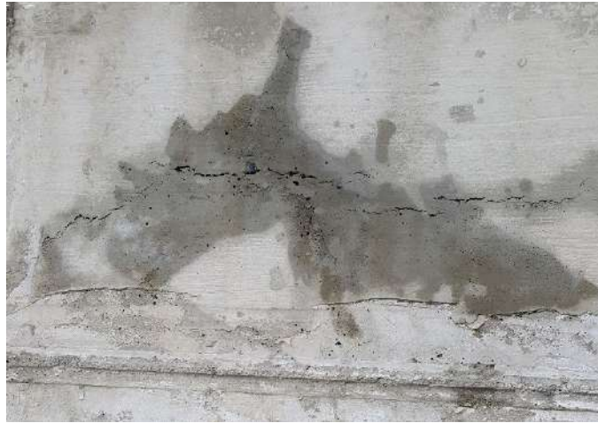
Figura 8. Concreto apresentando retração.
