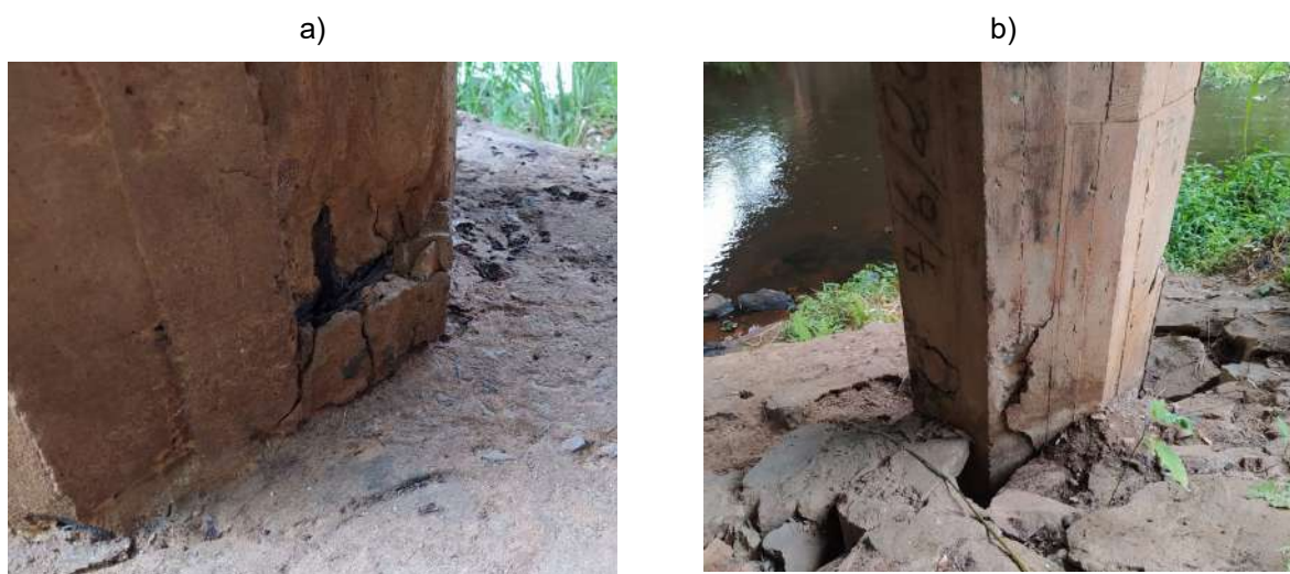
Figura 3- Deslocamento do concreto de cobertura da armadura a) e b) detalhes do deslocamento na base do pilar.
