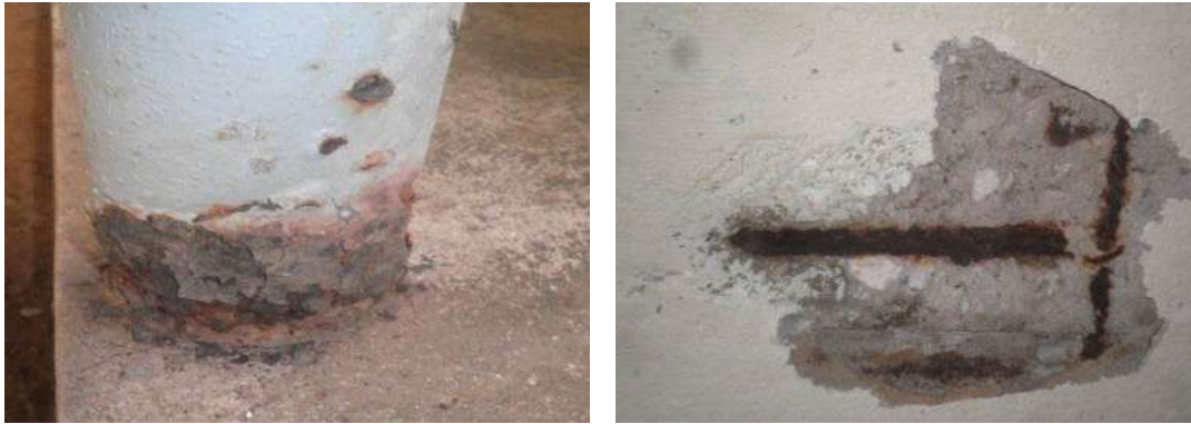
Figura 3.17. Base do guarda-corpo e superfície inferior da marquise corroida respectivamente.
