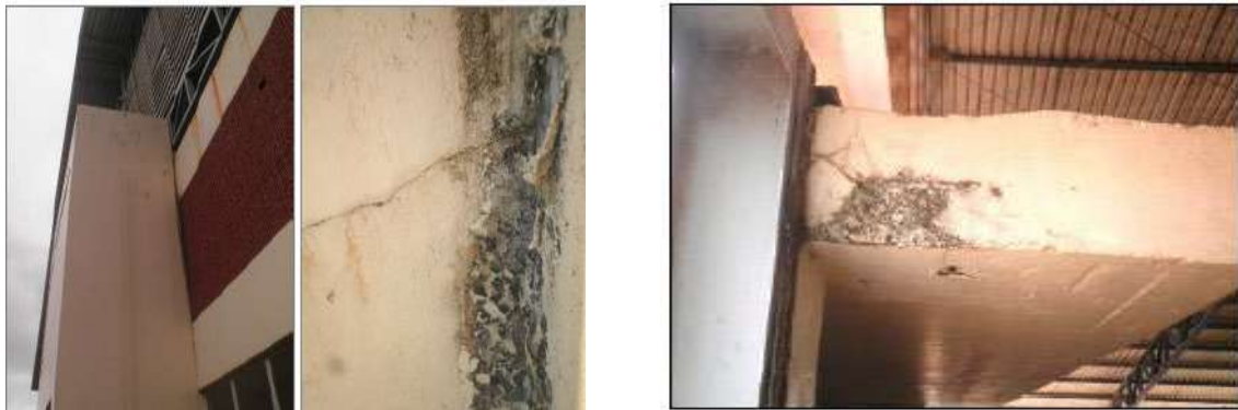
Figura 3.3. Presença de bolor e limo na fachada e Marquise.
