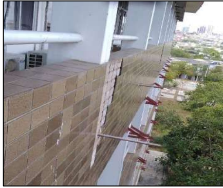
Figura 5 - Desplacamento e queda no revestimento da fachada. Fonte: (Autoria própria, 2020)
