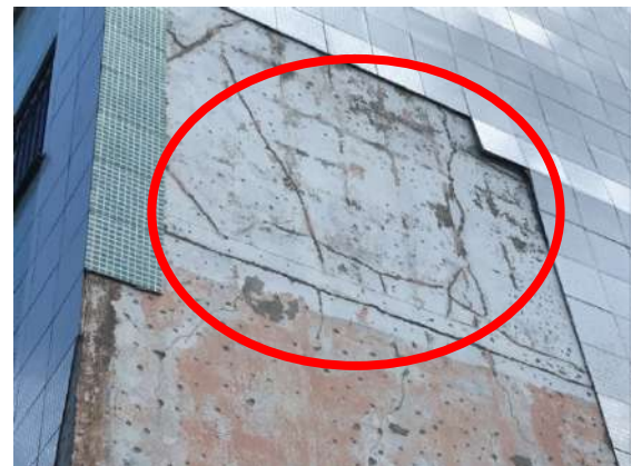
Figura 4 - Área de Fissurações
