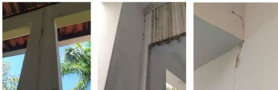
Figura 3. Juntas de dilatação com fissuras
