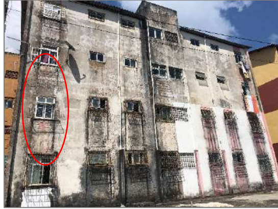
Figura 7 - Descoloração na fachada posterior, Edifício A
