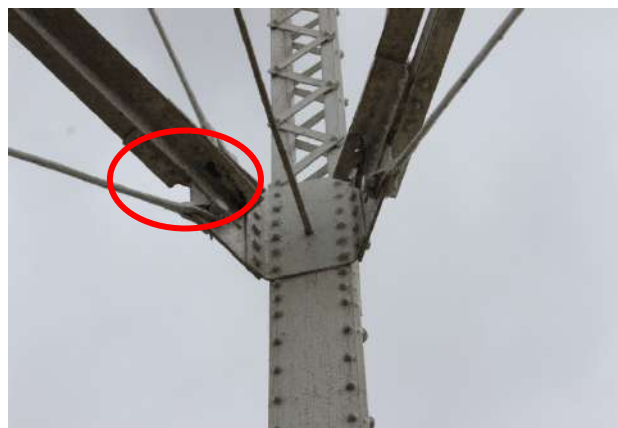
Figura 13. Corrosão na estrutura do Reservatório 2. Fonte: Autor (2017).
