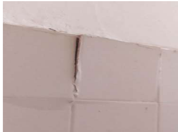
Figura 19- Parede do lado direito, segundo vista frontal. Lado direito da parede. Patologia: Desprendimento e empolamento de revestimento de peça cerâmica Fonte: Os autores, 2021.
