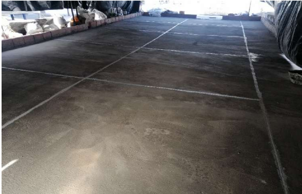
Figura 7: recubrimiento pesado sobre la impermeabilización con mortero 1:3 mejorado con aditivo látex y juntas de dilatación con sello elastómero para controlar cambios volumétricos por temperatura.
