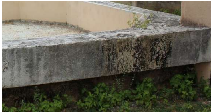
Figura 04. Mofo em um reservatório de concreto armado. Fonte: Autor (2017).
