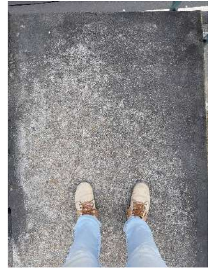
Figura 26: Manchas de umidade (Fi = 2).
