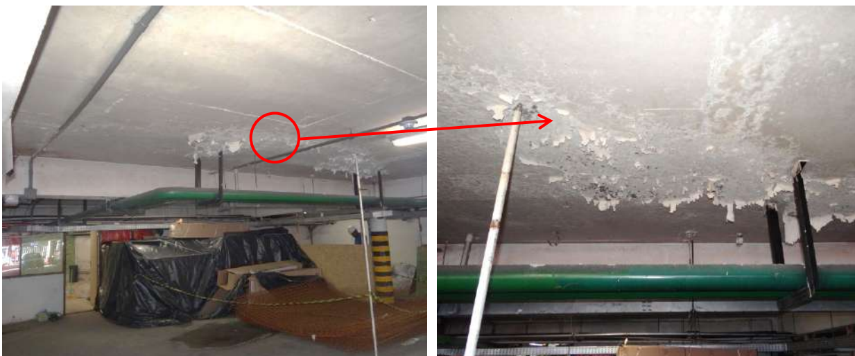
Figura 10 - Detalhe da desfragmentação da pintura da laje (frontal)
