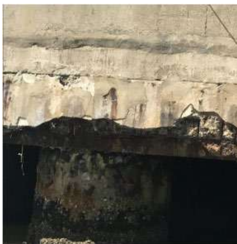
Figura 8. Deterioração da proteção do bloco de concreto. Fonte: Santos e Silva (2017, p.51)
