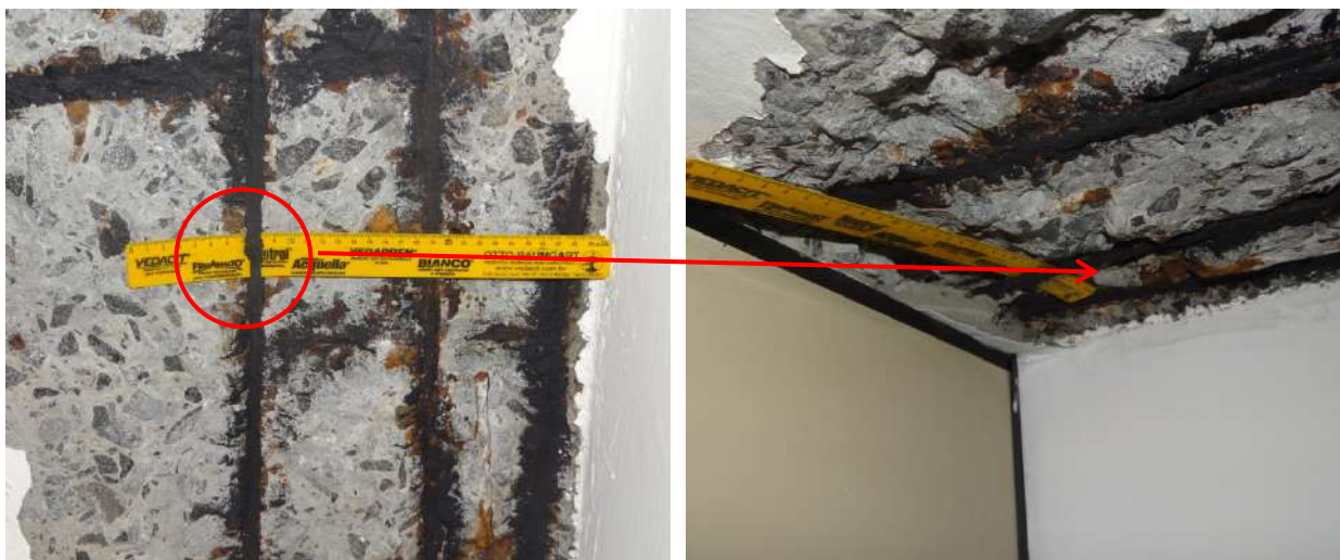
Figura 13 - Detalhe do processo de corrosão e deslocamento da laje e detalhe do processo de corrosão e deslocamento da laje.
