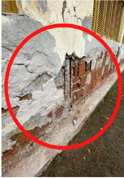
Figura 6: Exposição da alvenaria e do com alto nível de oxidação dos pilares.
