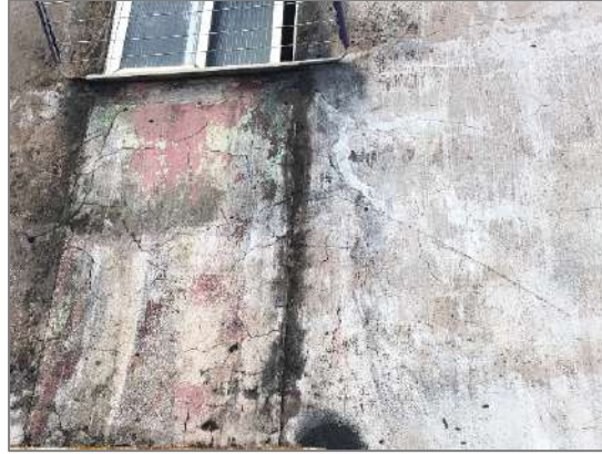
Figura 11 - Manchas na fachada posterior, Edifício A
