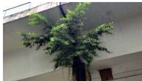
Figura 6 – Crescimento de vegetação no Pilar 4
