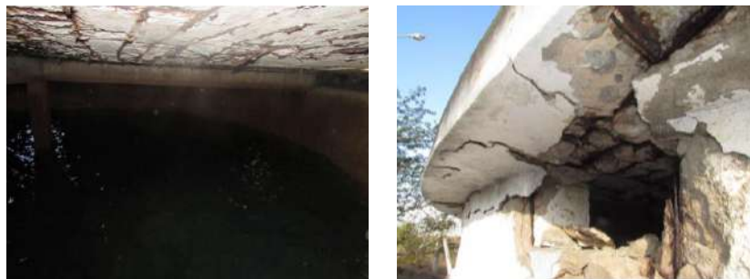
Figura 11. Laje do topo da caixa em estado de ruína Fonte: Autor (2021)
