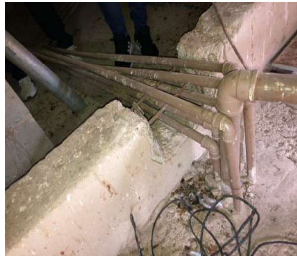
Figura 10. Danos na viga.
