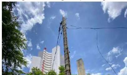
Figura 12: Degradação do poste
