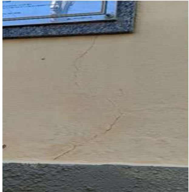
Figura 12- parede lateral da fachada, na região inferior a parede. Patologia: fissura Fonte: Os autores, 2021.
